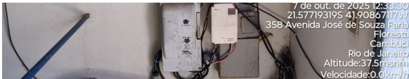
Foto 05: Painele de comando da EEAB.
