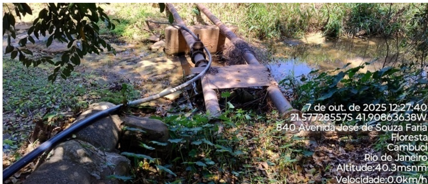
Foto 03: Tubulação de ferro fundido de 200 mm da captação.
