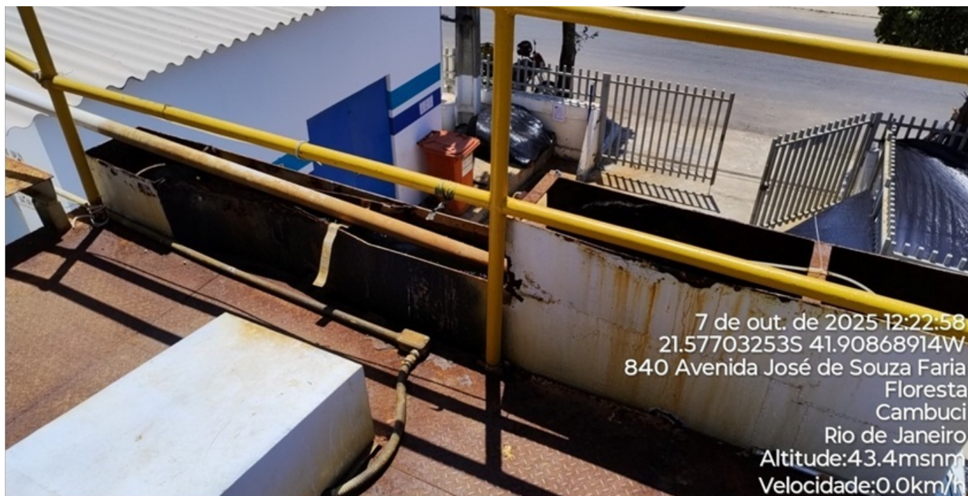
Foto 07: Calha Parshall e aplicação do agente coagulante.
