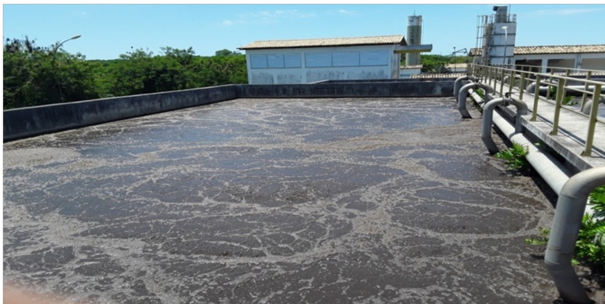
Foto 8 - Tanque de aeração com difusores de bolha fina
