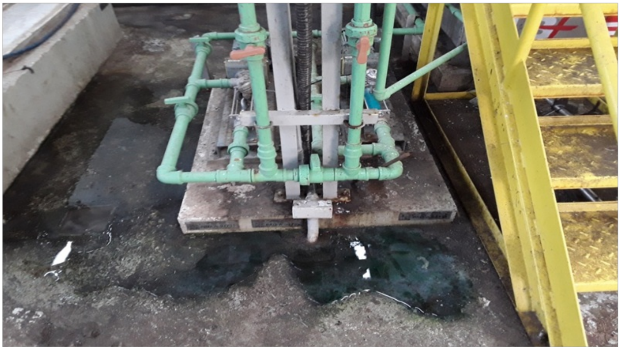
Foto 18 – Sinais de vazamentos.
