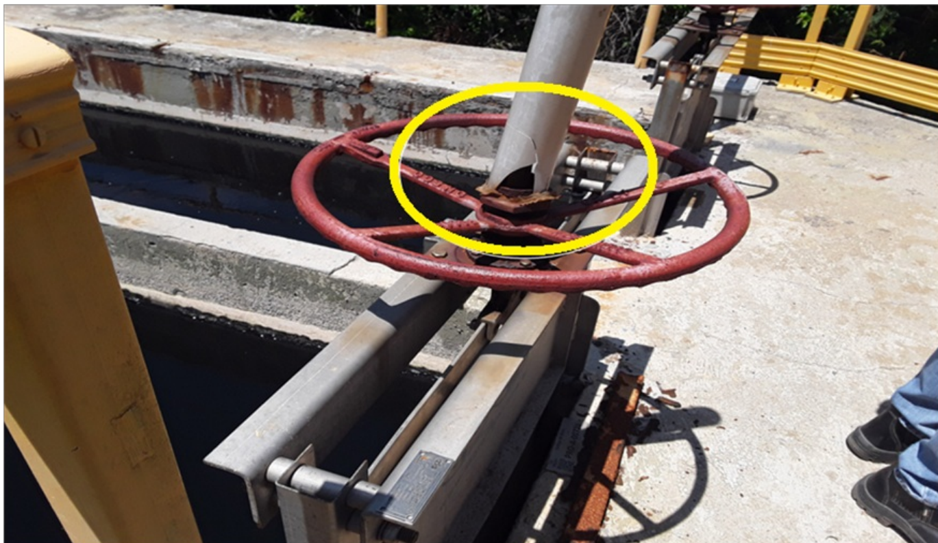
Foto 6 - Sinais de má conservação em uma das válvulas
