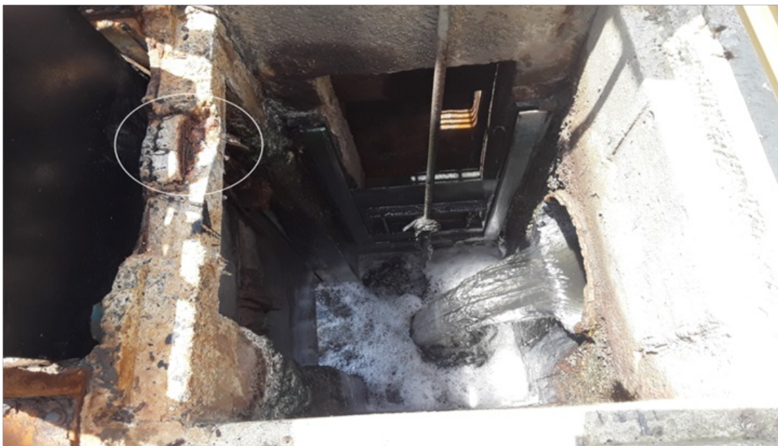
Foto 11 - Ferragens expostas na estrutura de concreto
