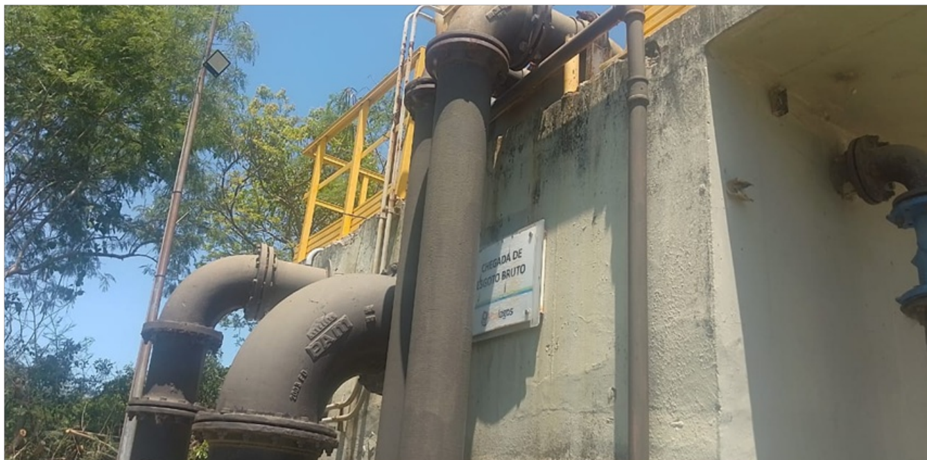
Foto 2 - Entrada do Esgoto Bruto no Tratamento Preliminar.
