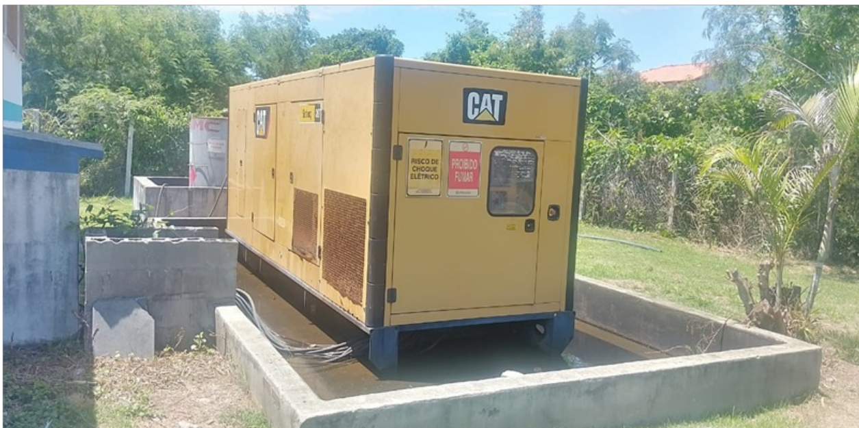
Foto 21 - Gerador de Energia
