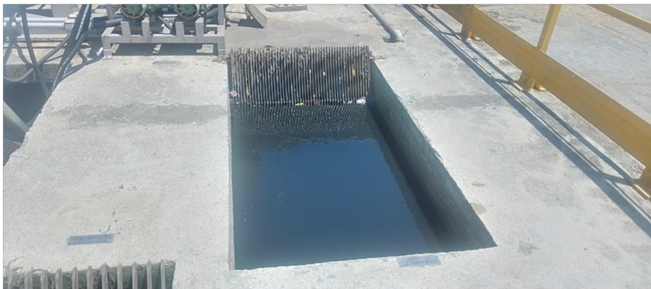
Foto 3 - Gradeamento para retenção de resíduos sólidos grosseiros
