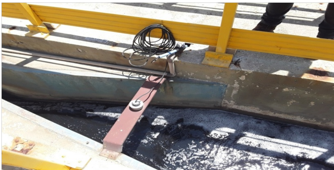
Foto 7 - Calha Parshall com medidor de vazão ultrassônico
