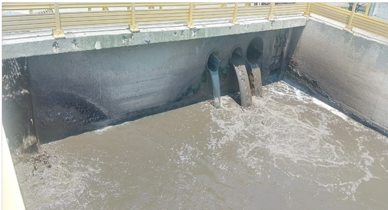
Foto 9 - Entrada do esgoto bruto e do lodo recirculado
