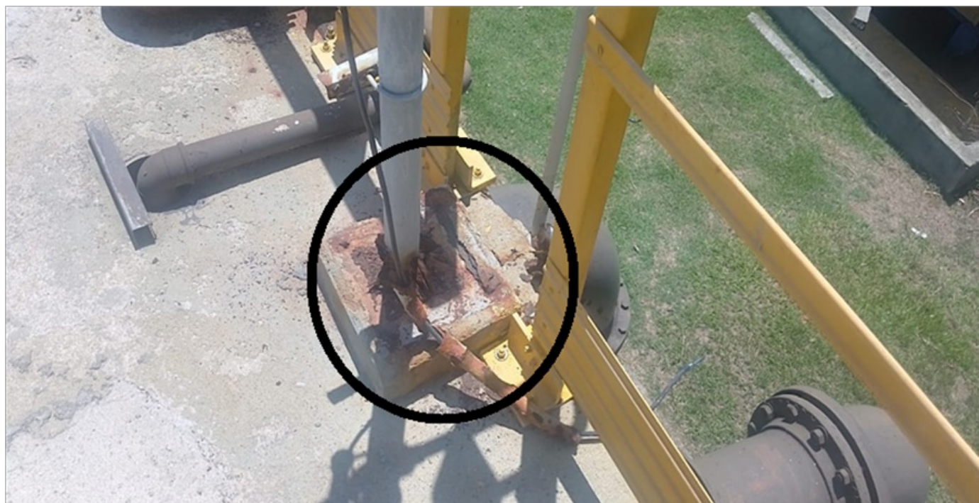
Foto 17 – Fiação exposta e ferrugem.
