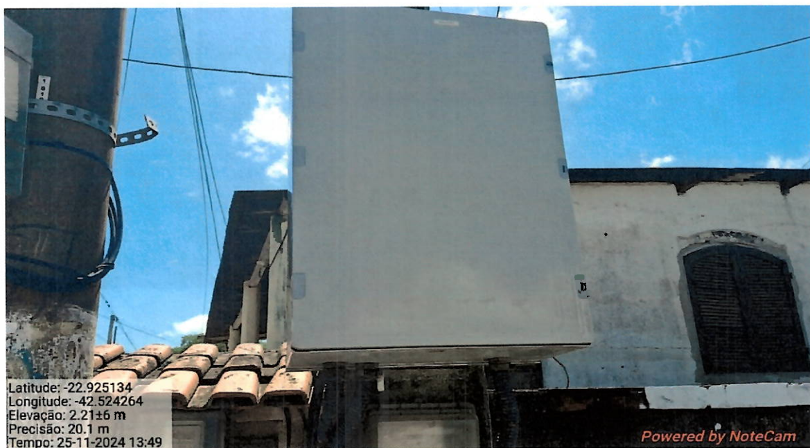
Foto 66 – Paineis quadro de comando
