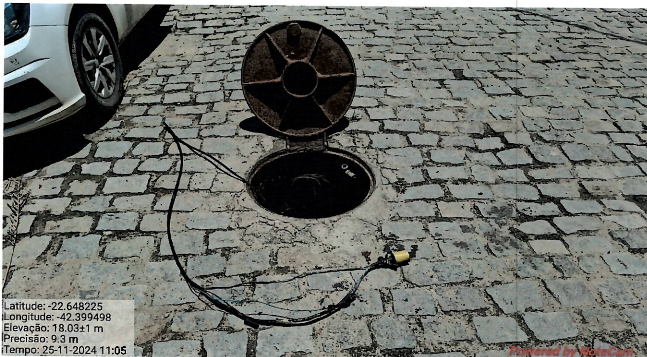
Foto 60 – Sensores de nível
