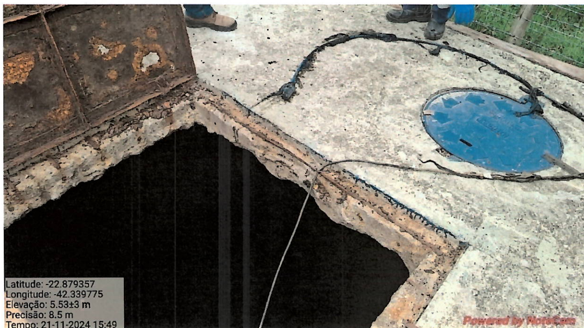
Foto 13 – Sensores de nível
