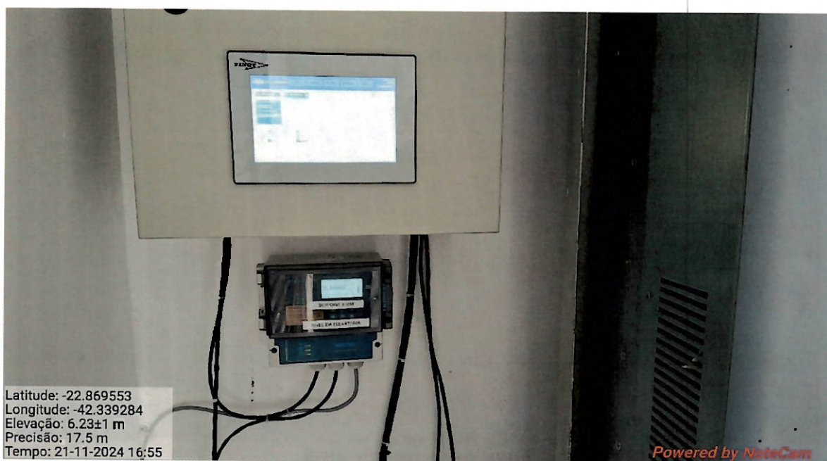
Foto 24 – Painel medidor de vazão
