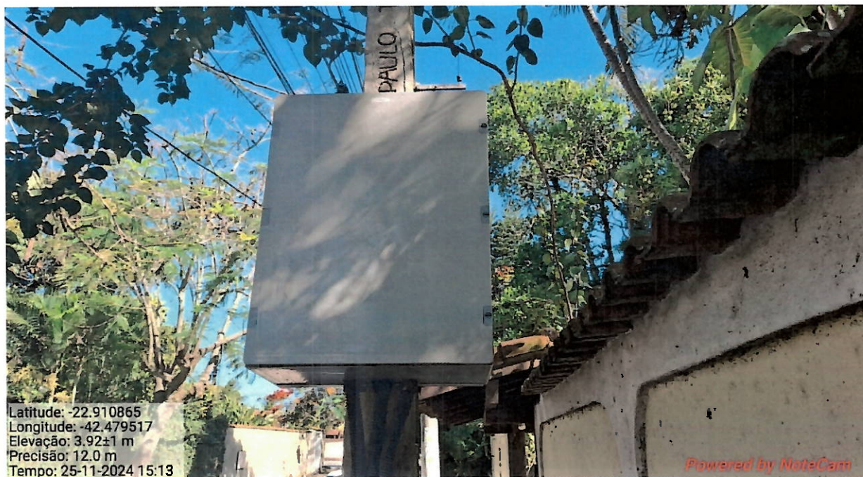
Foto 94 – Painel de comando
