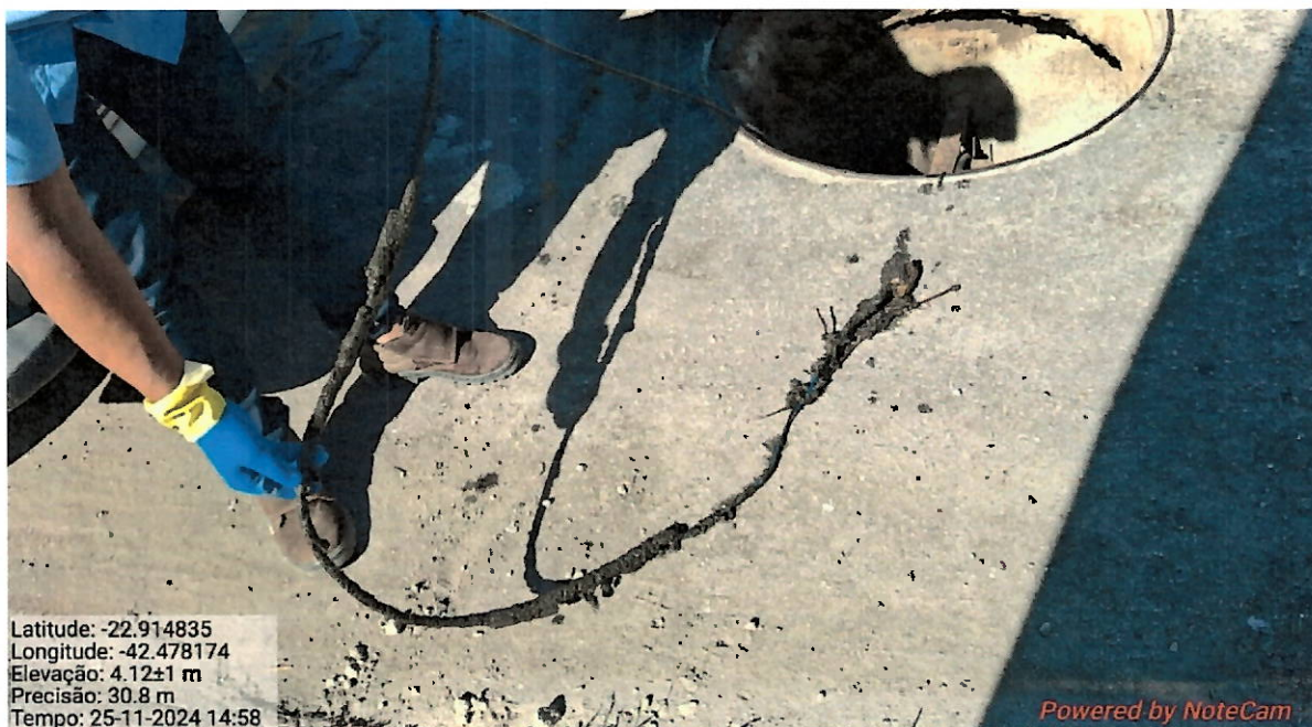
Foto 90 – Sensores de nível
