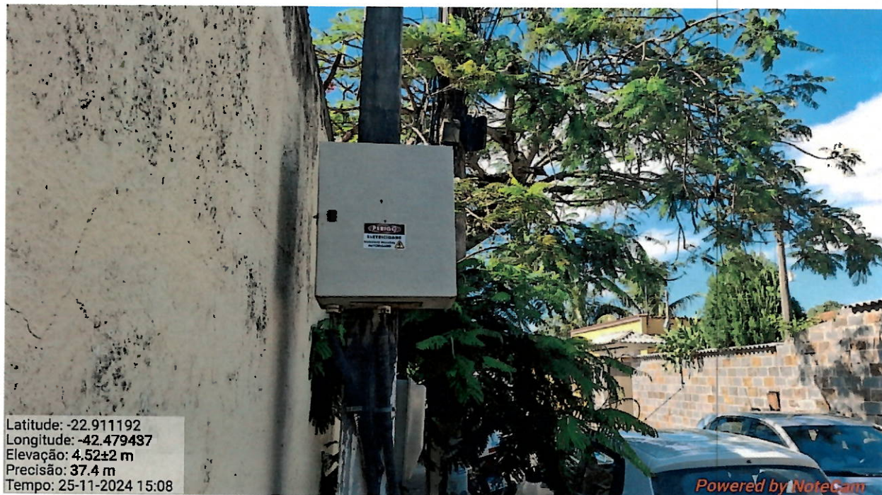
Foto 91 – Painel de comando
