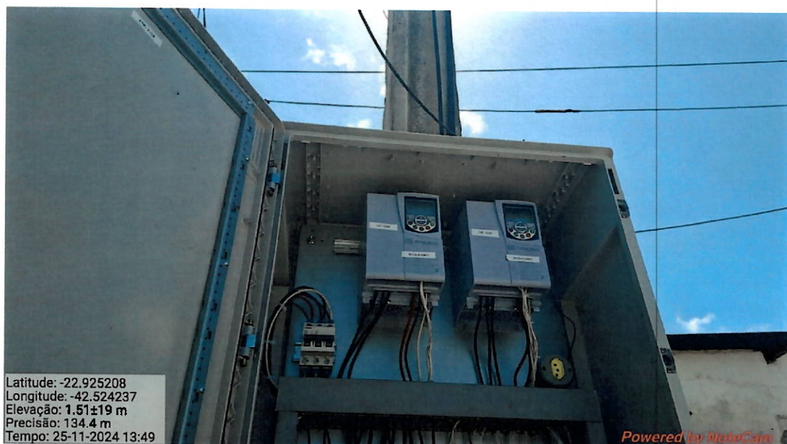
Foto 67 - Inversor de frequência e demais equipamentos automação e telemetria
