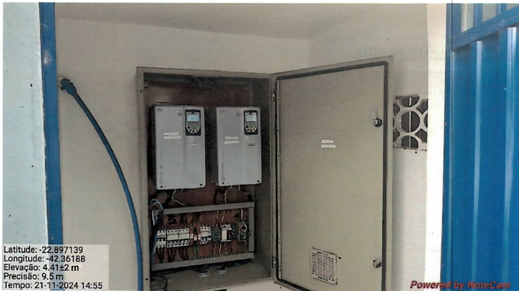
Foto 07 – Inversores de frequência e demais equipamentos automação e telemetria
