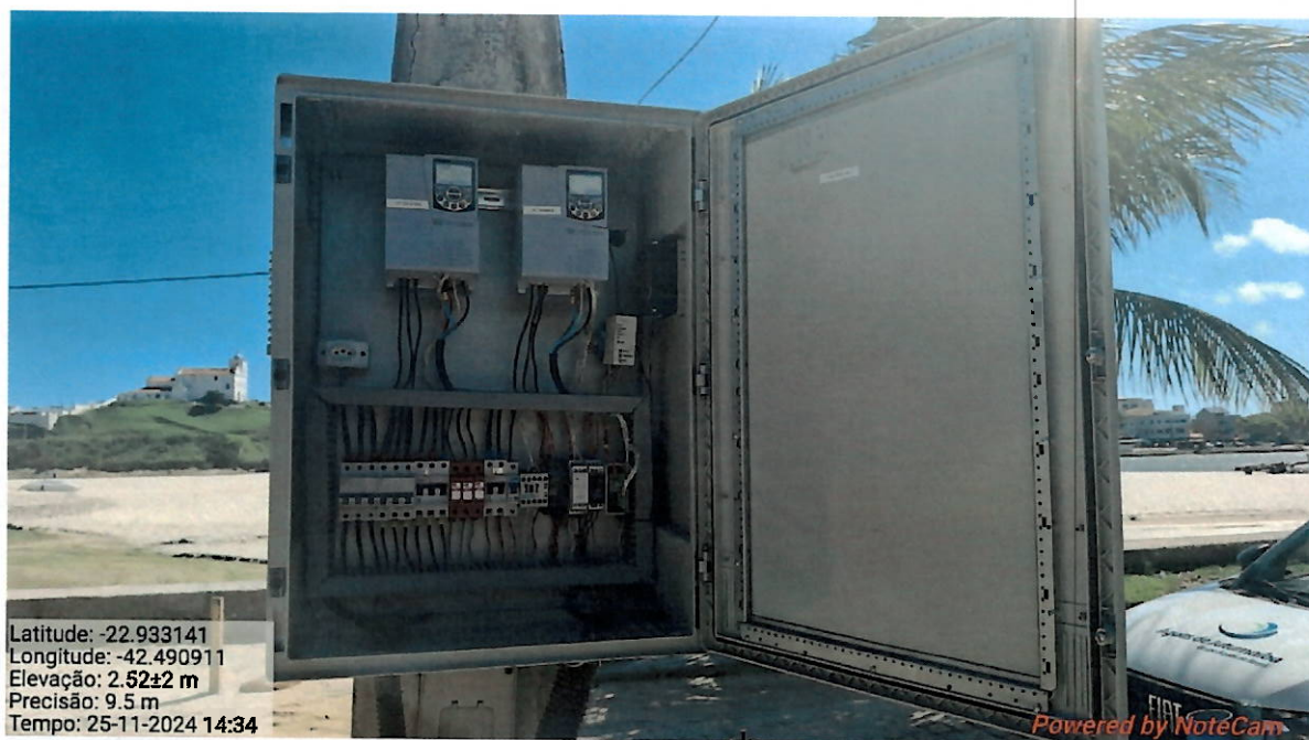
Foto 75 – Inversor de frequência e demais equipamentos automação e telemetria
