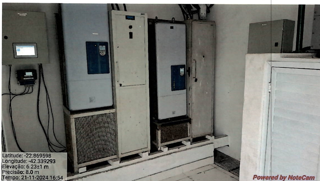
Foto 23 – Inversores de frequência e demais equipamentos automação e telemetria
