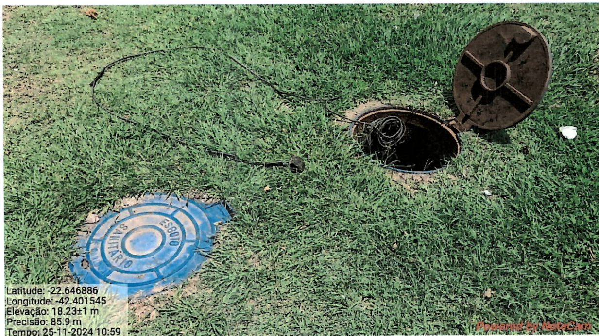
Foto 53 – Sensores de nível
