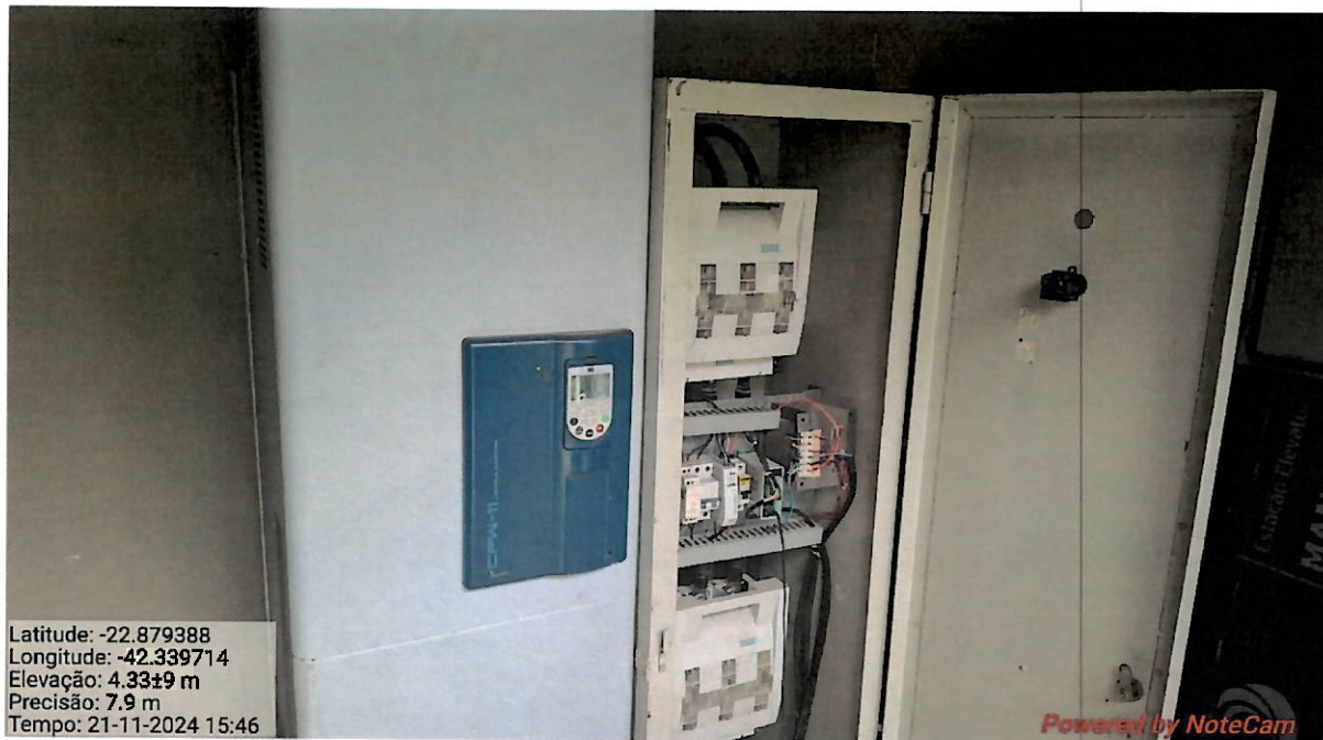
Foto 11 – Inversores de frequência e demais equipamentos automação e telemetria
