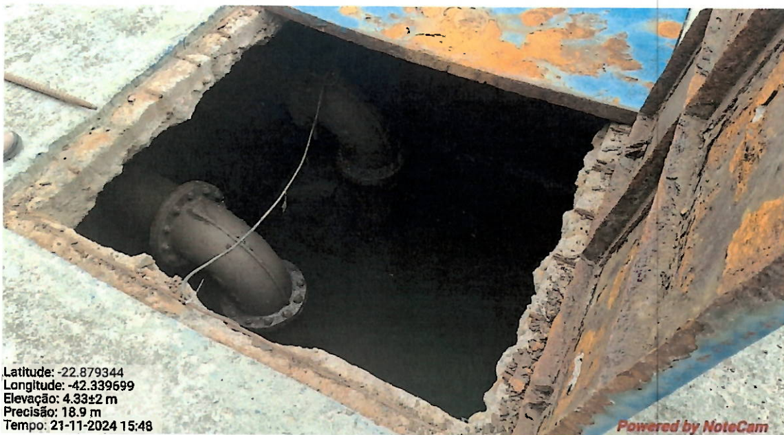
Foto 12 – Poço de sucção
