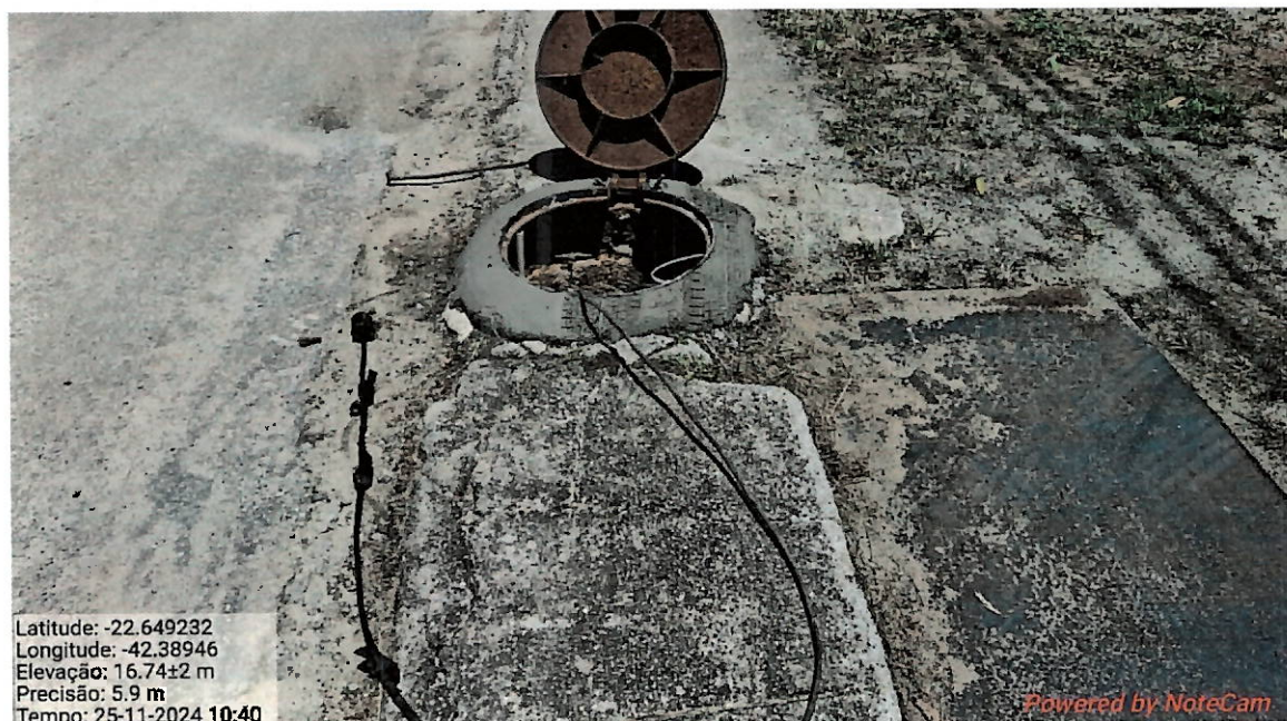
Foto 57 – Sensores de nível
