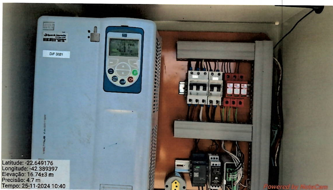
Foto 55 – Inversor de frequência e demais equipamentos automação e telemetria
