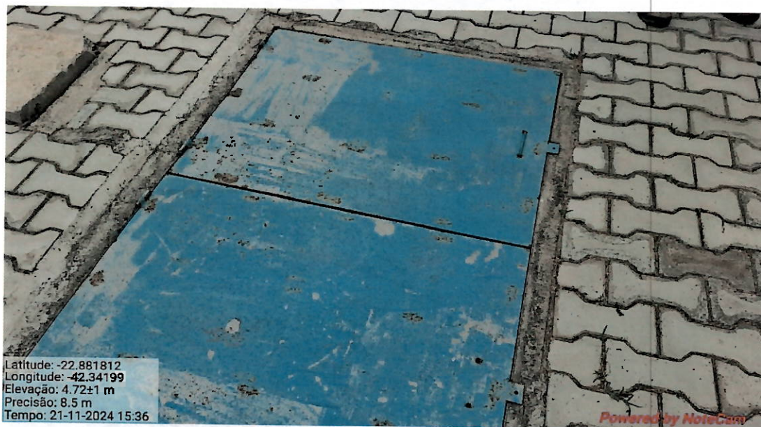
Foto 36 – Poço de sucção e abrigo bomba submersa
