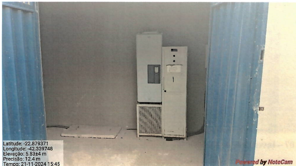
Foto 09 – Abrigo quadros de comando
