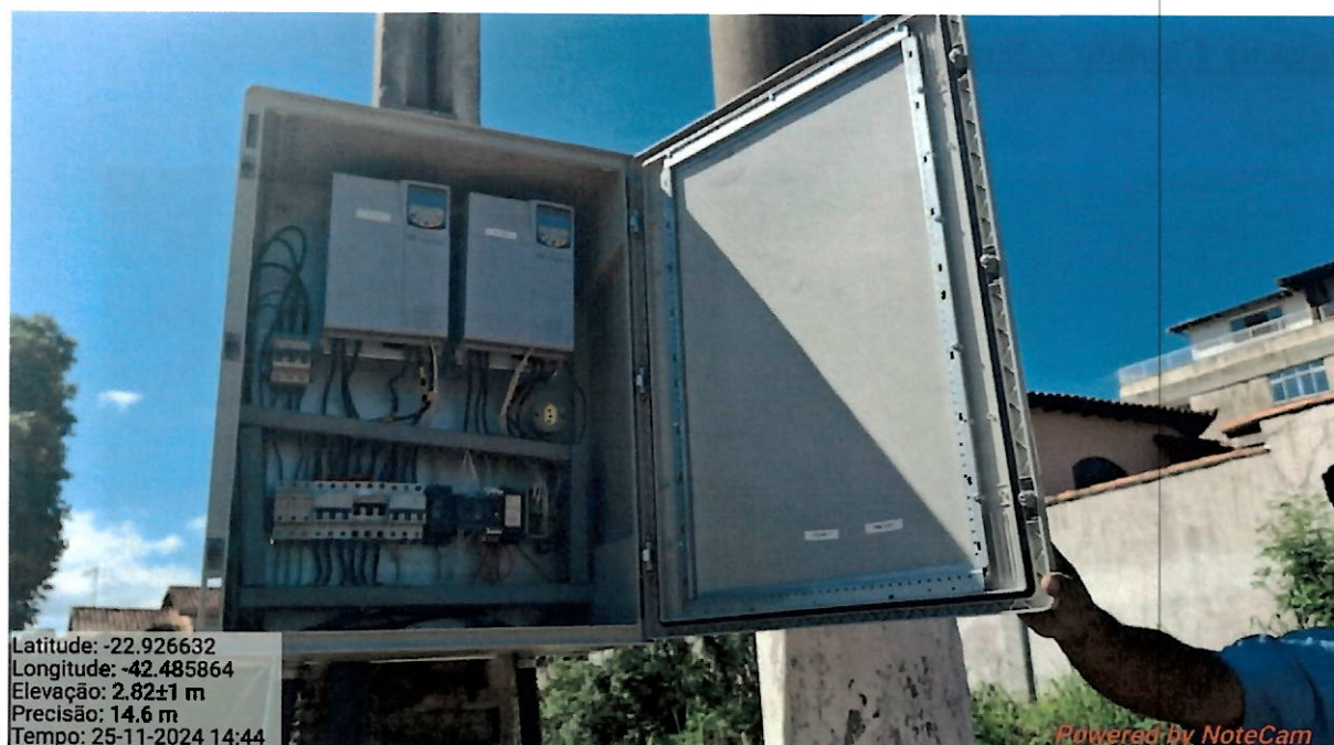
Foto 79 – Inversor de frequência e demais equipamentos automação e telemetria
