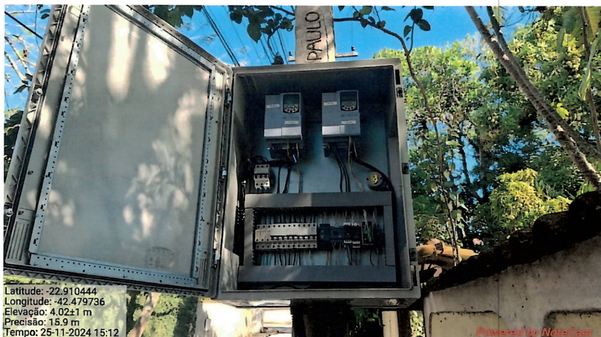
Foto 95 – Inversor de frequência e demais equipamentos automação e telemetria
