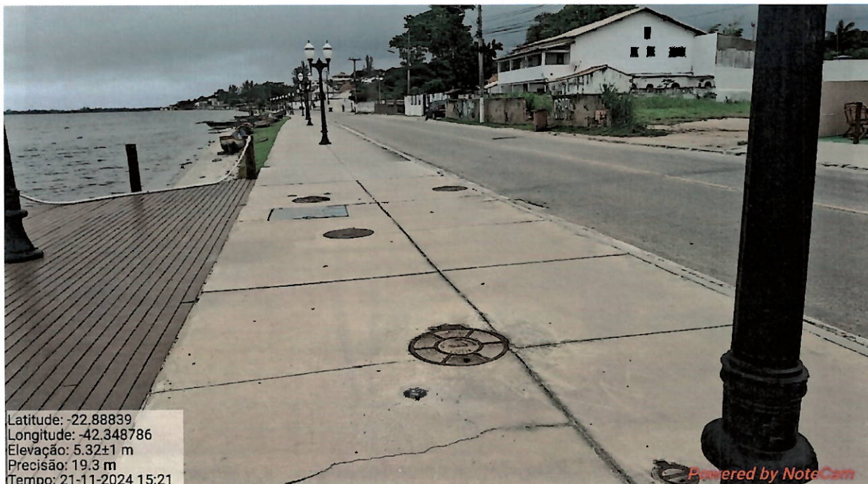
Foto 29 – Poços de visita elevatória
