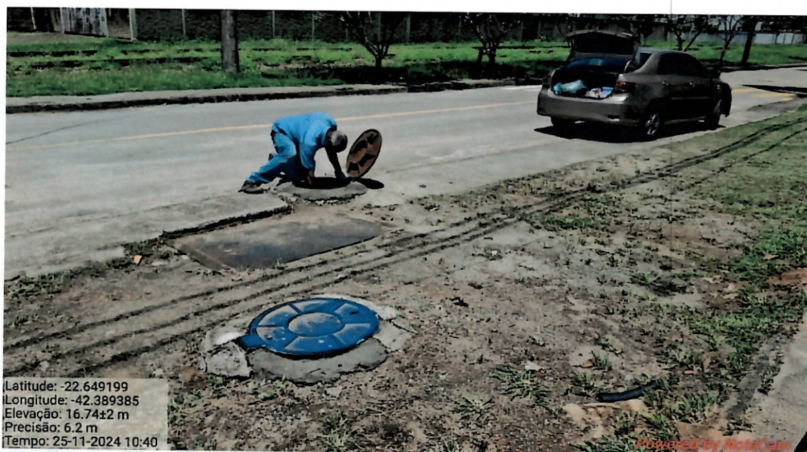
Foto 56 – Poços de visita elevatória
