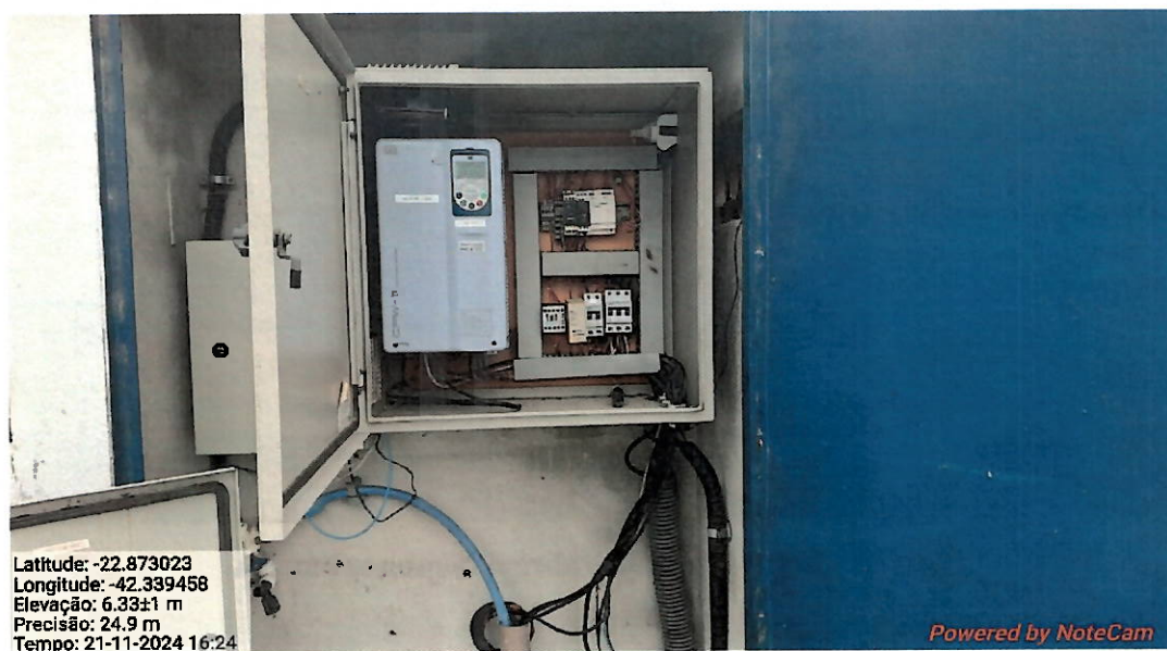
Foto 38 – Inversores de frequência e demais equipamentos automação e telemetria
