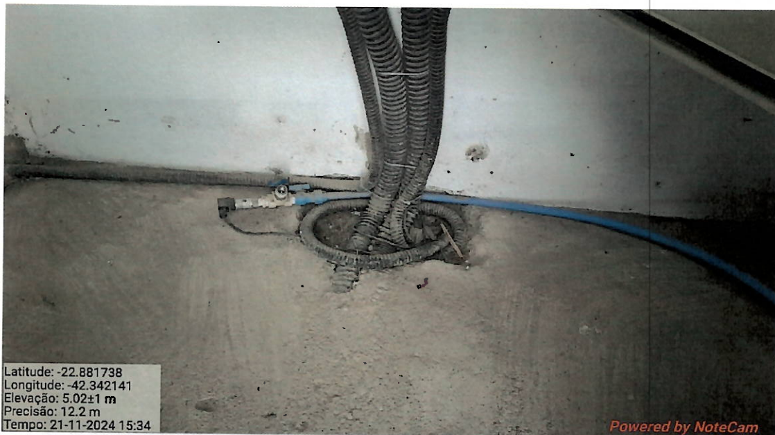
Foto 35 – Medidor de vazão
