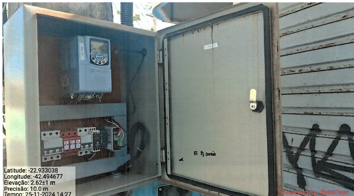
Foto 81 – Inversor de frequência e demais equipamentos automação e telemetria
