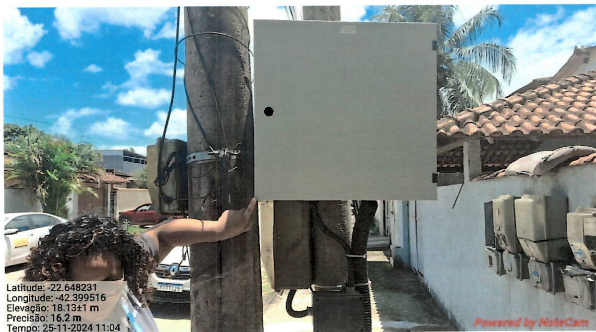
Foto 58 – Painel de comando
