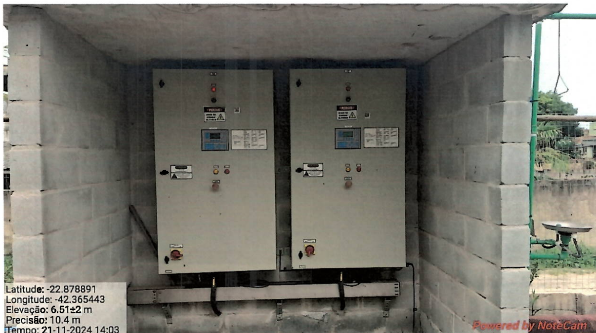
Foto 45 – Paineis de comando
