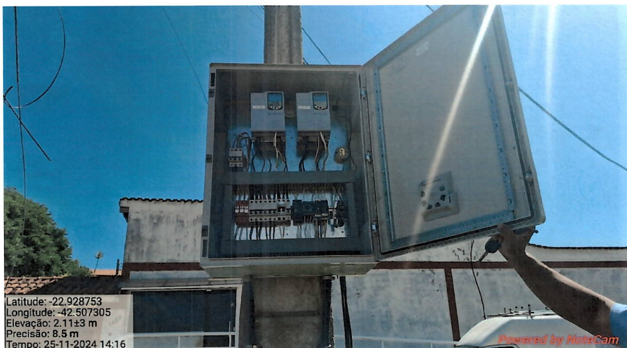
Foto 70 – Inversor de frequência e demais equipamentos automação e telemetria
