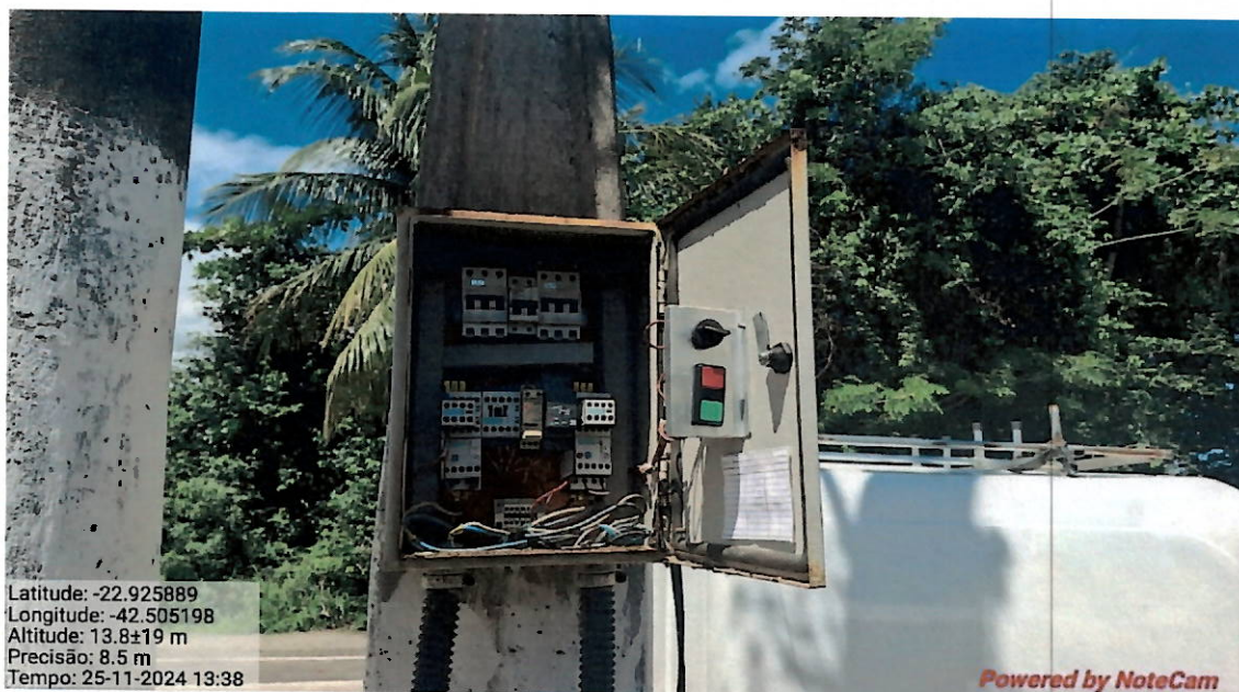
Foto 64 – Quadro de comando
