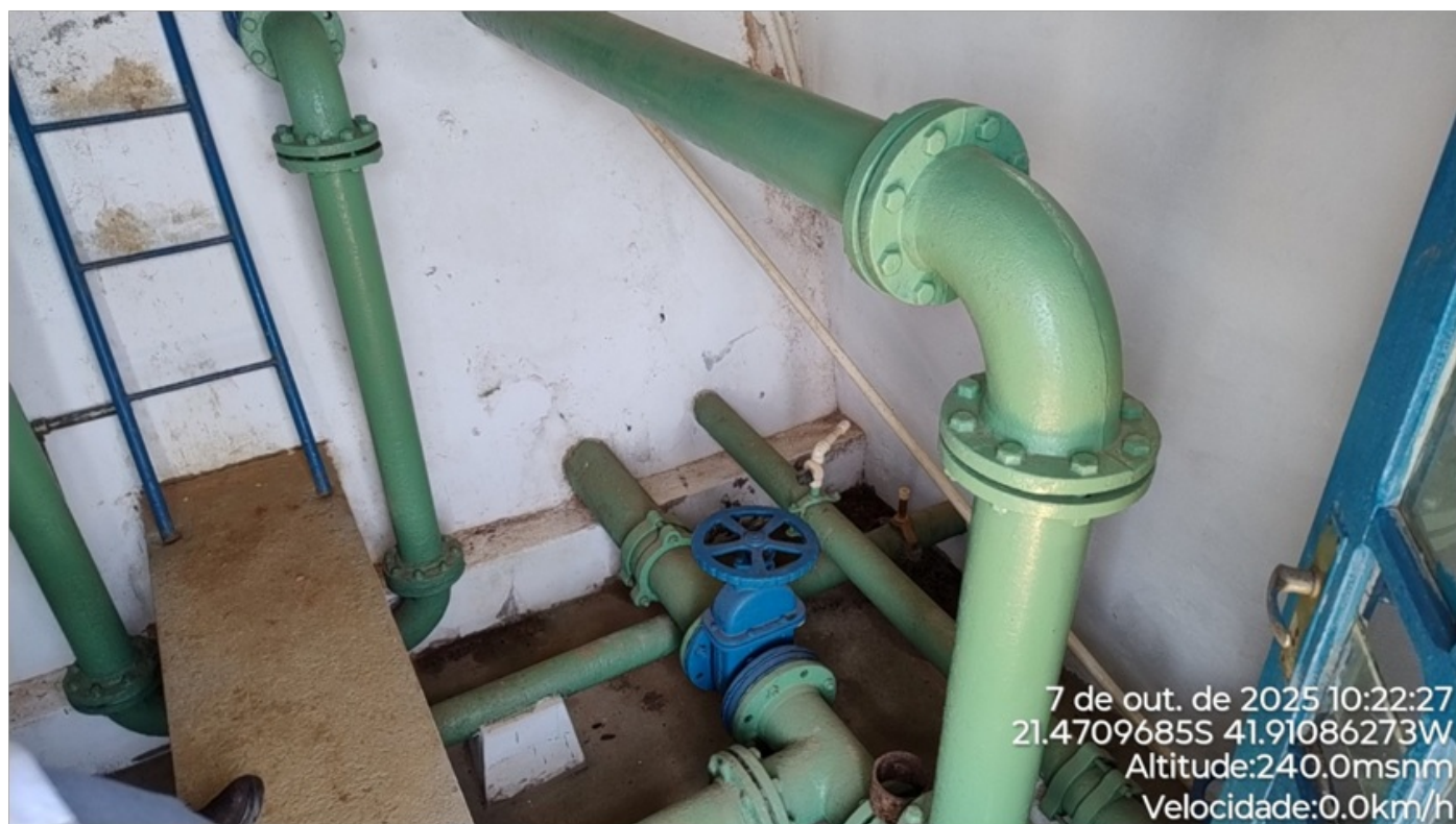
Foto 07: Tubulações de entrada, saída e limpeza.
