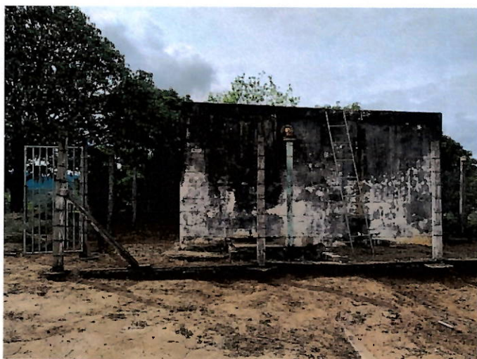
Foto 1: Vista frontal – ausência de cercamento adequado (apenas arame farpado); ausência de identificação da unidade e escada inadequada.
