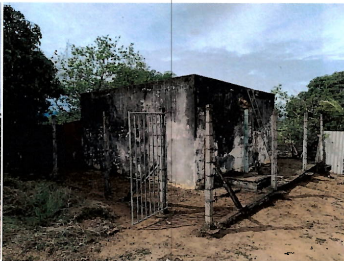
Foto 2: Vista lateral – portão de acesso ao reservatório. Nota-se a ausência de guarda-corpo na parte superior do reservatório e ausência de SPDA.
