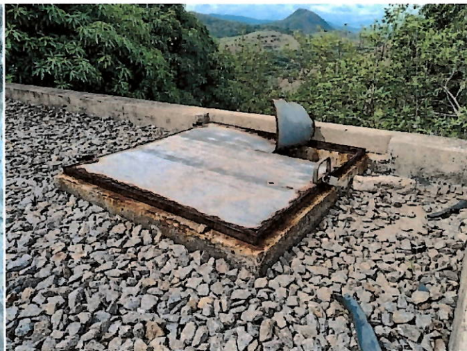
Foto 6: Parte superior do reservatório – tampa de inspeção com sinais de corrosão (não apresenta estanqueidade).
