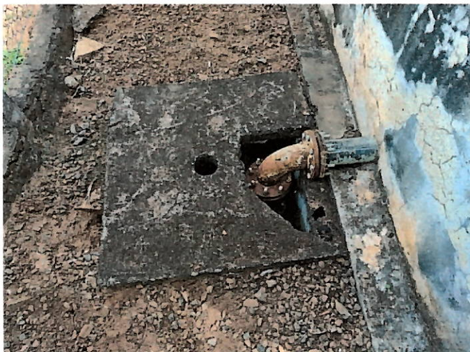
Foto 5: tubulação com sinais de corrosão.
