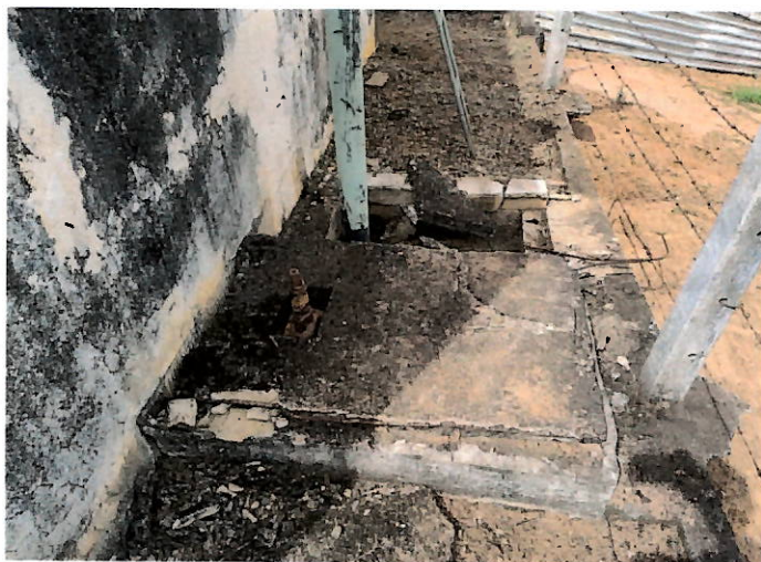
Foto 3: estrutura de concreto danificada.
