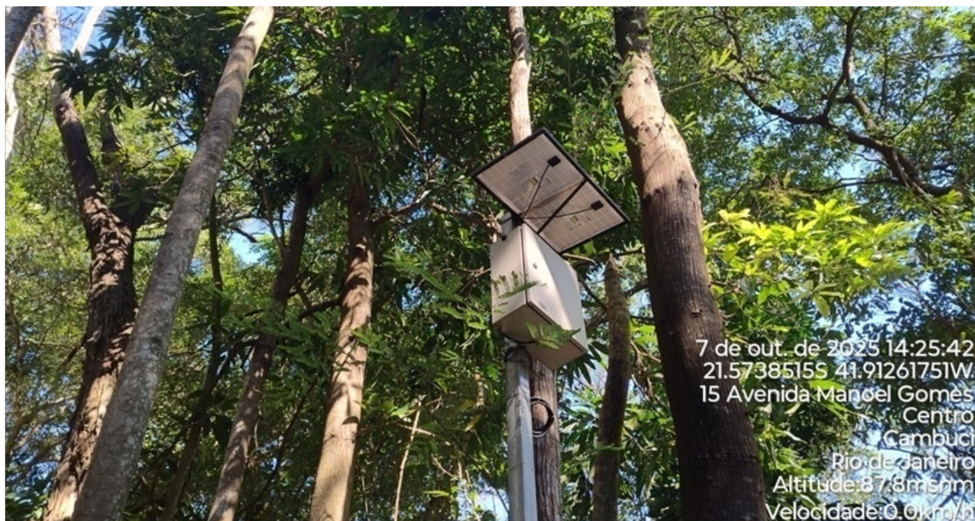
Foto 08: Estrutura de telemetria e controle.
