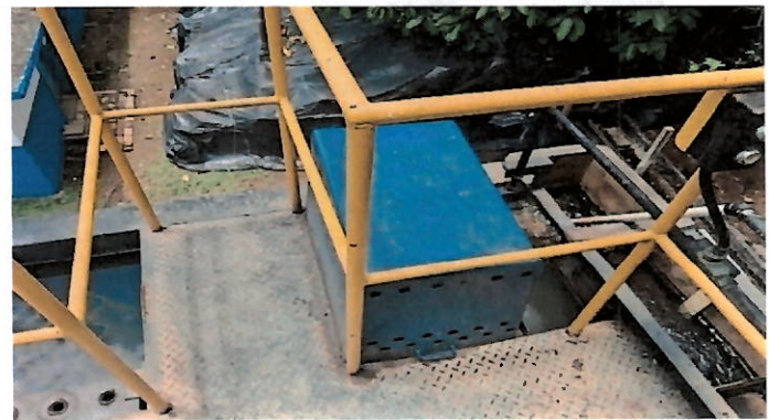
Foto 7: Entrada de água bruta e floclador.
