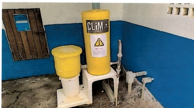
Foto 13: sistema de cloração com hipoclorito de cálcio.
