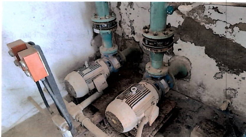
Foto 20: Conjuntos motobombas para adução de água tratada.
