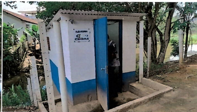
Foto 2: Estação Elevatória de Água Bruta (EEAB).
