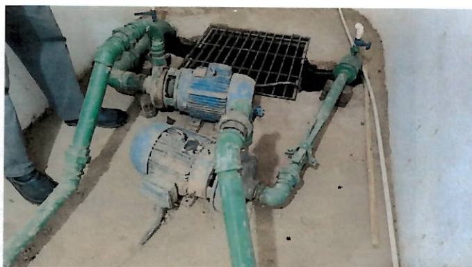
Foto 3: Conjuntos motobombas (10 cv cada).
