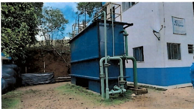
Foto 6: Módulo de tratamento.
