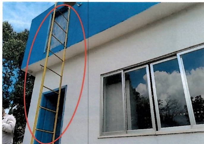
Foto 11: Escada com ausência de gaiola de proteção.
