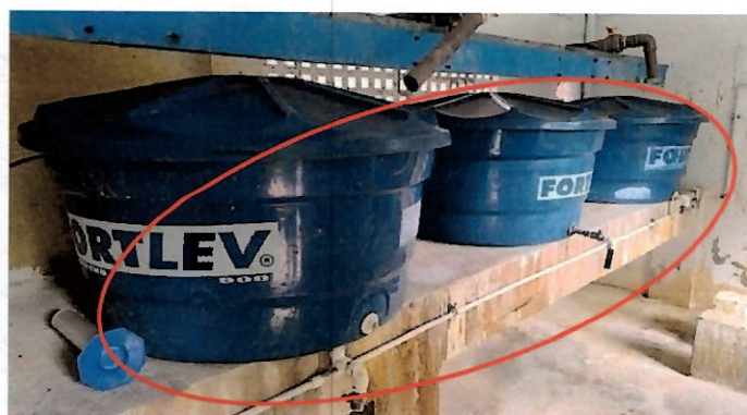
Foto 22: tanques de armazenamento sulfato de alumínio sem bacia de contenção e com indícios de vazamento do produto.
