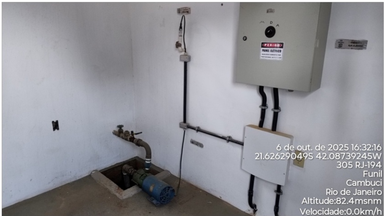
Foto 03 – Pannel de comando da EEAT.
