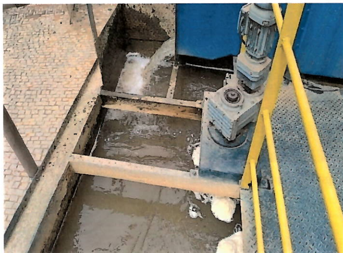
Foto 6: ETA Velha – floculador mecânico.
