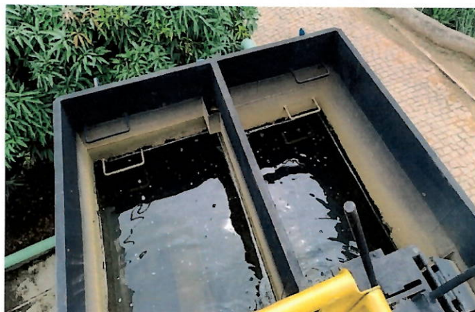
Foto 12: ETA Nova - Filtros.
