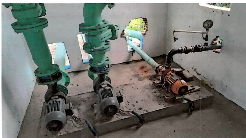
Foto 21: Conjuntos motobombas de retrolavagem dos filtros.
