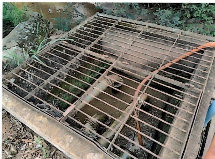
Foto 3: Captação – gradeamento superior.
