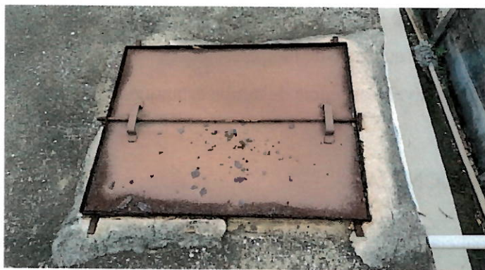
Foto 38: ausência de tampa estanque.
