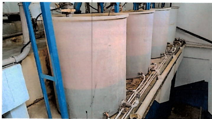
Foto 23: tanques de armazenamento sulfato de alumínio.
