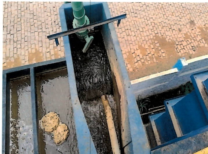
Foto 9: ETA Nova - entrada de água e aplicação de sulfato de alumínio na calha Parshall.
