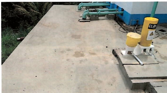
Foto 15: Tanque de contato (80 m 3 ).
