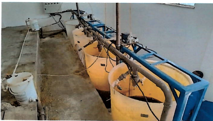
Foto 22: tanques de armazenamento sulfato de alumínio.
