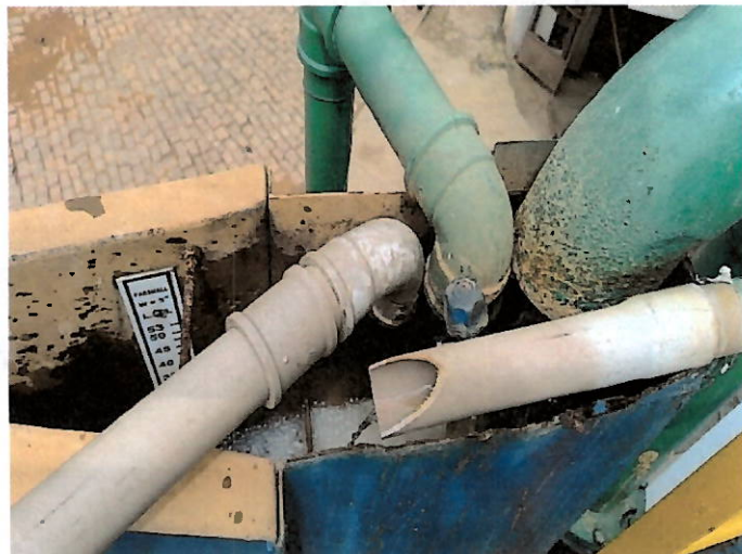
Foto 5: ETA Velha - entrada de água e aplicação de sulfato de alumínio na calha Parshall.
