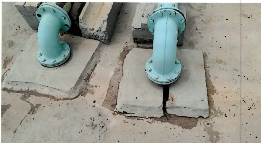
Foto 17: Tampa não estanque.
