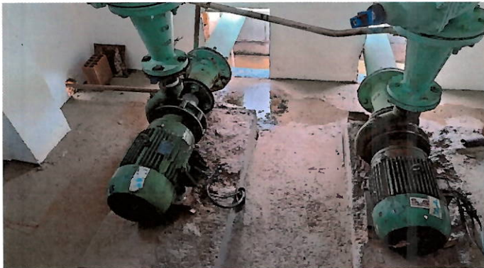
Foto 19: Conjuntos motobombas para adução de água tratada.
