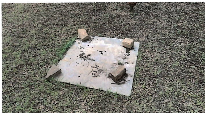
Foto 34: ausência de tampa estanque.
