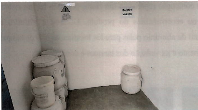
Foto 25: Armazenamento de Hipoclorito de Cálcio.
