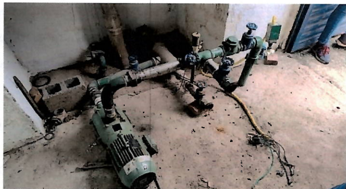
Foto 39: EEAT utilizada para abastecer parte alta do bairro.
