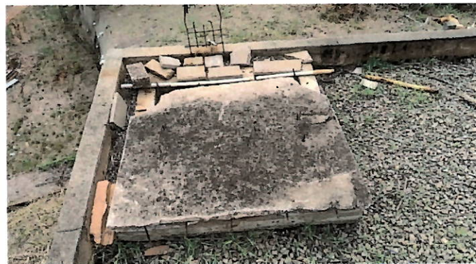
Foto 35: ausência de tampa estanque.
