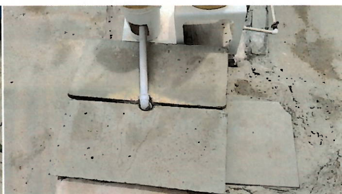
Foto 14: Tampa não estanque.
