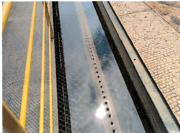
Foto 7: ETA Velha - Decantador.
