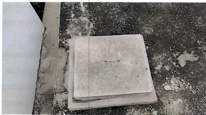
Foto 37: ausência de tampa estanque.
