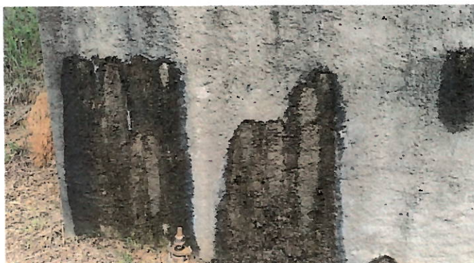
Foto 32: pontos de infiltração no reservatório.
