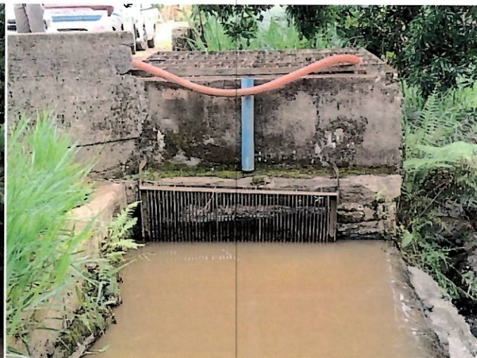
Foto 2: Captação – gradeamento lateral.
