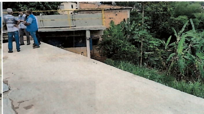
Foto 16: Ausência de guarda-corpo sobre tanque de contato.
