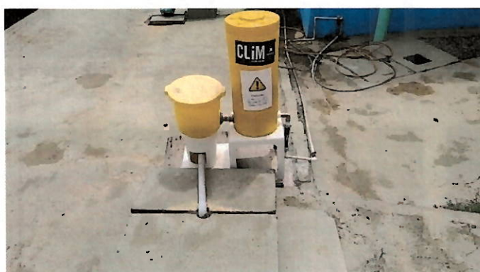
Foto 13: sistema de cloração com hipoclorito de cálcio.
