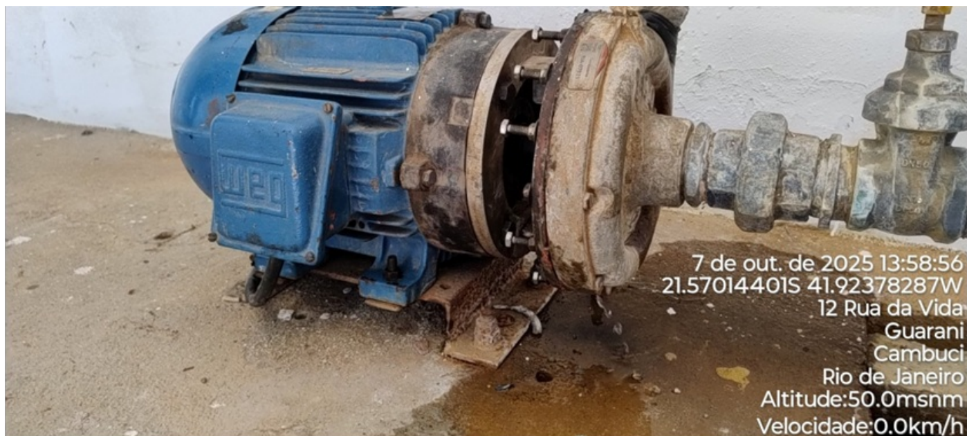
Foto 04 – Vazamento na bomba.
