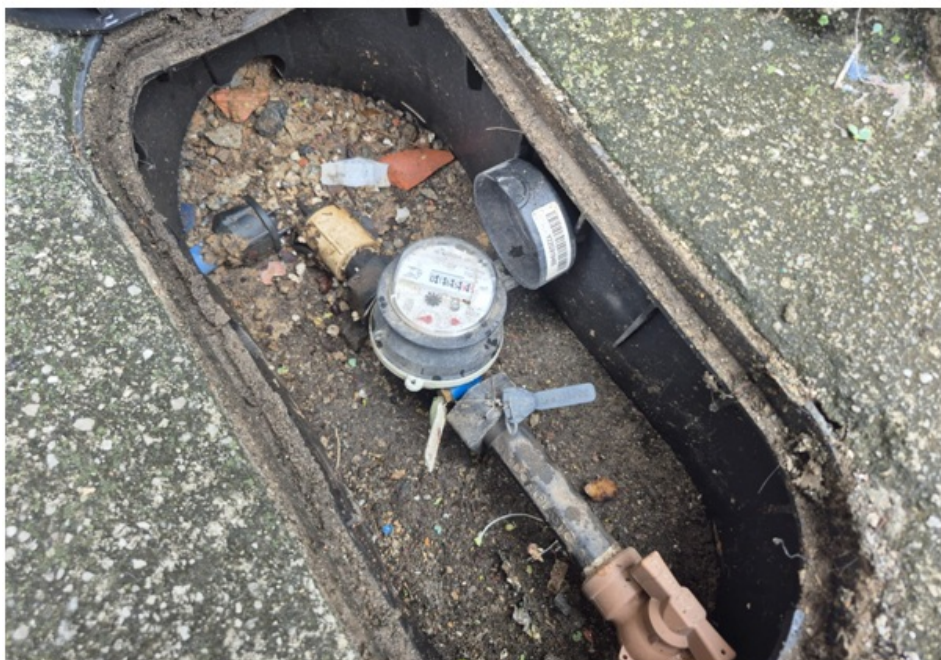
Foto 3 – Hidrômetro do imóvel
