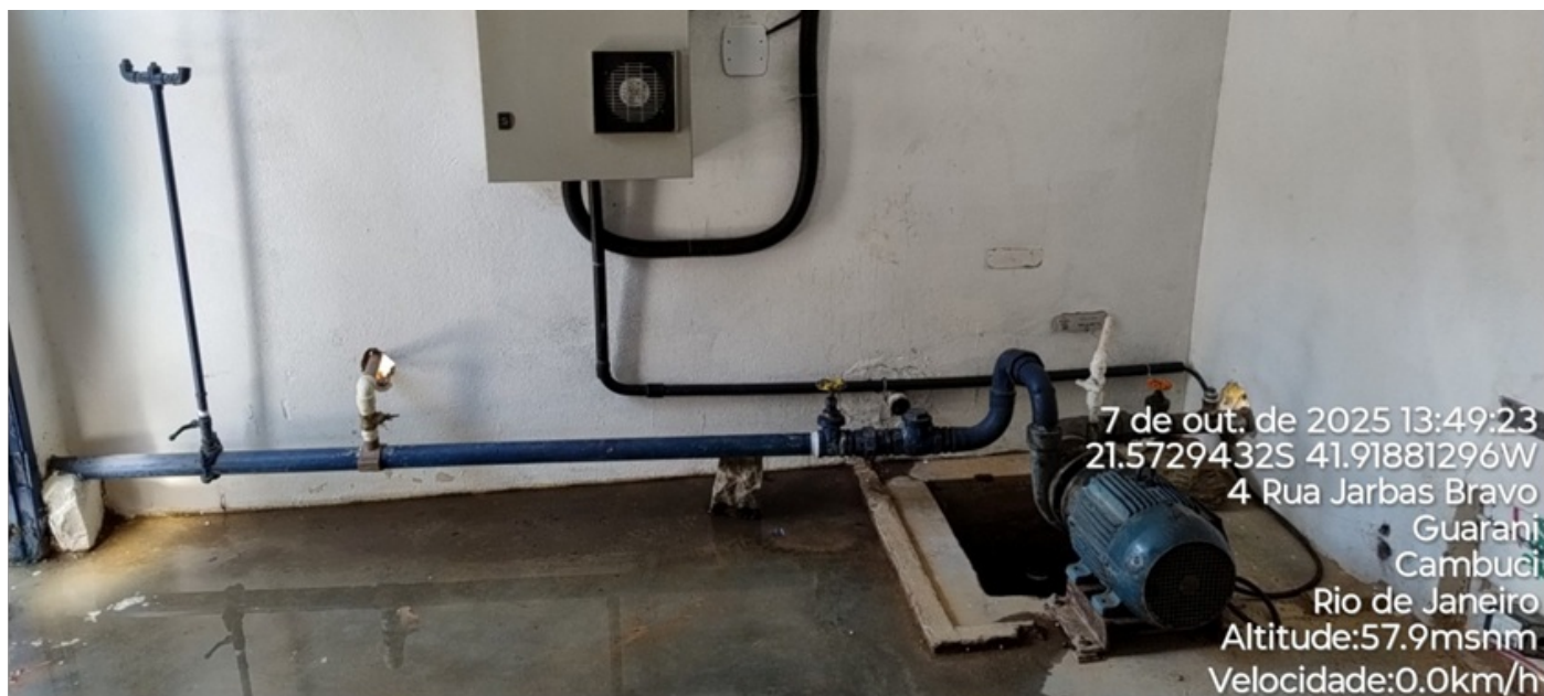
Foto 04 – Painel de comando da EEAT.
