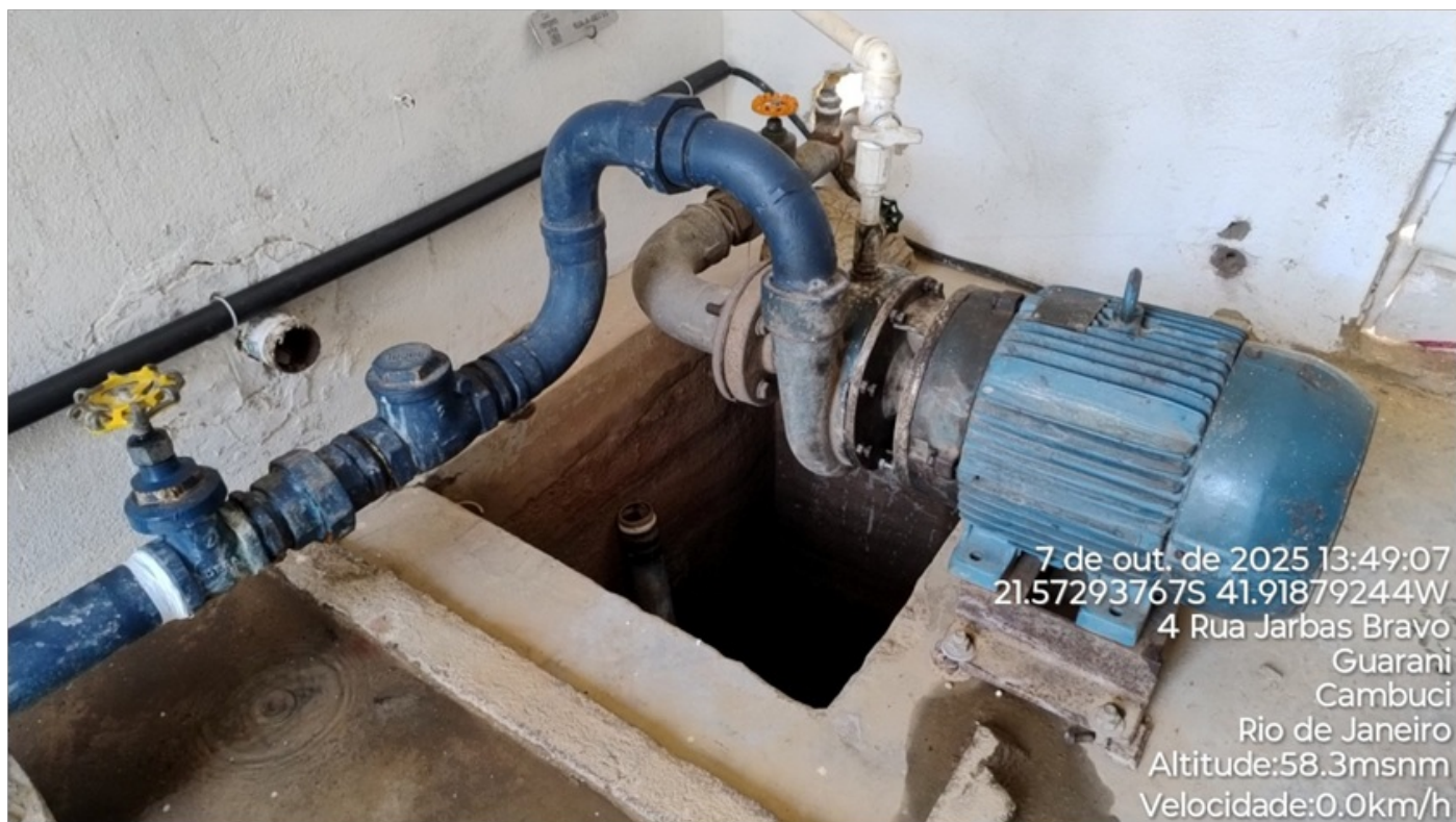
Foto 05 – Vazamento no registro da tubulação.
