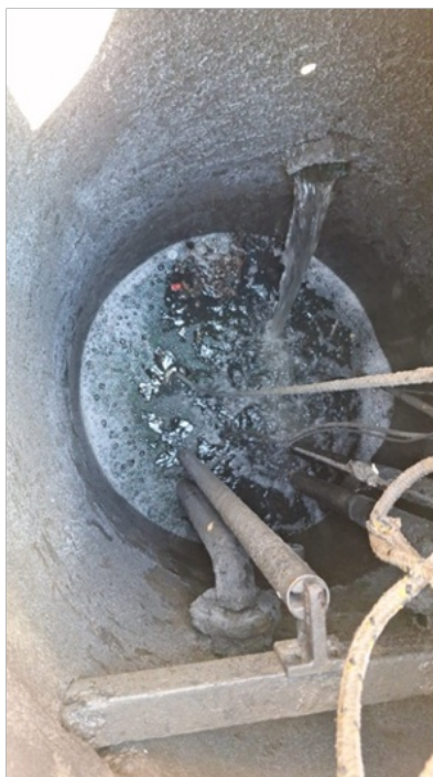
Foto 5 – Vista interna do poço da EEE Cinco de Julho com uma bomba.
