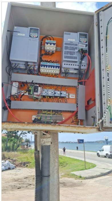
Foto 6 – Vista interna do quadro elétrico da EEE com dois inversores de frequência.
