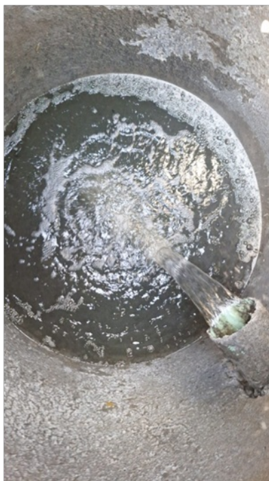
Foto 7 – Caixa de areia , antes do poço de sucção de esgoto (poço da bomba).
