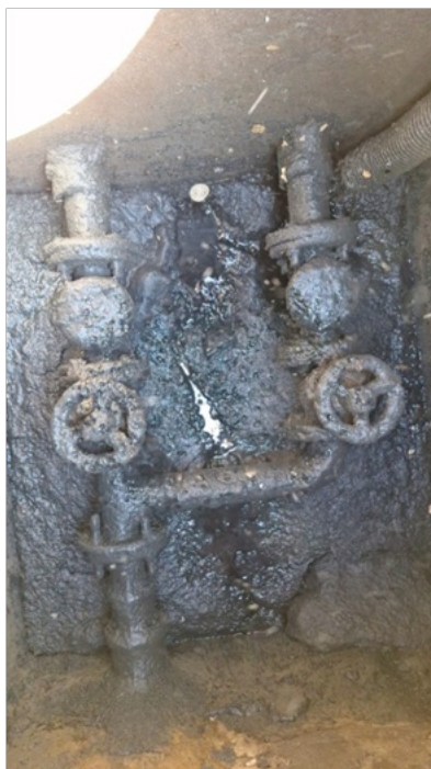
Foto 8 – Caixa do Barrilete, sinalizando que não recebe limpeza a algum tempo e que há infiltrações ou vazamentos.
