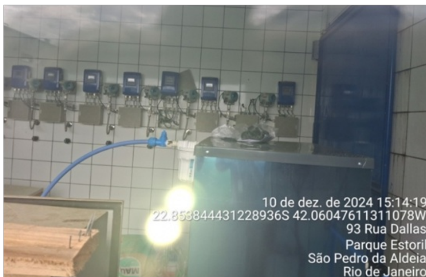
Foto 5 - Medidores de vazão das sub-adutoras alimentadas pelo barrilete da EEAT Parque Estoril
