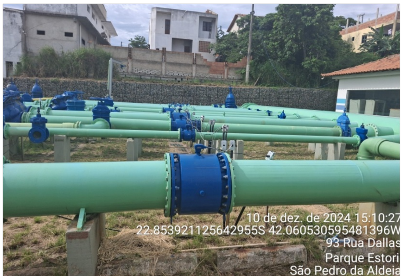
Foto 4 - Barrilete com suas válvulas para operação sistema da Região dos Lagos
