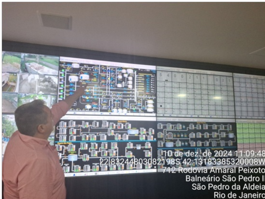
Foto 2 - Controle operacional do sistema da Região dos Lagos
