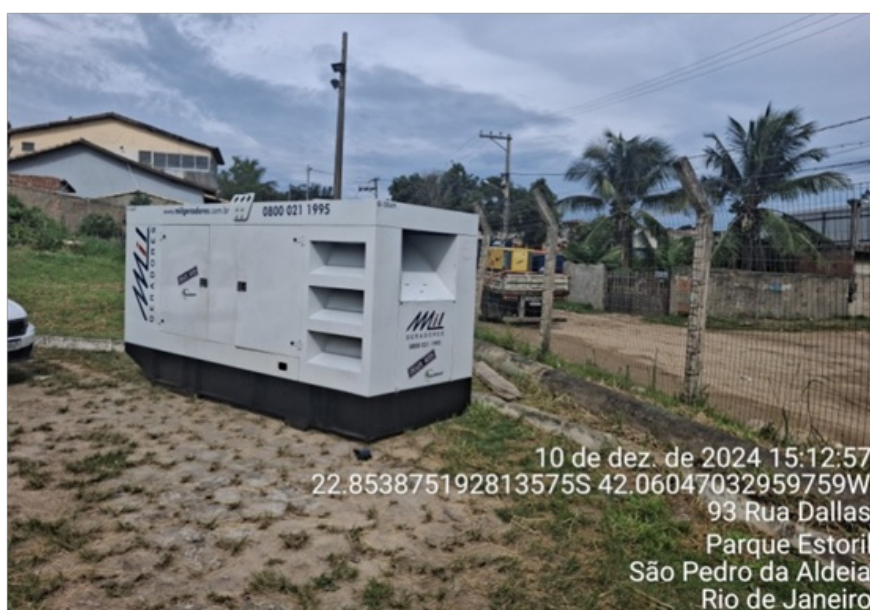
Foto 6 - Gerador para segurança operacional (sem dique de contenção para óleo diesel)
