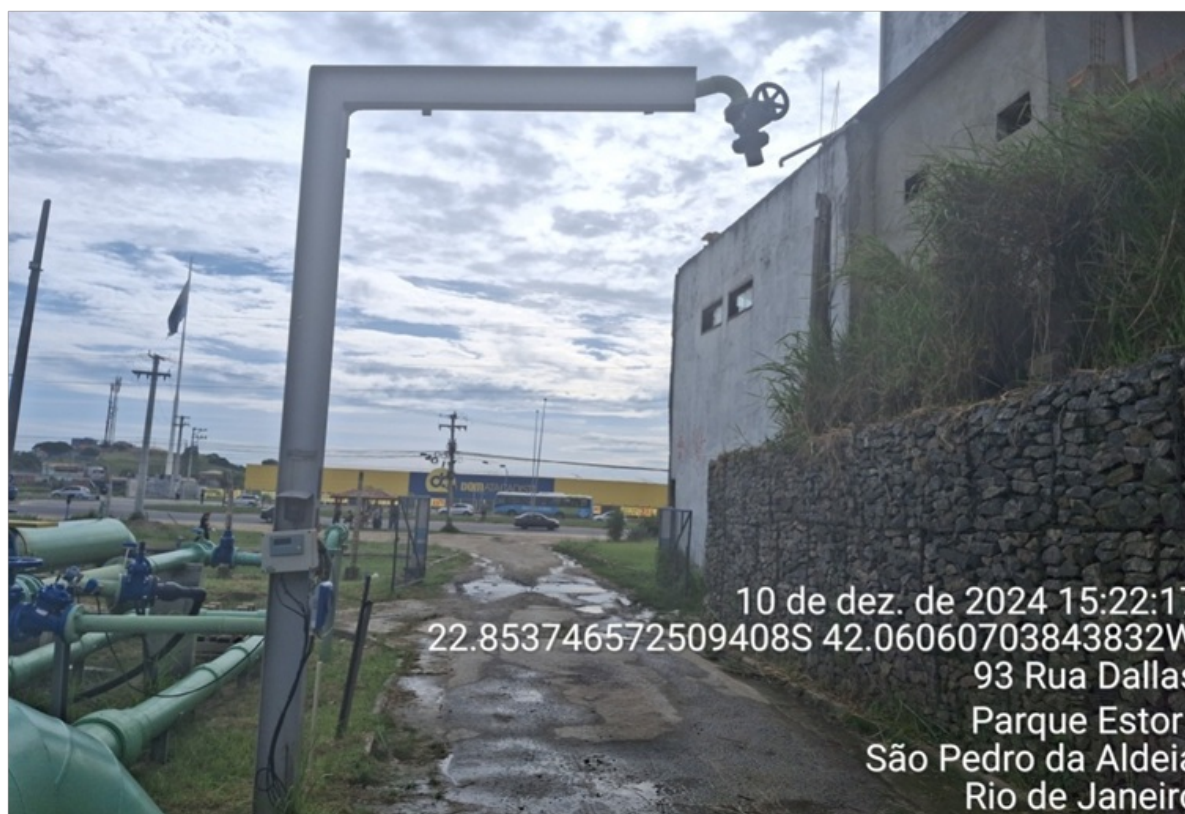
Foto 9 - Vista do Ponto de abastecimento de carro pipa instalado no barrilete
