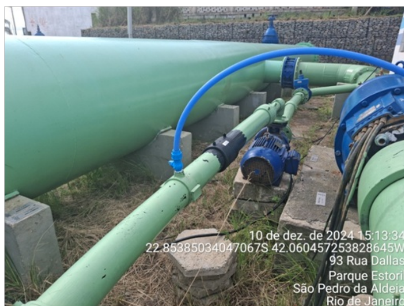
Foto 7 - Bombeamento de uma das sub-adutoras
