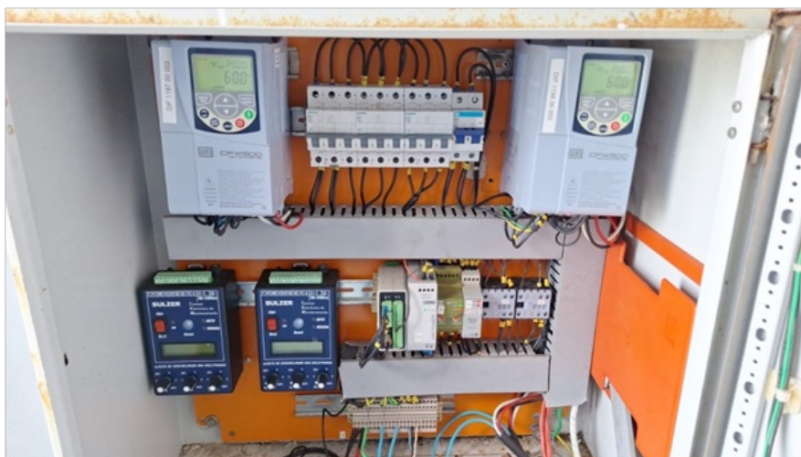
Foto 4 – Vista interna do quadro elétrico da EEE com dois inversores de frequência,
