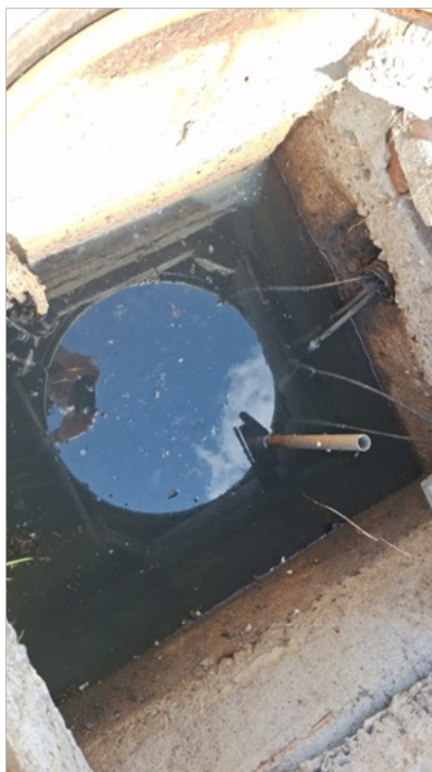
Foto 3 – Vista interna do poço da EEE Praia dos Amores com uma bomba.
