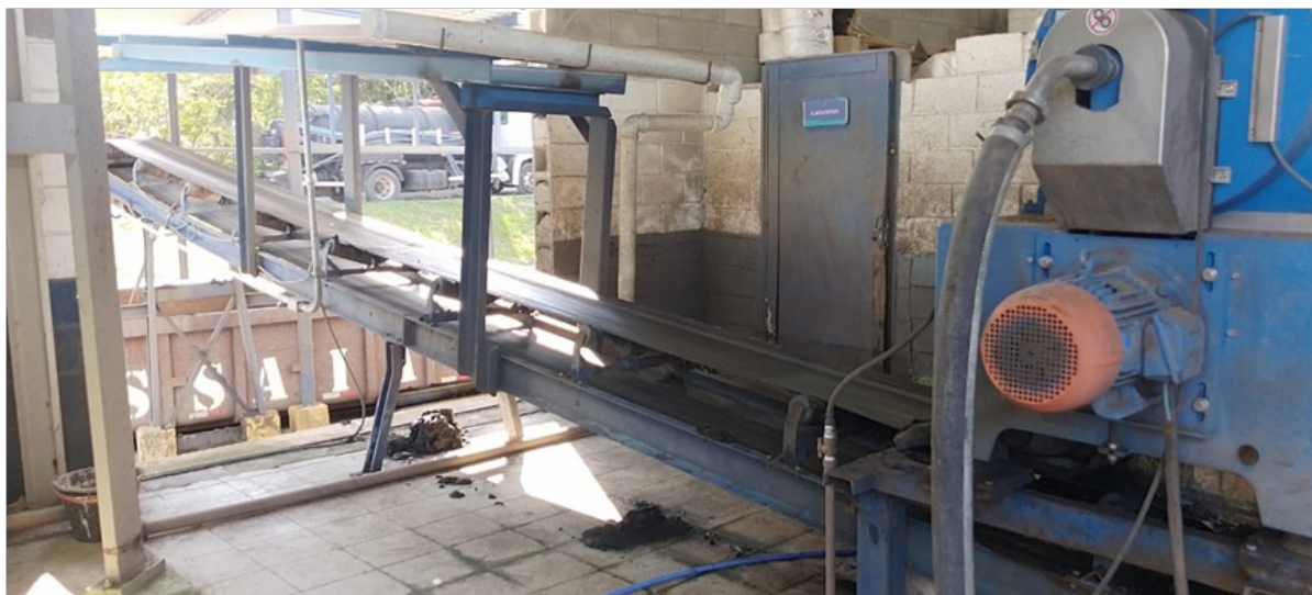
Foto 12 – Caçamba para depósito do lodo centrifugado, carregada por esteira rolante. Seu destino é aterro sanitário.
