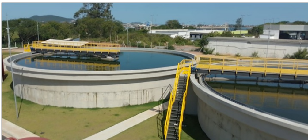
Foto 9 - Novos Decantadores, aguardando início da operação
