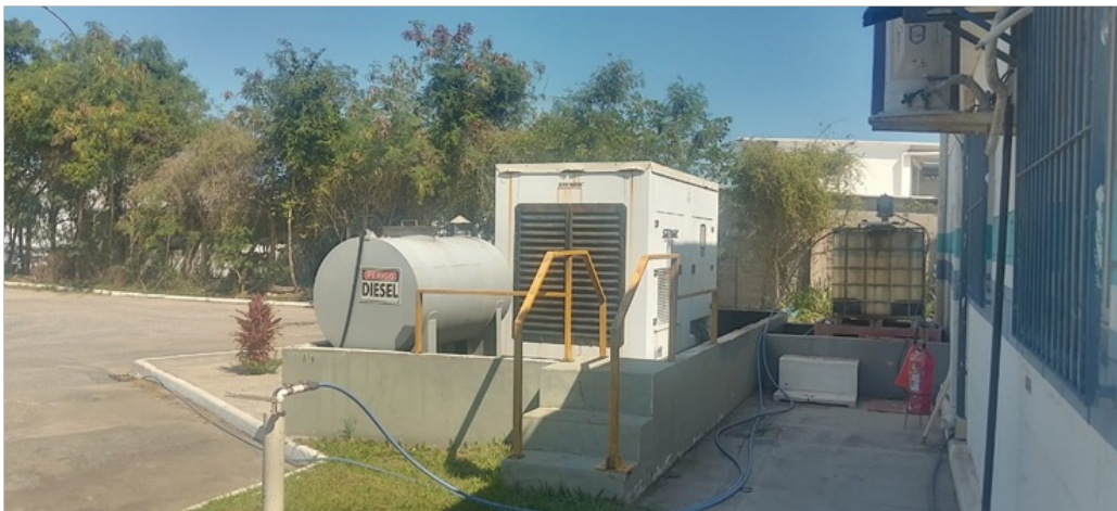
Foto 4 - Gerador para segurança operacional (Dique de contenção para óleo diesel)
