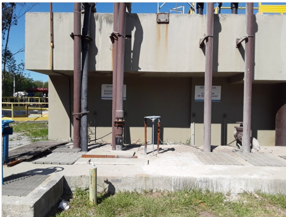
Foto 7 - Elevatória de Esgoto Bruto
