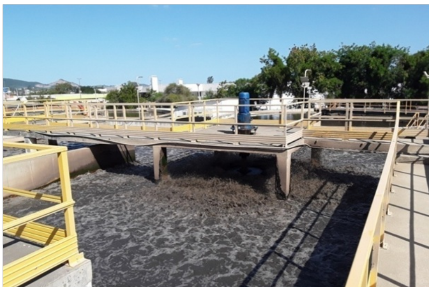
Foto 8 – Reator aeróbio (Lodo ativado).
