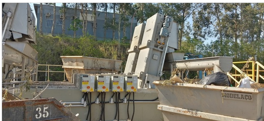
Foto 6 - Tratamento preliminar novo (gradeamento mecanizado)
