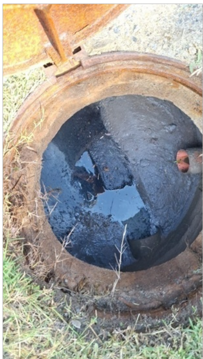
Foto 4 – PV de chegada dos recalques das EEE's Kite Surf e Clube Náutico.
