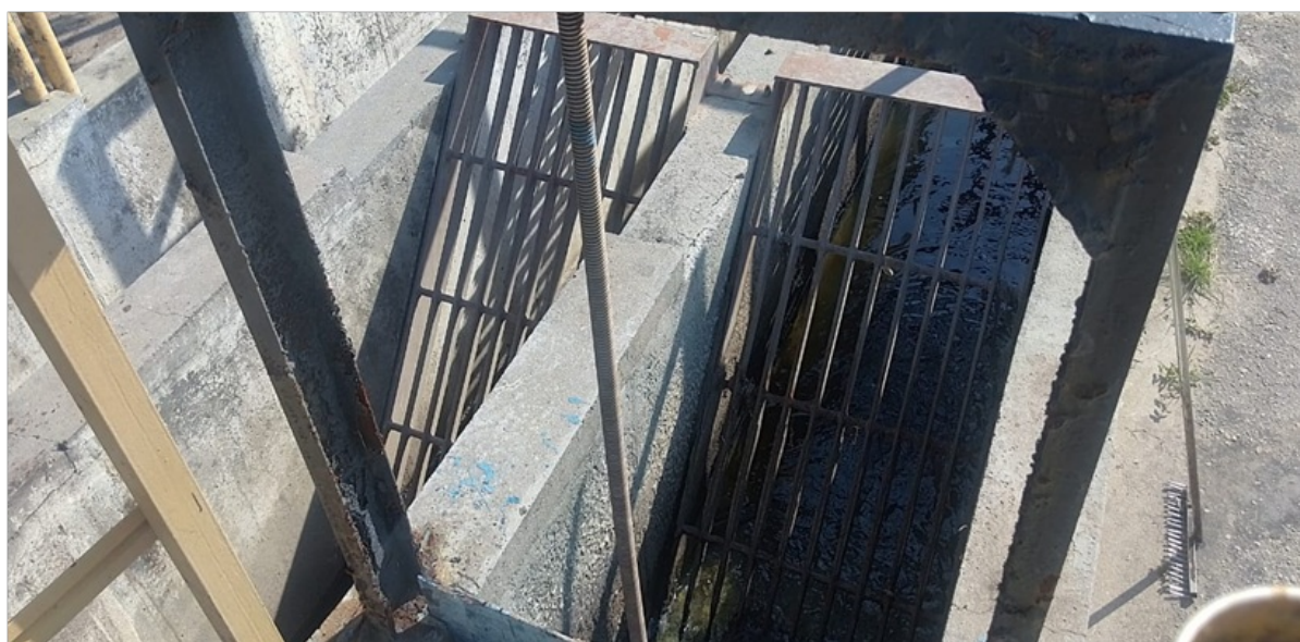
Foto 3- Gradeamento para retenção de resíduos sólidos grosseiros.
