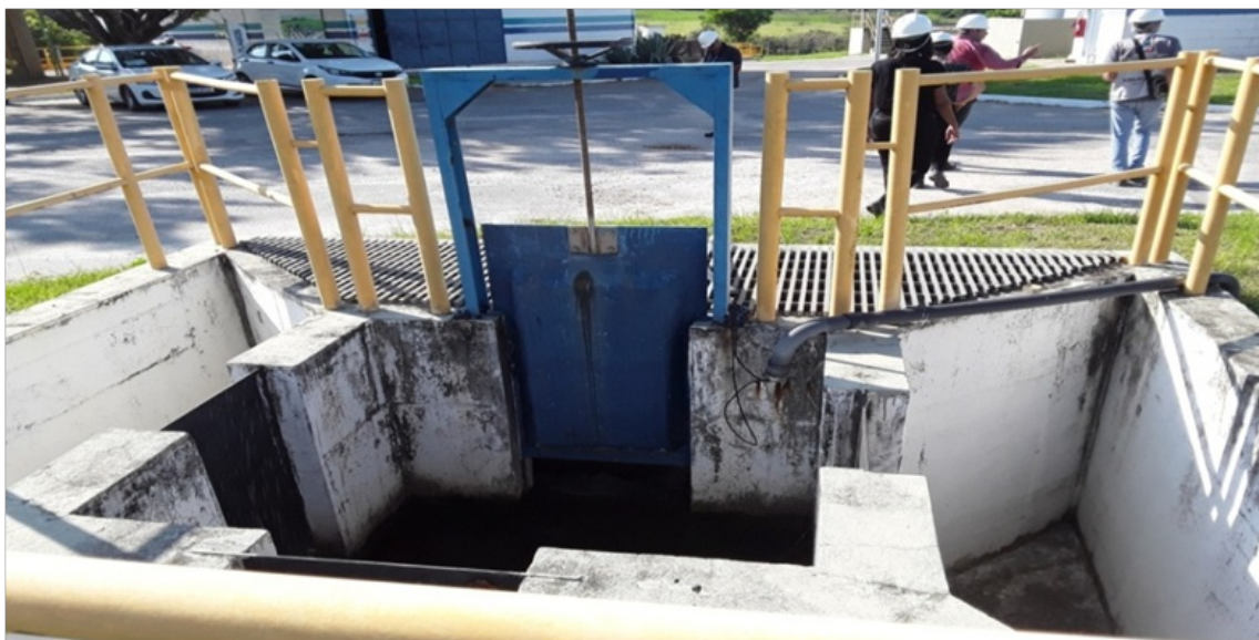
Foto 2- Caixa distribuição de Vazão.
