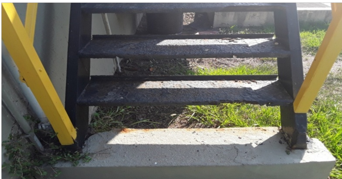
Foto 19 - Degraus com falta de manutenção, risco de acidentes (Tanque de Aeração).
