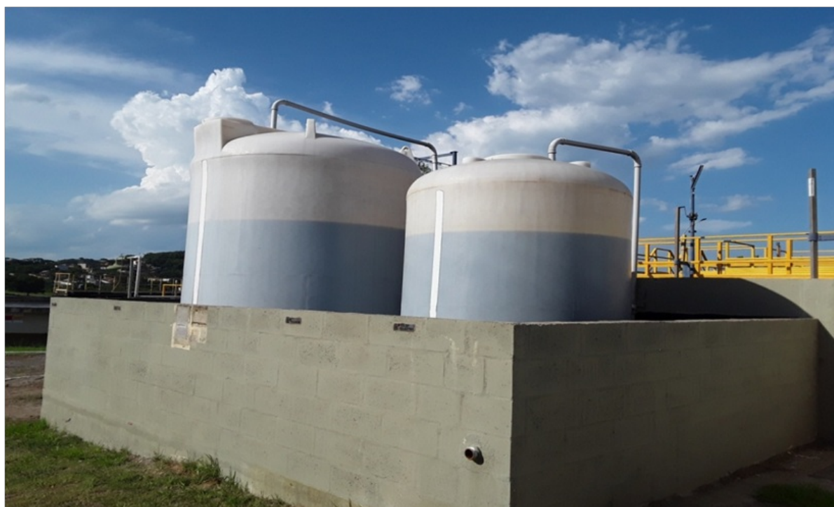
Foto 11- Reservatórios de PAC (Policloreto de Alumínio).
