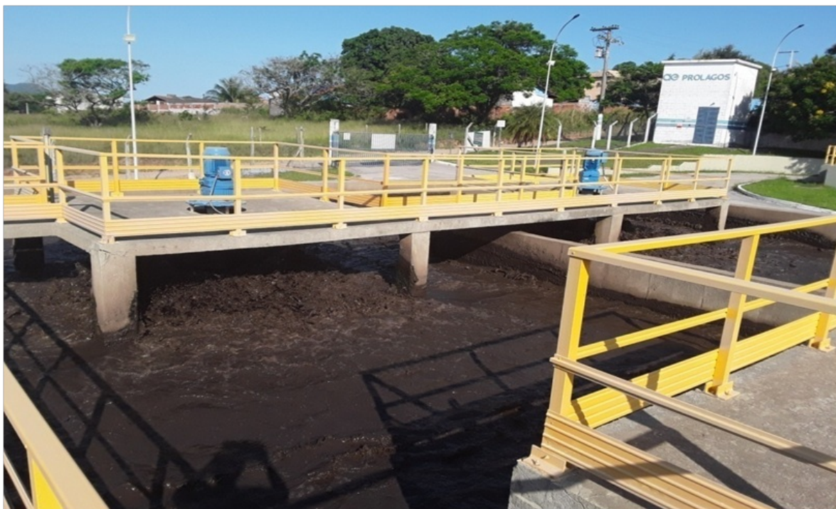
Foto 8- Tanques de aeração (lodo ativado).
