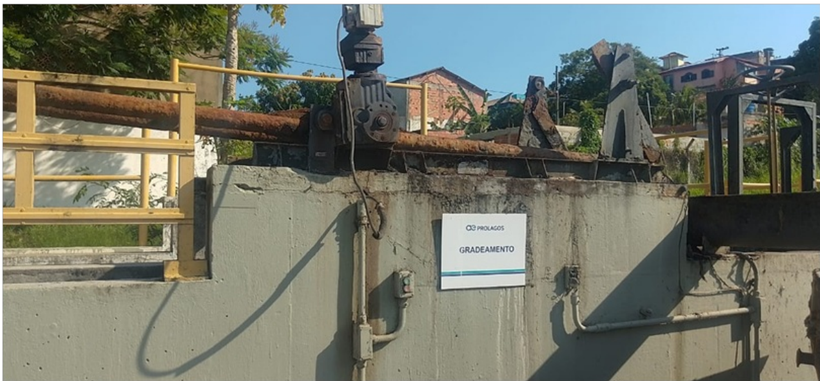
Foto 5 - Gradeamento, estrutura em má conservação e ferrugem.
