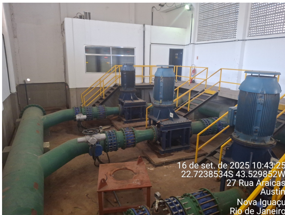
Foto 2: Conjunto de motobombas
