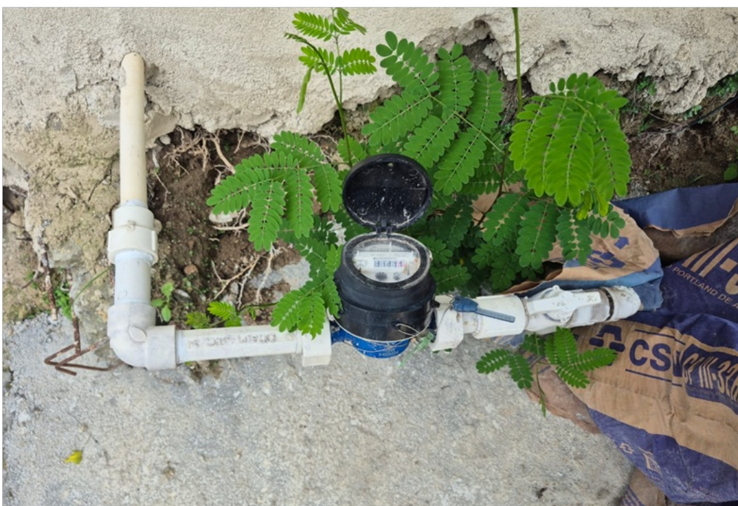
Foto 6 – Medidor instalado do lado de fora do imóvel
