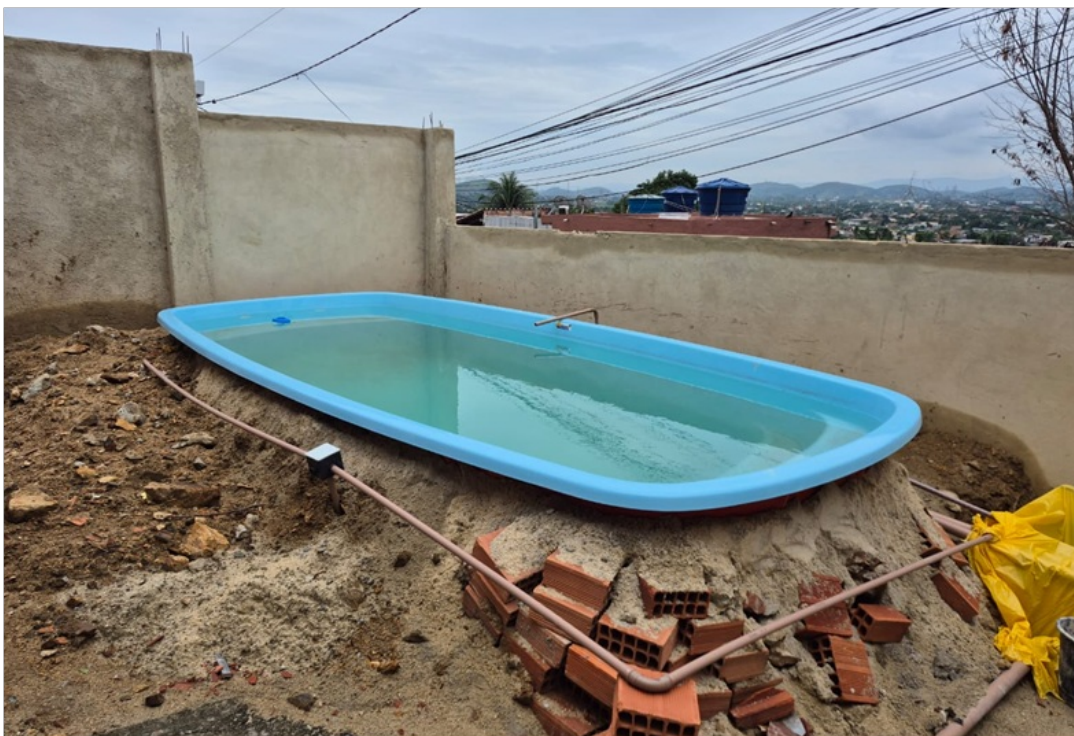
Foto 5 – Piscina do imóvel com altura aproximada de 3 metros, em relação ao logradouro
