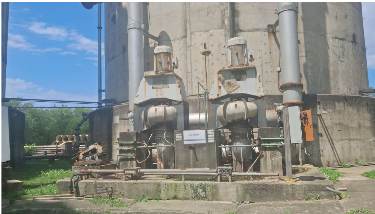
Foto 49: Maquinário dos digestores anaeróbicos em estado de abandono.
