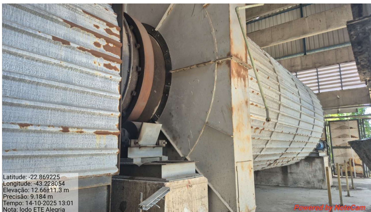
Foto 62: Secador térmico inoperante.
