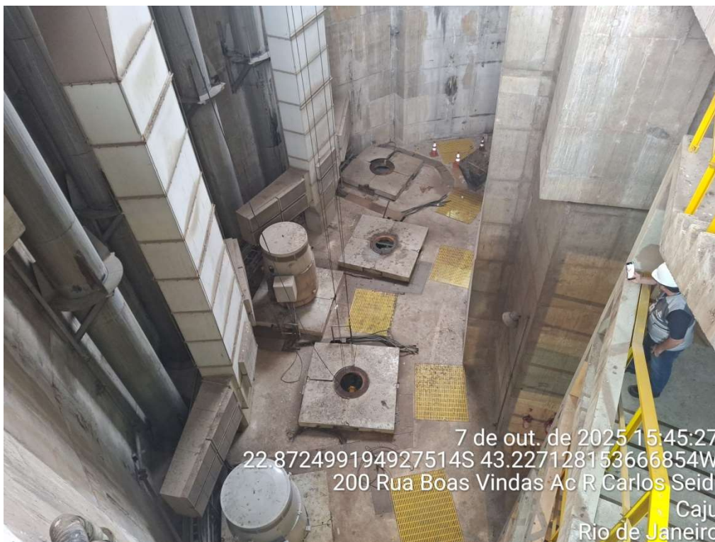
Foto 6 – Estação Elevatória com presença apenas de apenas 2 (duas) motobombas. Uma estava em funcionamento.
