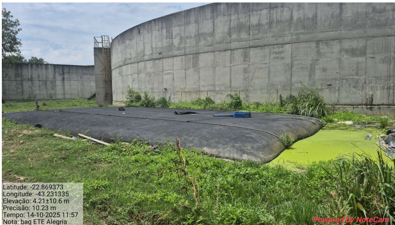
Foto 32: Segunda bag sem contenção devida aparente e indício de eutrofização na "lagoa" ao entorno da bag.
