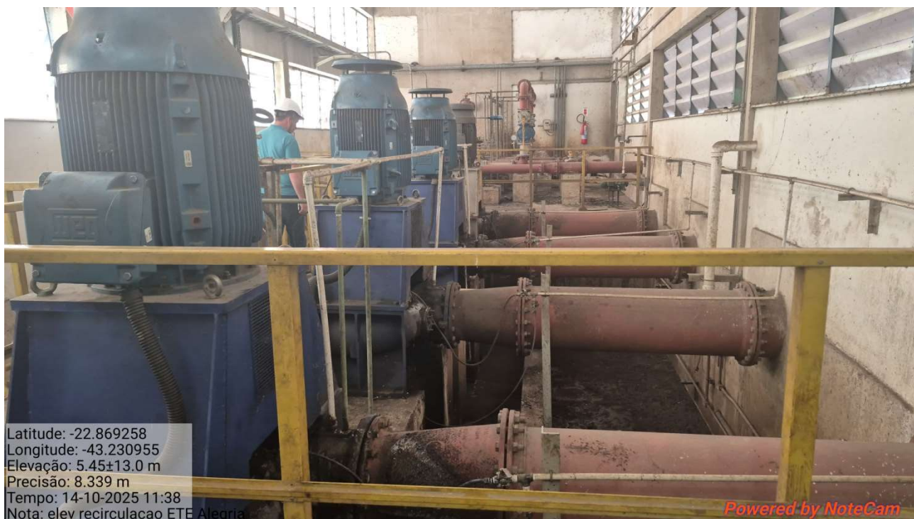
Foto 33: Conjunto motobombas – EE recirculação de lodo.
