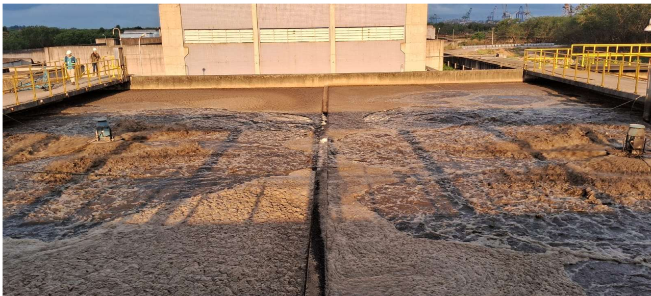
Foto 22: Tanque de aeração com aeradores mecânicos.
