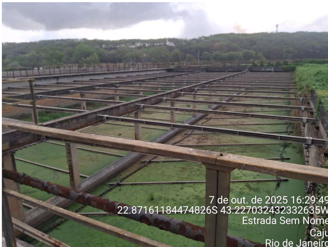
Foto 16: Indícios fortes de eutrofização em um dos decantadores primários, indicando falta de manutenção e inatividade das estruturas.
