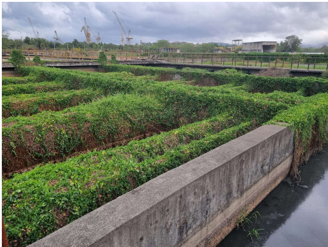
Foto 20: Decantadores em total abandono.
