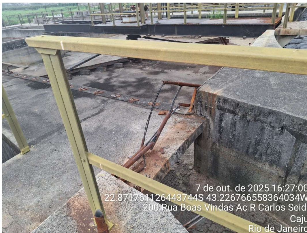
Foto 15: Componentes da caixa de areia em total abandono.
