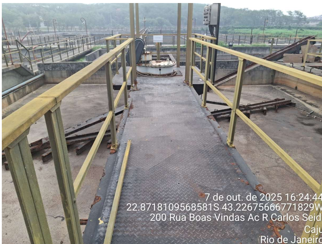
Foto 14: Caixa de areia inoperante.
