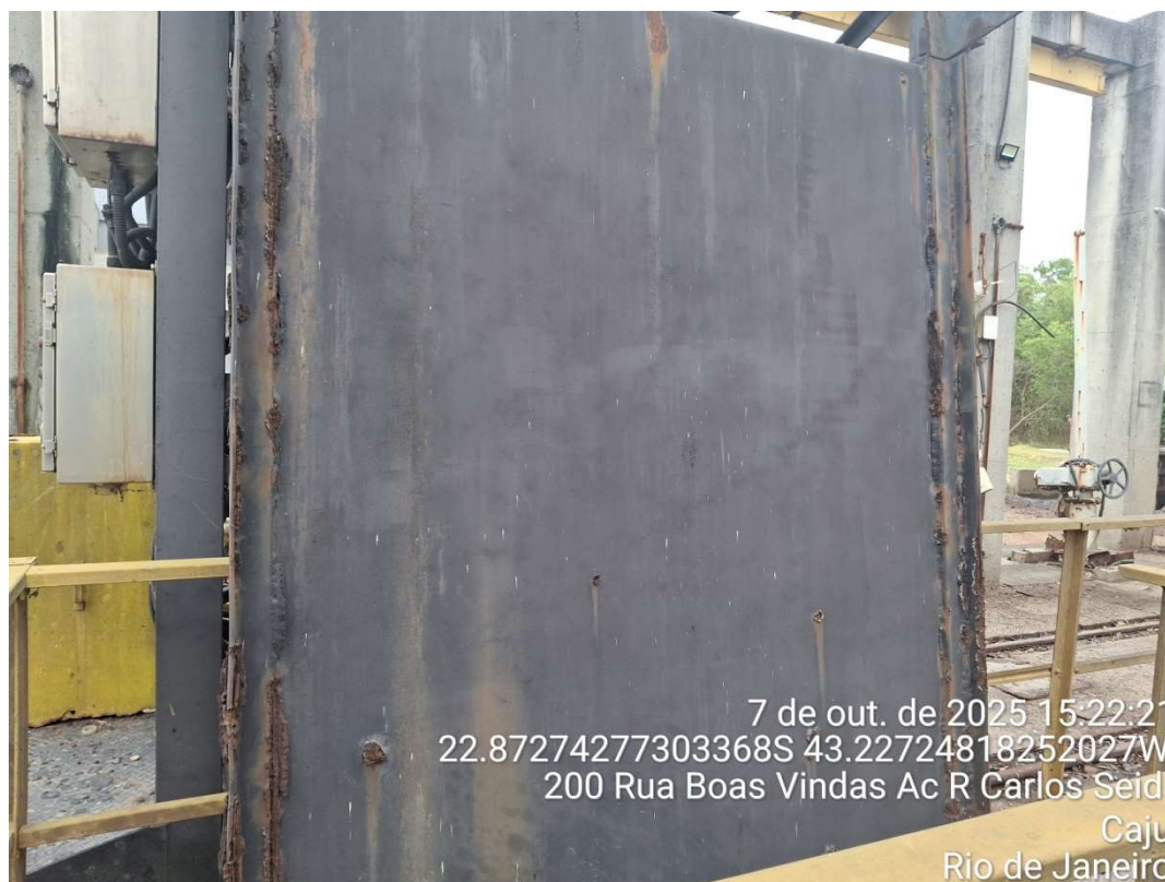
Foto 1 – Esteira do gradeamento inoperante e com sinais fortes de corrosão.
