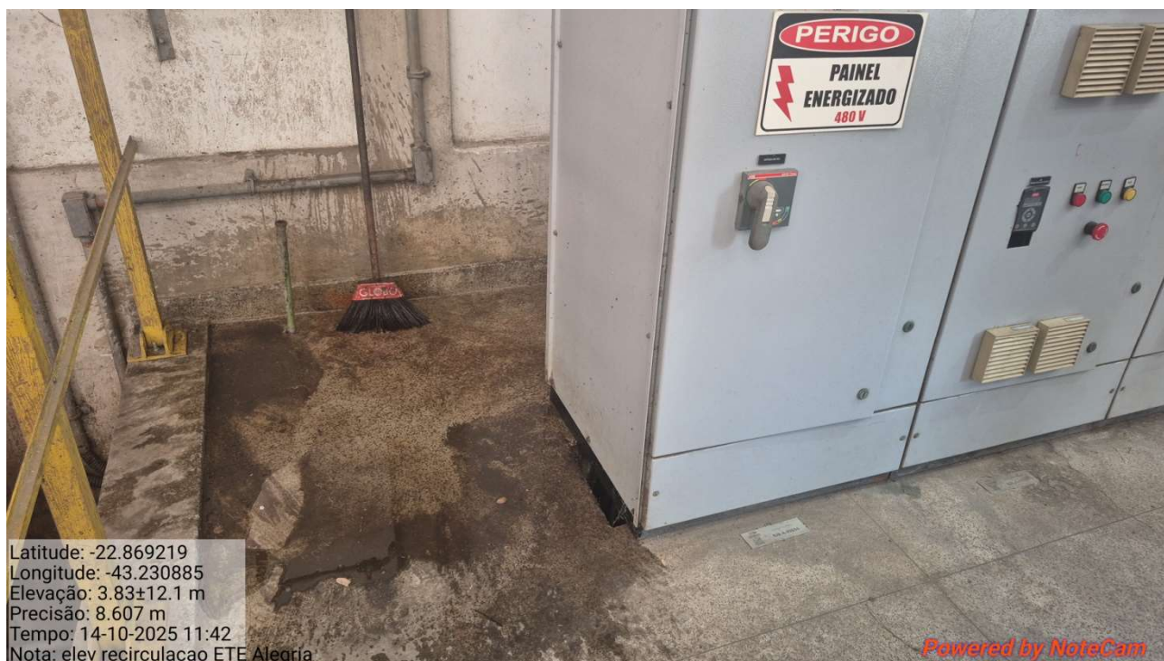
Foto 37: Água e resíduos e lodo vazado acumulados próximos ao painel elétrico.
