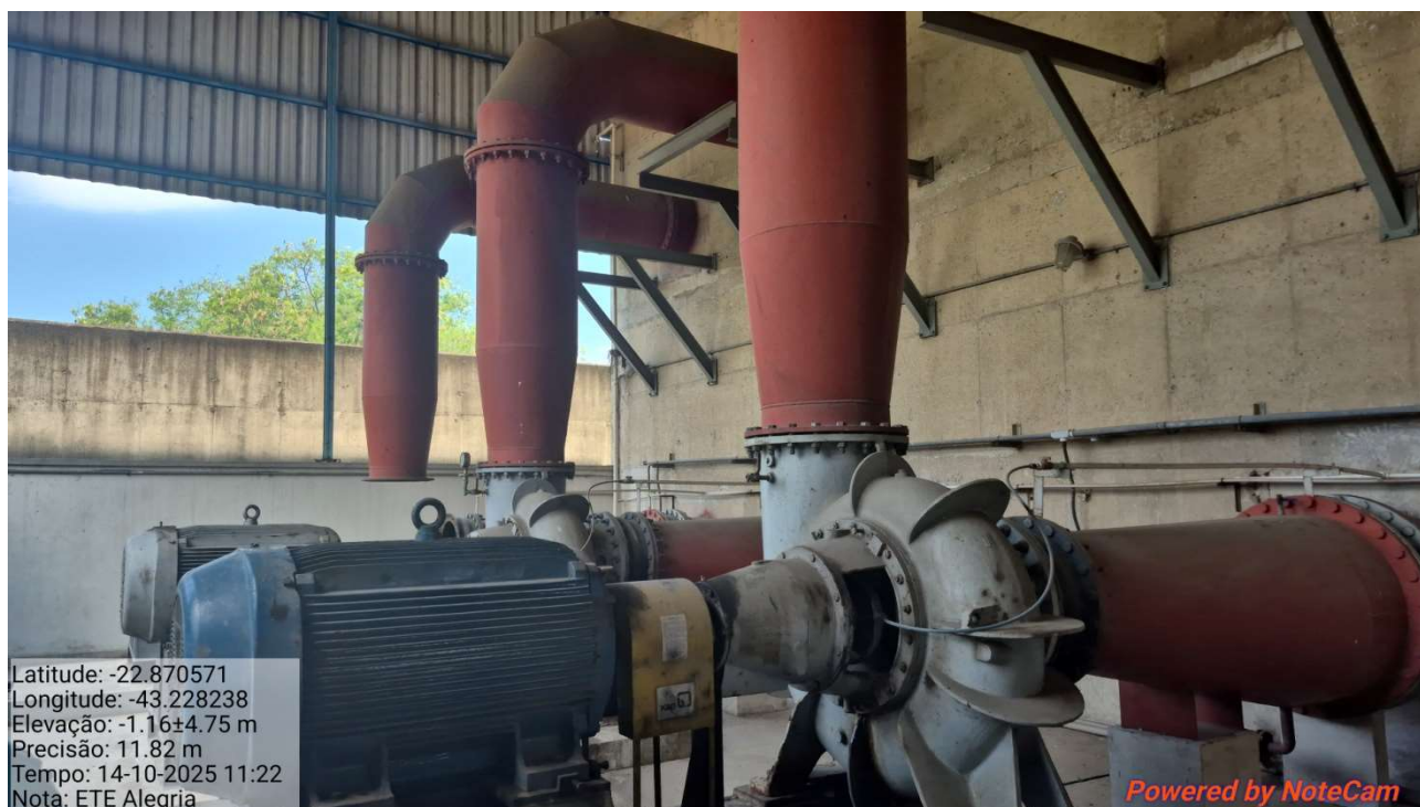
Foto 39: Conjunto motobombas da elevatória intermediária.
