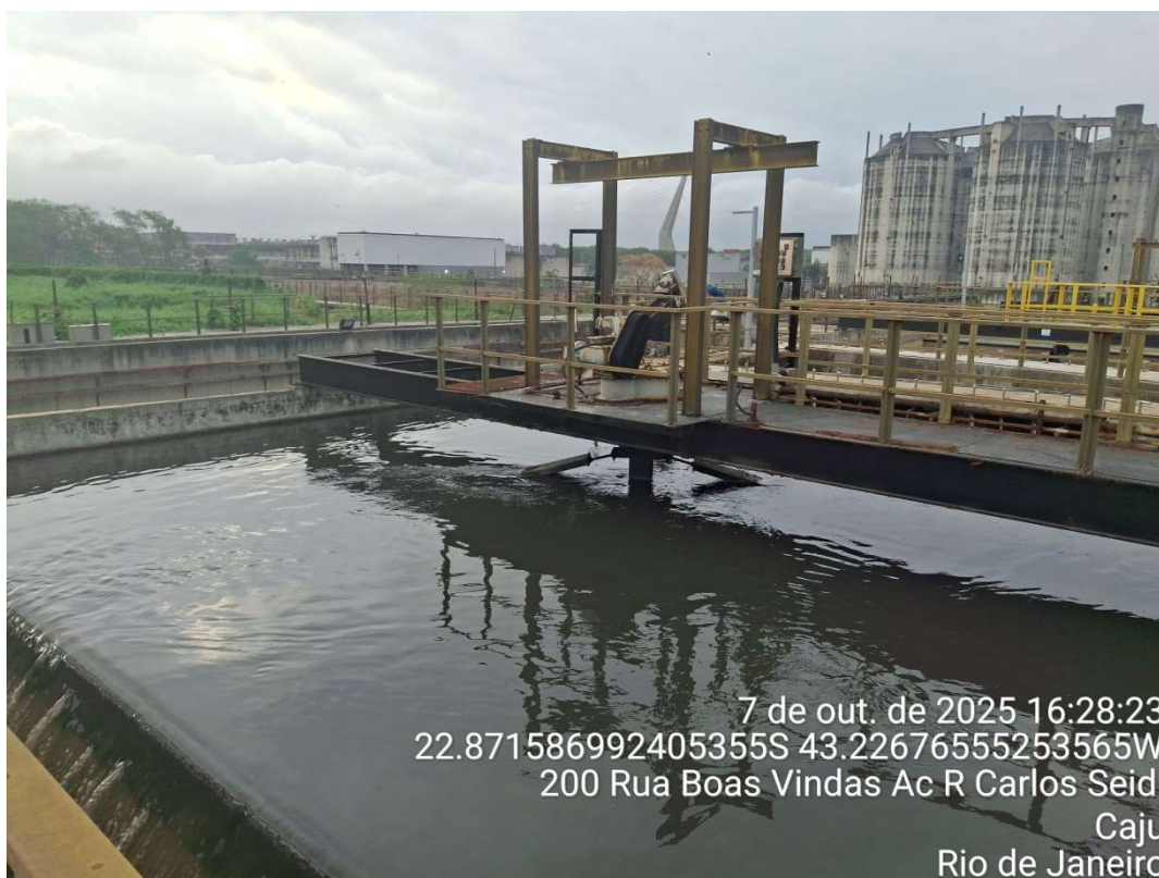
Foto 13: Única caixa de areia em operação precária.
