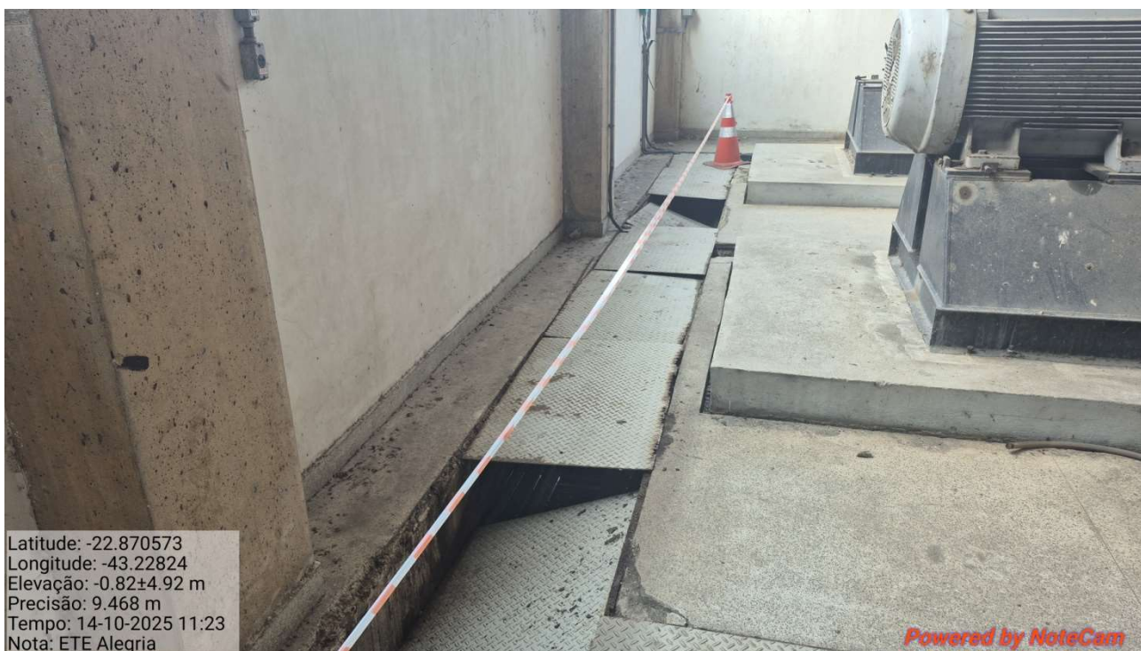
Foto 40: Canaleta danificada com isolamento improvisado.
