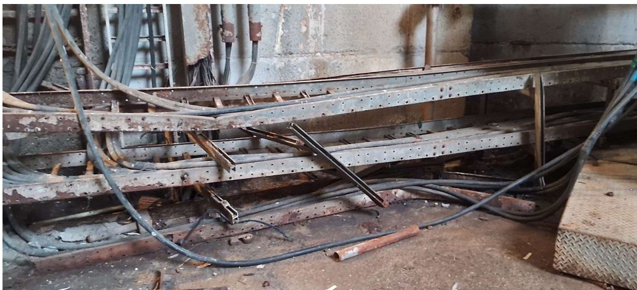
Foto 7 – Fiação elétrica exposta.
