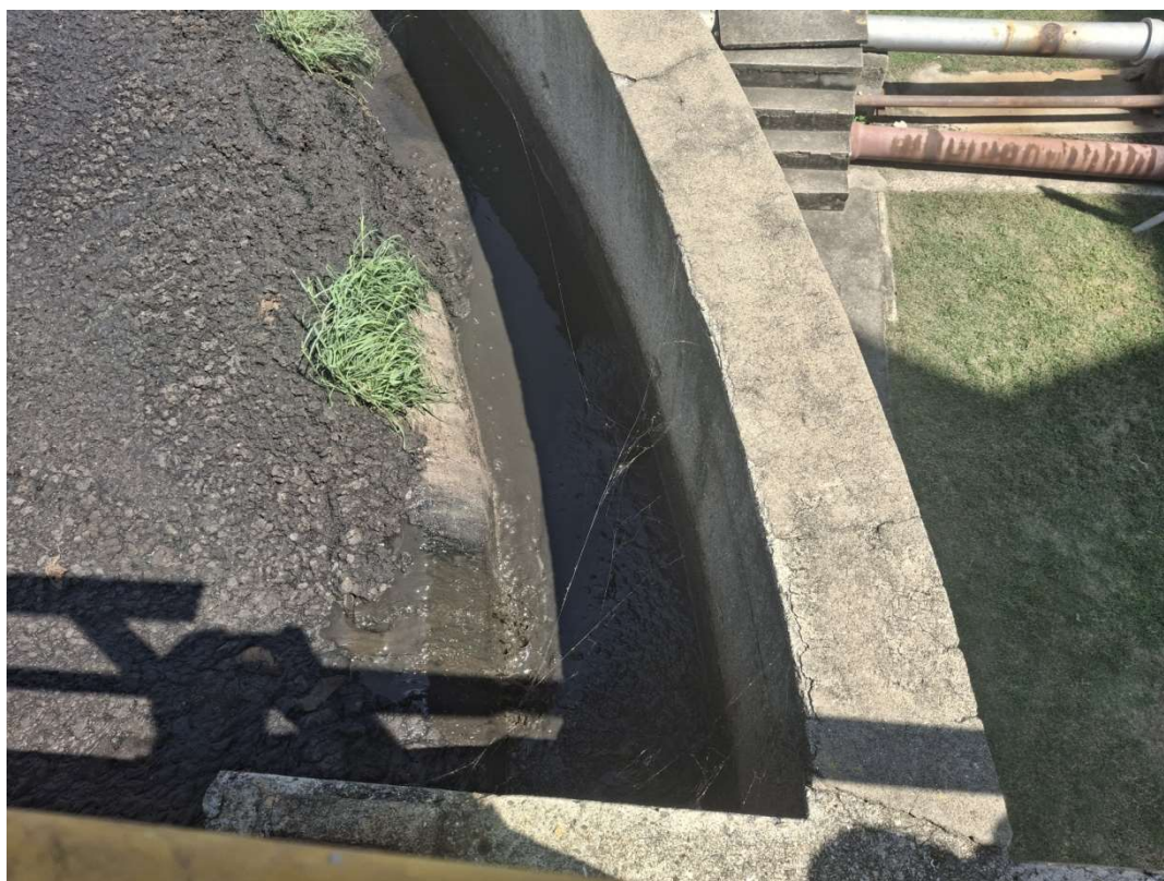
Foto 44: Saída de sobrenadante com clarificação insuficiente.
