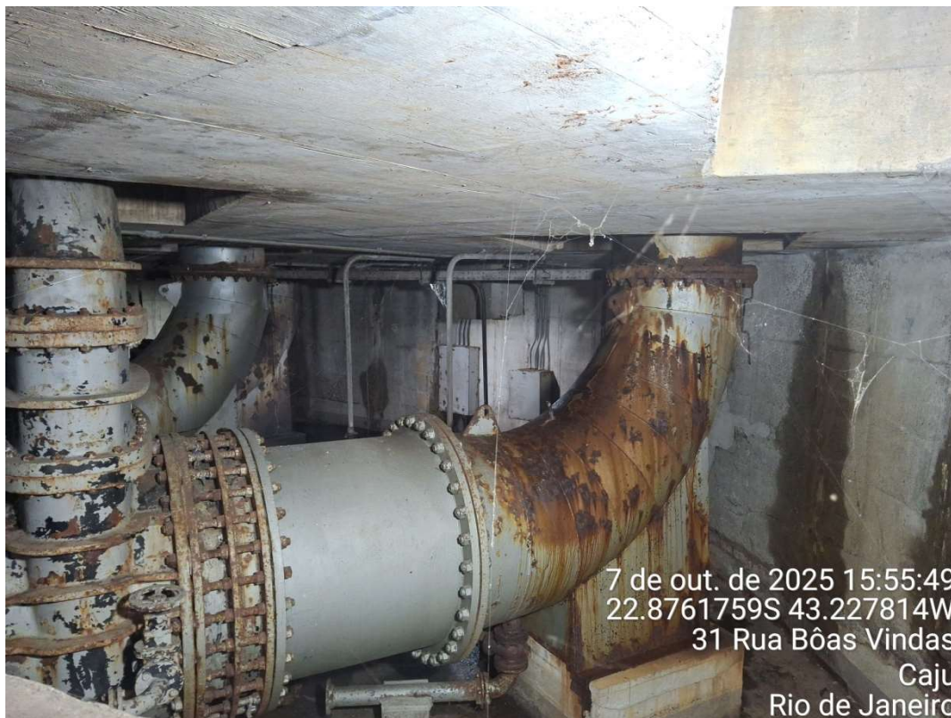
Foto 8 – Curva de redução na porção inferior da EE com sinais fortes de corrosão nas juntas.
