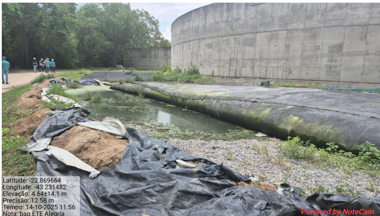
Foto 30: Formação de uma “lagoa” de eutrofização no perímetro da bag. Lona de contenção apresentando rasgos e fragilidade do sistema de contenção.
