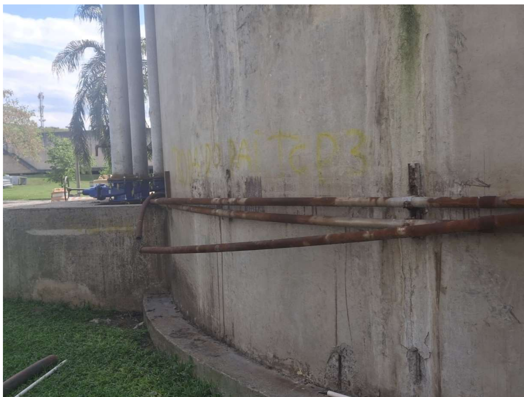
Foto 53: Estruturas do biodigestor em estado avançado de degradação.
