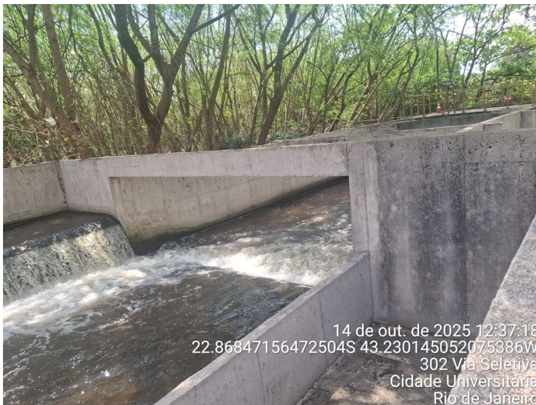
Foto 63: Saída do efluente tratado.
