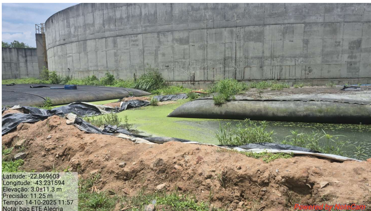
Foto 31: Vegetação no perímetro, indicando falta de manutenção.
