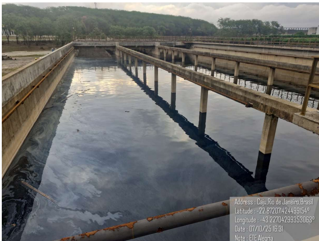
Foto 21: Decantador funcionando parcialmente, com presença de chorume.
