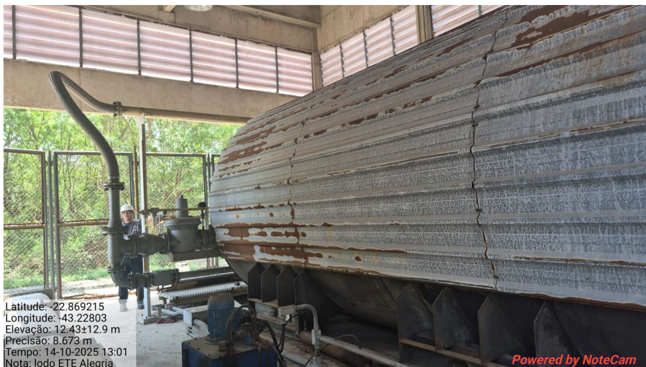
Foto 61: Secador térmico inoperante.
