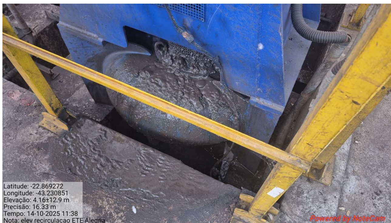
Foto 34: Acúmulo intenso de resíduos e sinais de vazamento.
