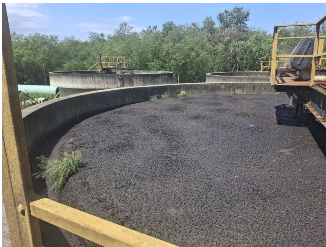
Foto 42: Adensadores com ausência de limpeza e presença de vegetação. Acúmulo excessivo de lodo.
