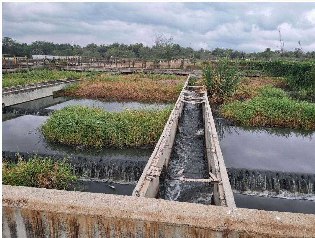
Foto 18: Decantador em estado de total abandono.
