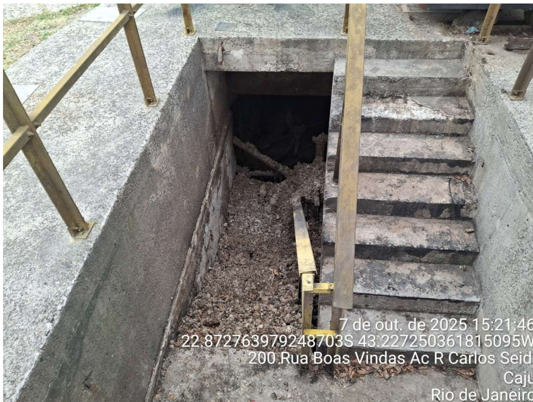
Foto 4 – Acesso ao interior do gradeamento destruído.
