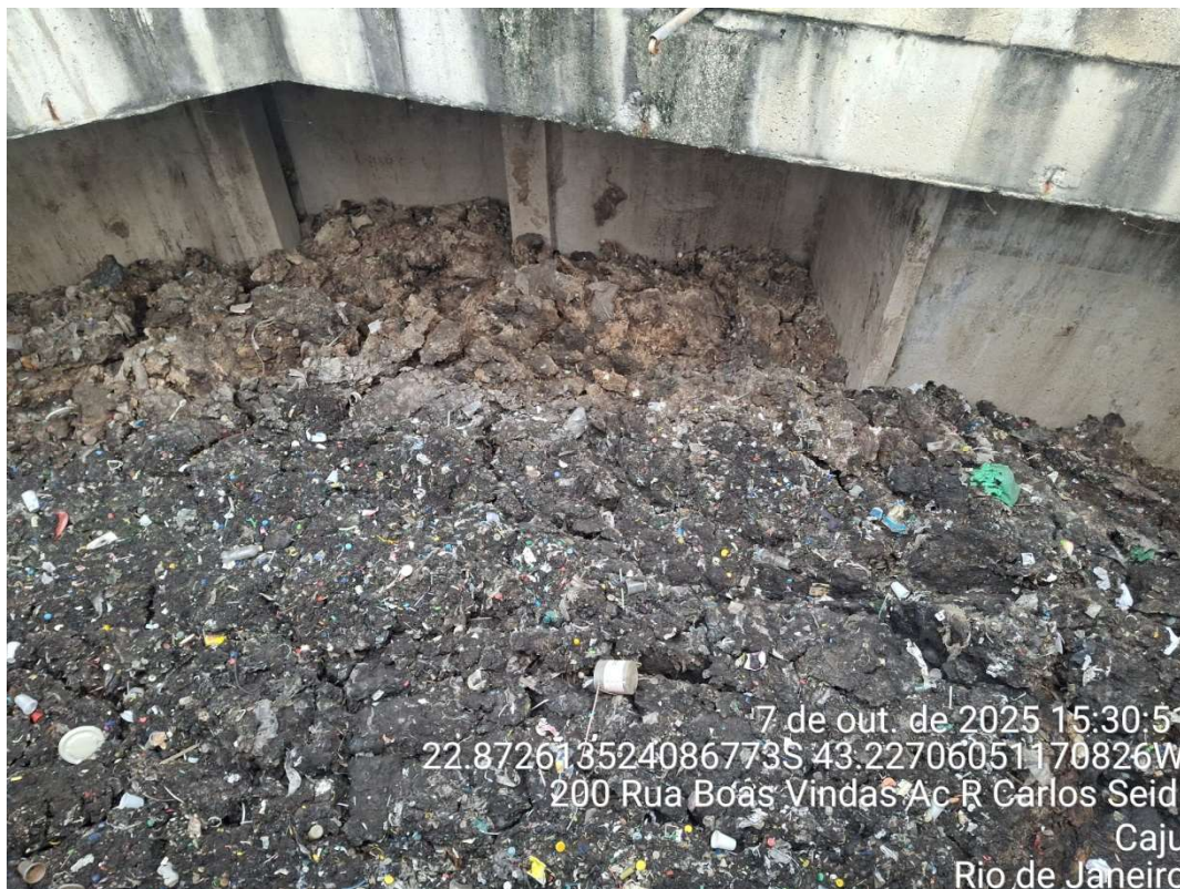
Foto 5 – Acúmulo significativos de resíduos no poço de sucção. Impossibilidade de visualização do esgoto bruto líquido direcionado à Estação de Elevatória.
