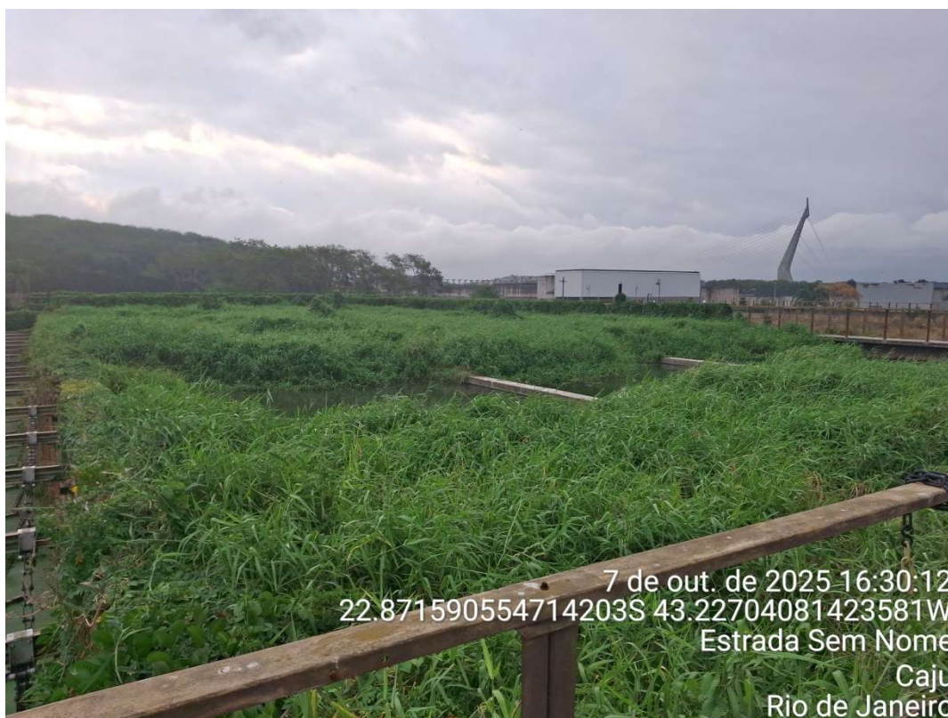
Foto 17: Presença de vegetação densa, indicativo de total abandono.
