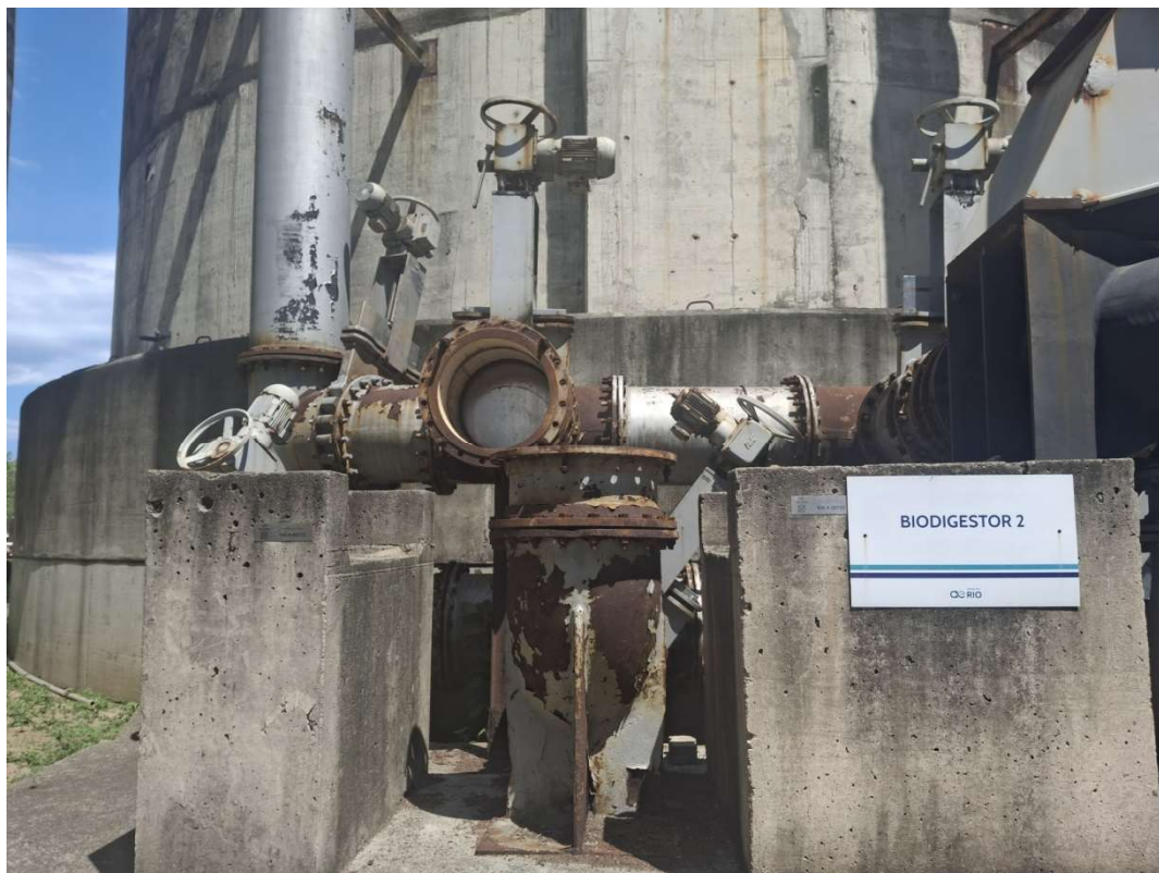
Foto 50: Estruturas em estado avançado de degradação.
