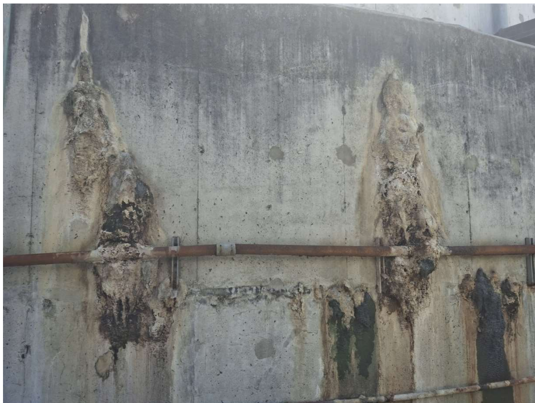
Foto 52: Estruturas do biodigestor em estado avançado de degradação.
