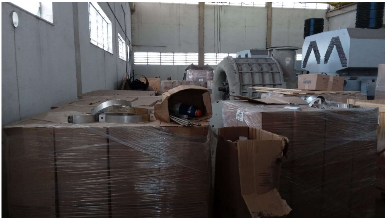
Foto 60: Materiais dispostos de forma inadequada na casa de sopradores.
