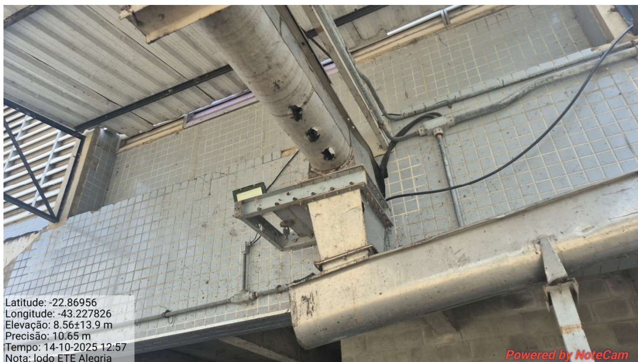
Foto 56: Calha de transporte do lodo deteriorada com aberturas (furos) na zona inferior.
