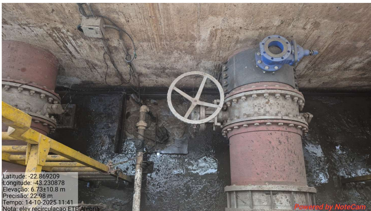
Foto 35: Acumulo de lodo que vazou na parte inferior da estrutura.
