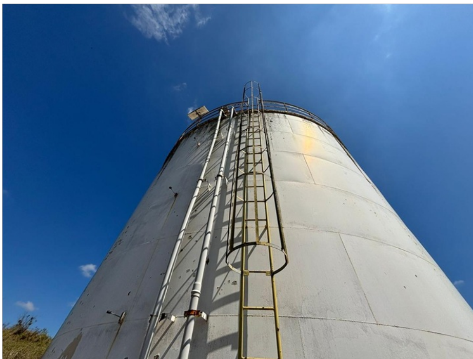
Foto 06 – Ausência de placa de identificação.
