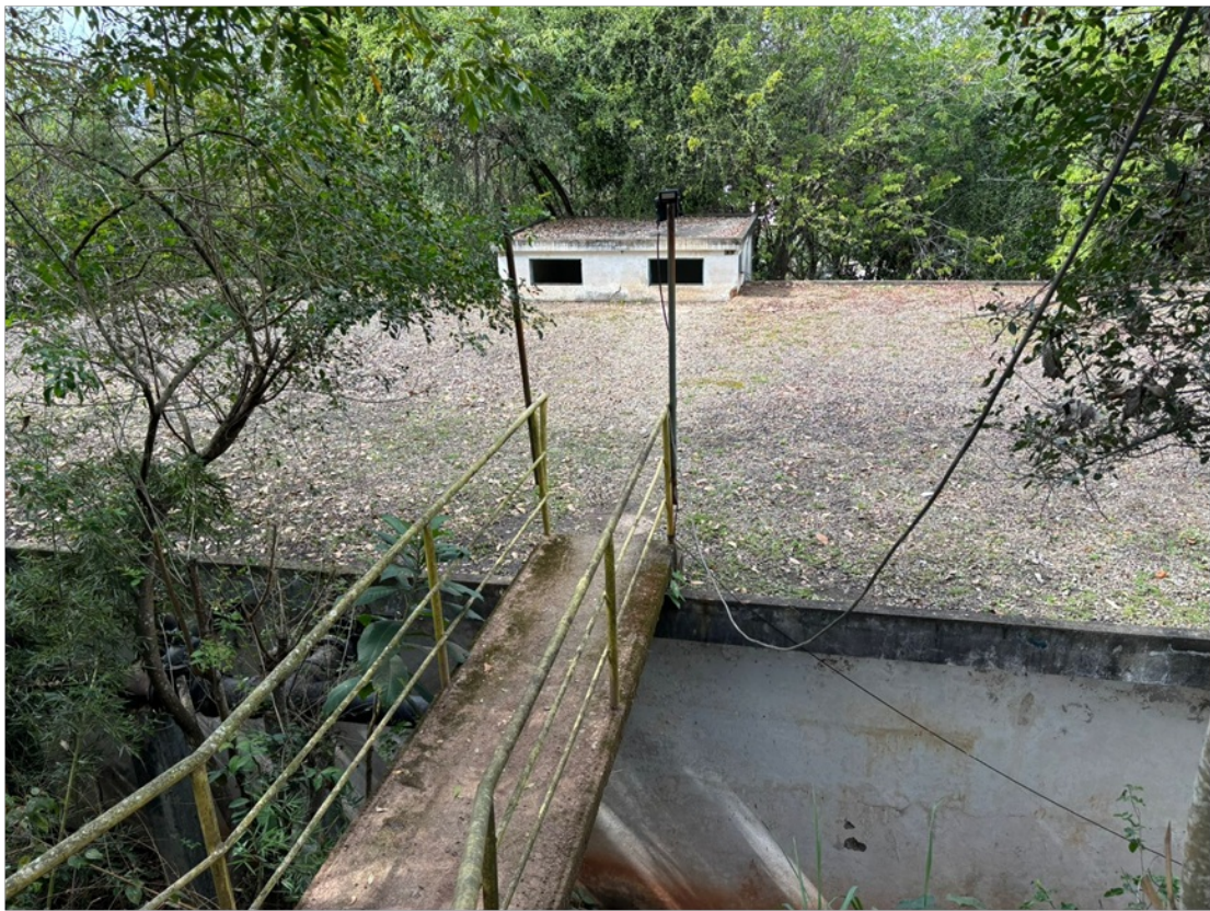
Foto 10 - Sistema de ventilação sem tela de proteção e vegetação crescida ao redor.
