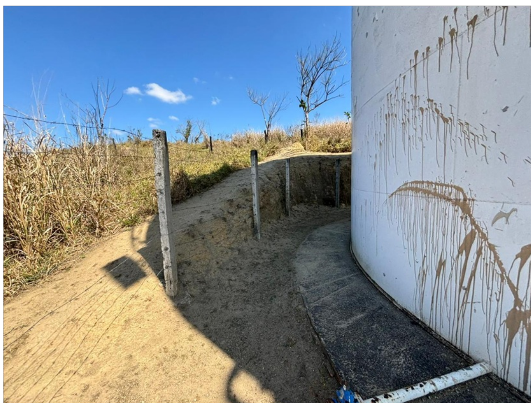
Foto 05 – Necessita de reforma no cercamento e revitalização da pintura.
