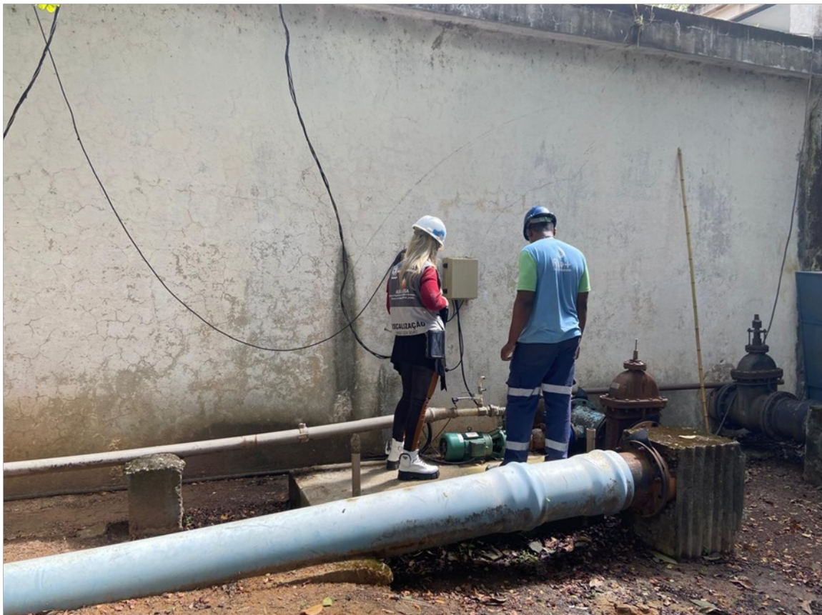
Foto 11 – Cabos que alimentam o Pannel elétrico do sistema de Booster dependurado na parede sem nenhuma proteção.
