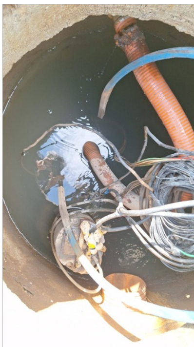
Foto 5 – Vista interna do poço da EEE Kite Surf.
