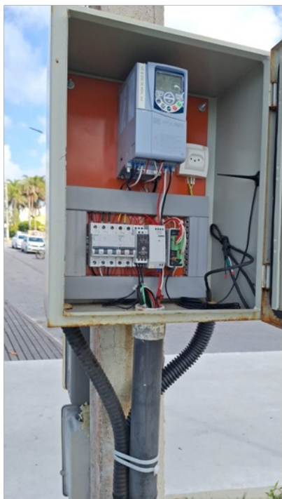
Foto 6 – Vista interna do quadro elétrico da EEE com o inversor de frequência.
