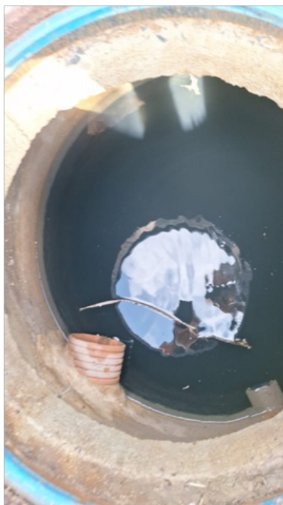
Foto 4 – Caixa de areia da EEE.
