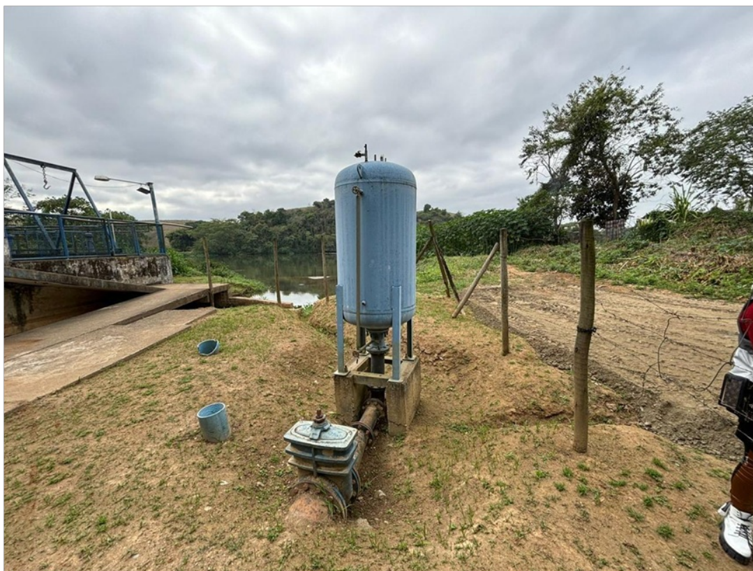
Foto 03 –TAU (Tanque de Amortecimento Unidirecional ), um dispositivo capaz de absorver o golpe de aríete gerado pela oscilação brusca do bombeamento da água, encontra-se fora de operação por falta de manutenção.
