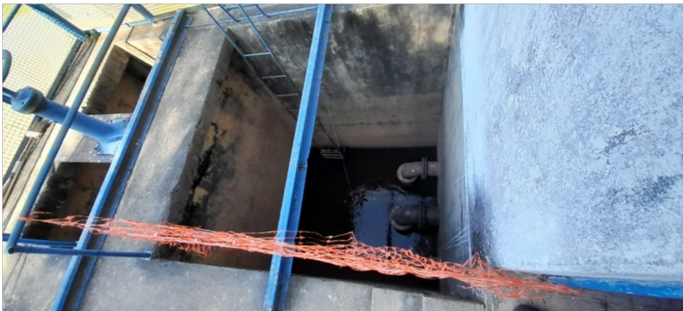
Foto 06 - Poço de sucção sem guarda-corpo.
