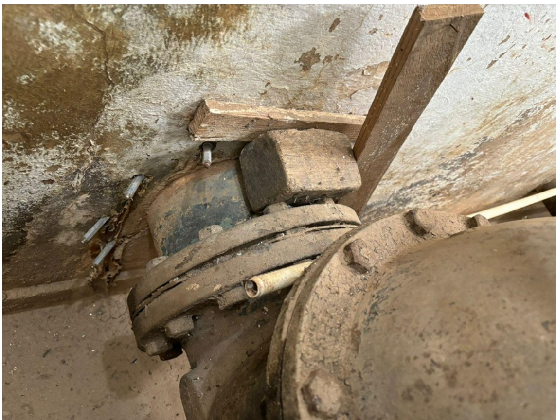
Foto 11 – Detritos de madeira e pedaços de tubos sobre a linha de recalque.
