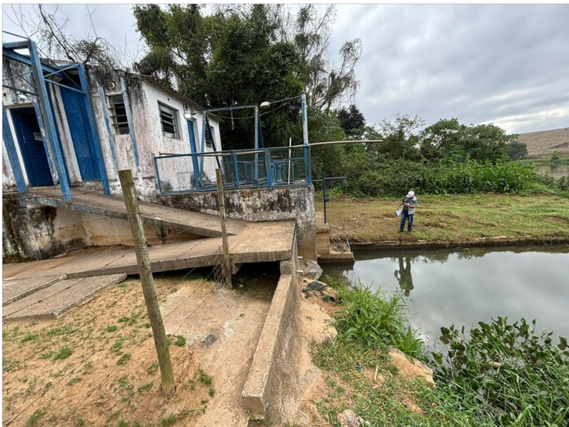
Foto 08 - Rampas de acesso a sala que recepciona os extintores de incêndio sem guarda- corpo.
