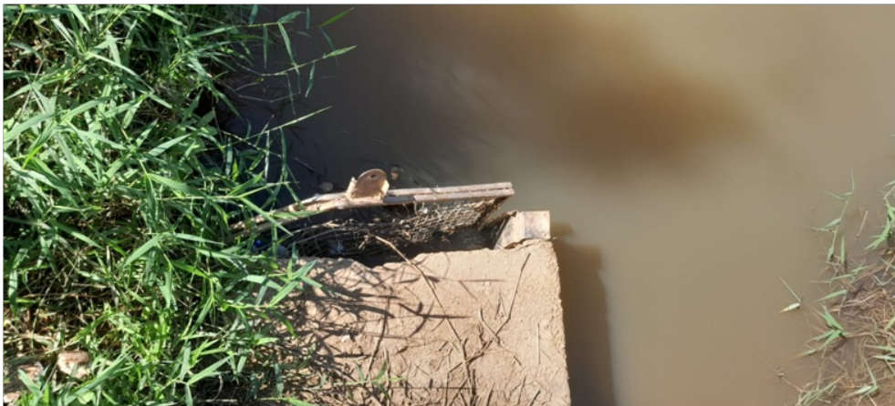
Foto 07 - Sistema de gradeamento precário.
