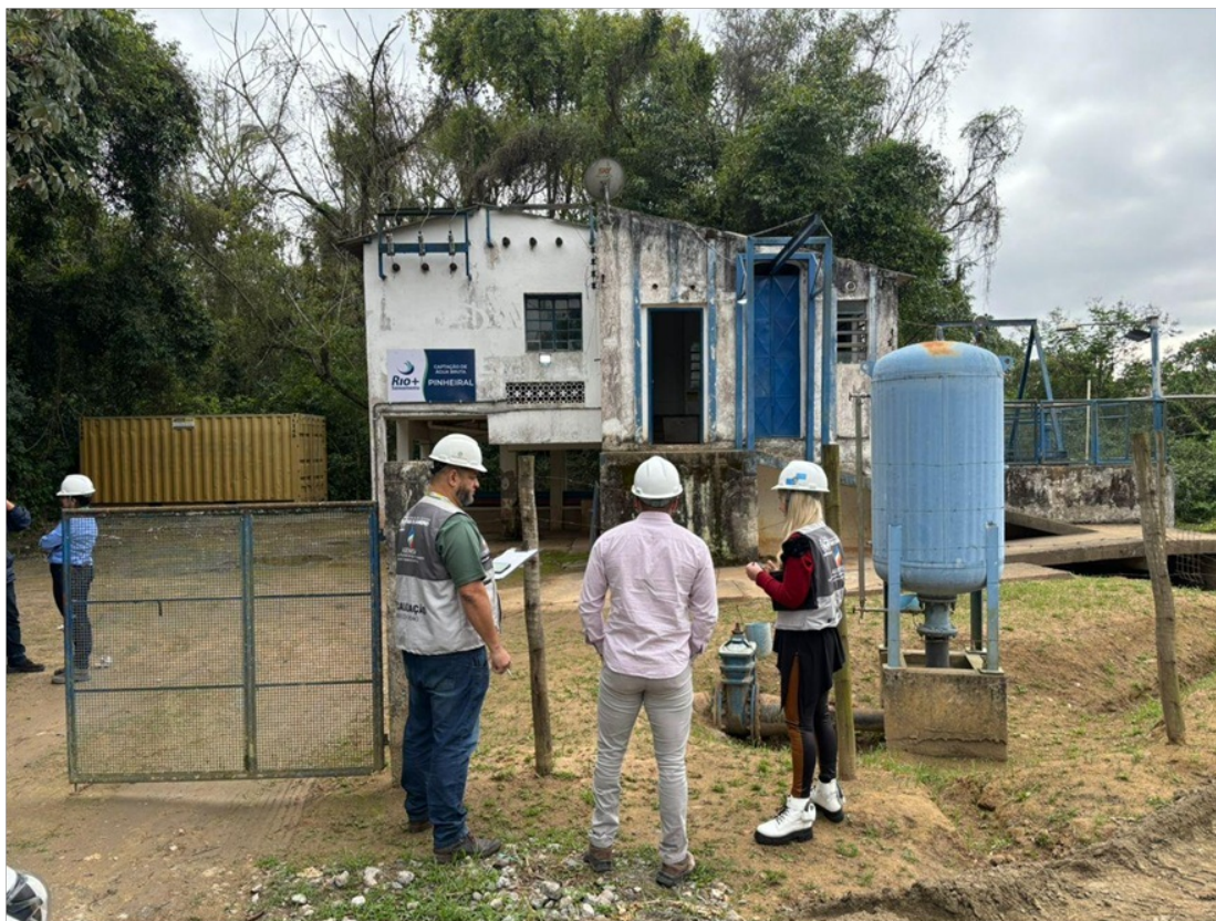
Foto 02 - Estação Elevatória necessita de reforma geral, inclusive revitalização da pintura.
