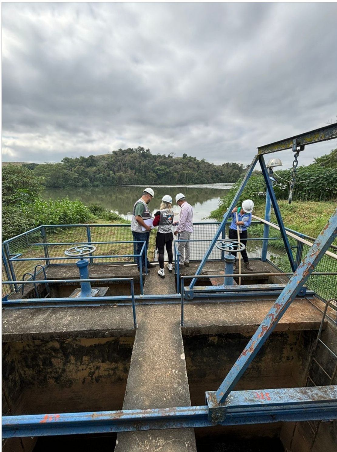
Foto 09 – Passarela sobre a câmara de sedimentação de areia ( desarenador ) sem guarda-corpo.
