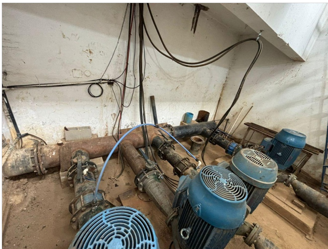
Foto 05 – Sala de bombas, com cabos dependurados nas paredes.
