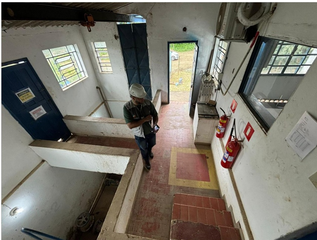
Foto 04 – Extintores de incêndio.
