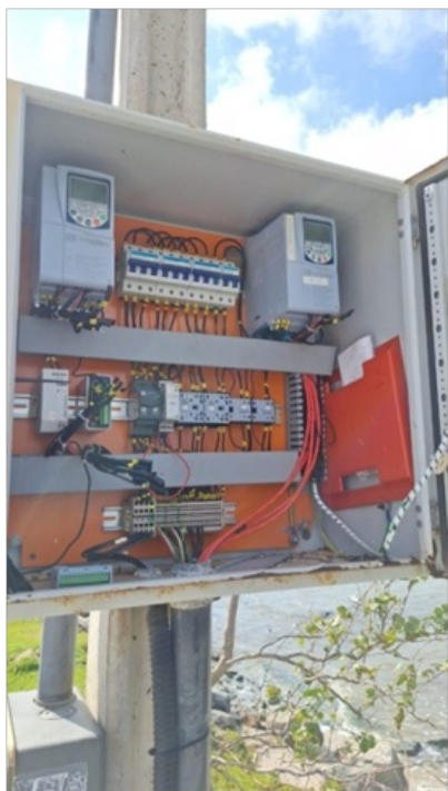
Foto 3 – Vista interna do quadro elétrico da EEE com o inversor de frequência.
