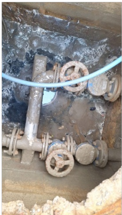
Foto 4 – Barrilete da EEE.
