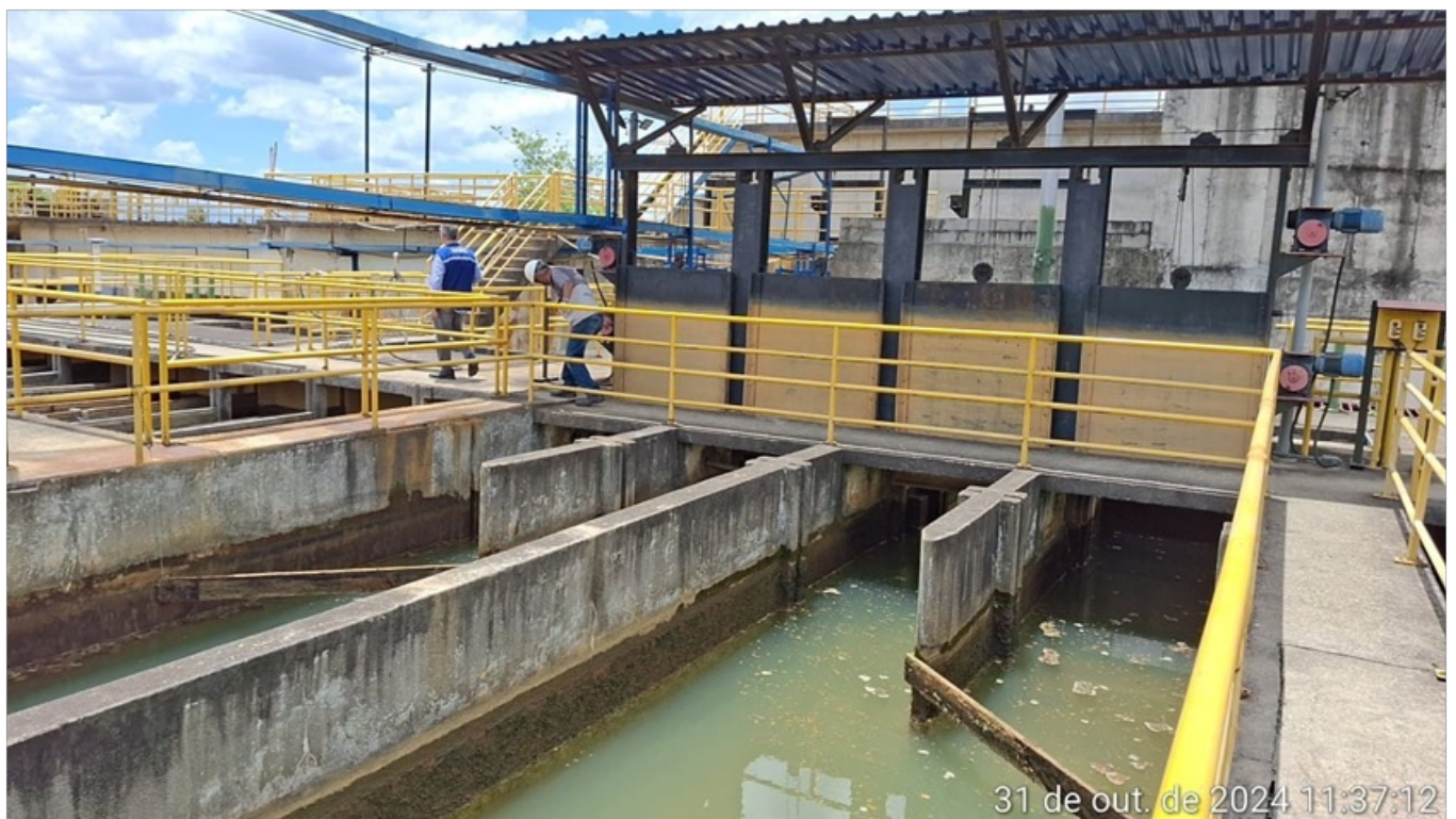
Foto 11 – Comportas canal chegada água bruta
