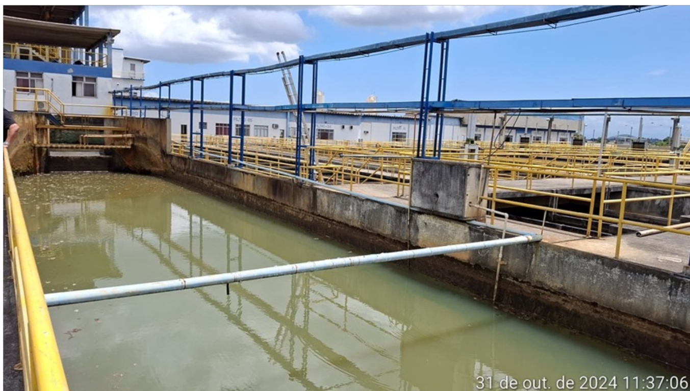
Foto 12 – Canal de chegada água bruta
