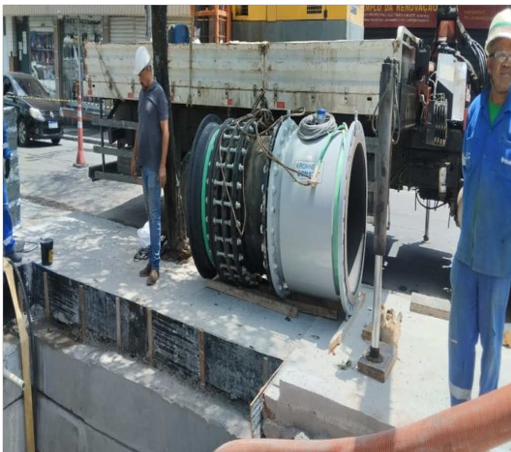
Foto 2 – Macro medidor 4ª linha adutora DN1000
