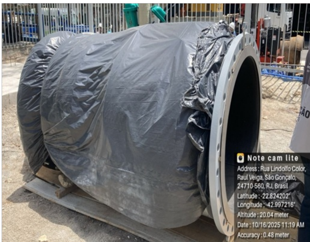
Foto 4 - Macro medidor 5ª linha adutora DN1000
