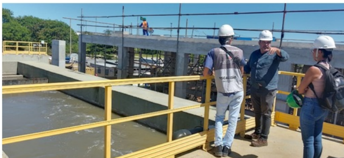
Foto 5 e 6 - Calha Parshaal com medidor de vazão eletrônico; Desarenador com o pipe-rack ao fundo.
