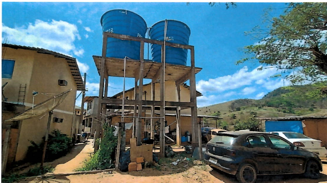
Foto 1: Reservatório Flor de Liz Superior – área desprovida de cercamento.
