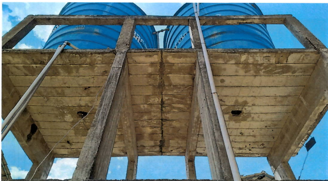
Foto 2: Estrutura de concreto necessitando de reformas.
