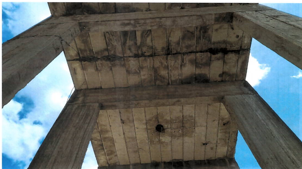
Foto 3: Estrutura de concreto necessitando de reformas.
