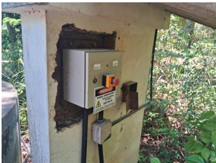
Foto 6: Vista externa do painel elétrico de acionamento das bombas do poço de captação.
