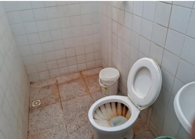
Foto 25: Vista do banheiro da ETA, que apresentava necessidade de melhoria nos equipamentos sanitários.
