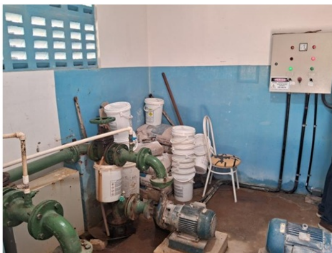
Foto 15: Vista geral da Casa de Bombas. Nota-se vazamento intenso na válvula de bloqueio e armazenamento inadequado de produtos químicos.
