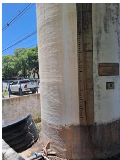
Foto 23: Tanque de armazenamento do coagulante. Nota-se resíduos ao longo do tanque de contenção.
