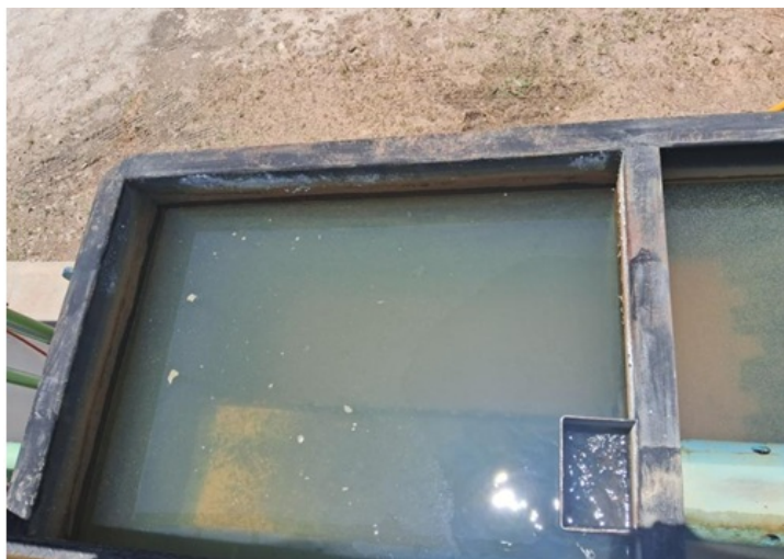
Foto 11: Vista superior do tanque de filtração. Nota-se que a água decantada está com grande turbidez, indicando possibilidade de ineficiência no processo e sobrecarga do filtro.
