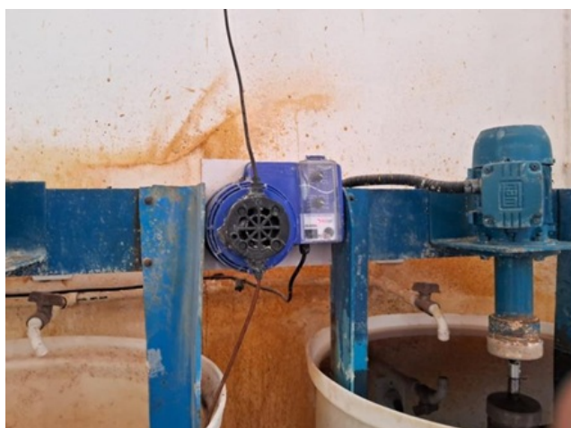
Foto 20: Detalhe do sistema de controle da aplicação de coagulante.
