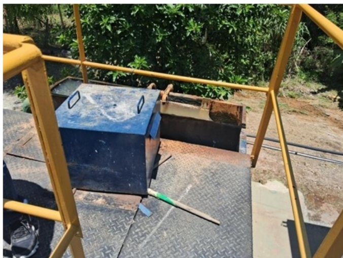
Foto 9: vista da caixa de proteção do motor da floculação mecânica .
