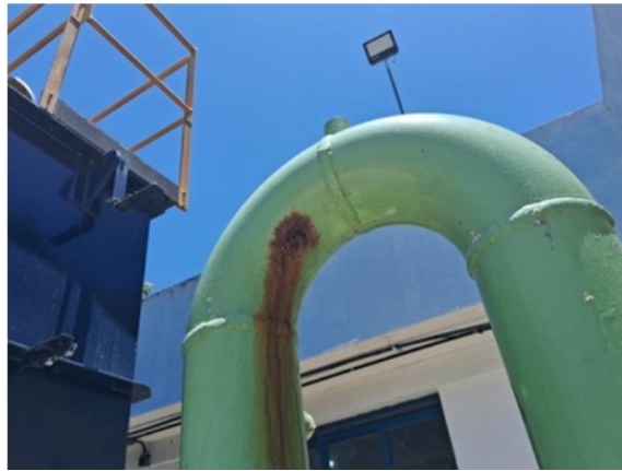
Foto 17: Tubulação de recalque danificada.
