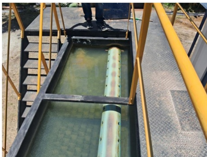
Foto 10: vista superior do tanque de decantação. Nota-se grande quantidade de flocos suspensos, indicando possibilidade de ineficiência no processo.
