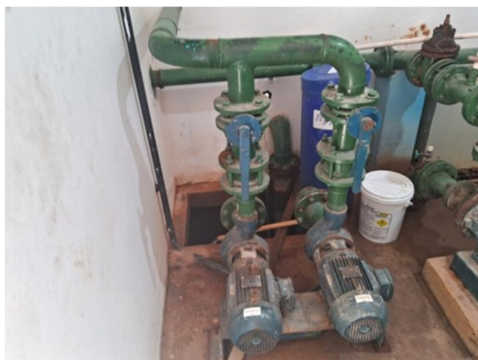
Foto 12: Conjuntos motobombas da retrolavagem.
