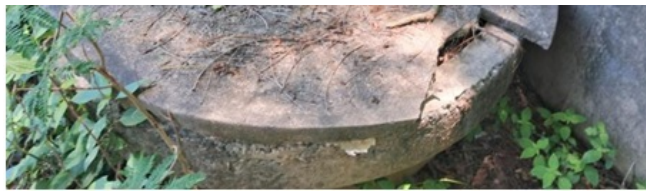
Foto 2: Vista da caixa do registro da tubulação de tomada d'água, que apresenta tampa danificada.
