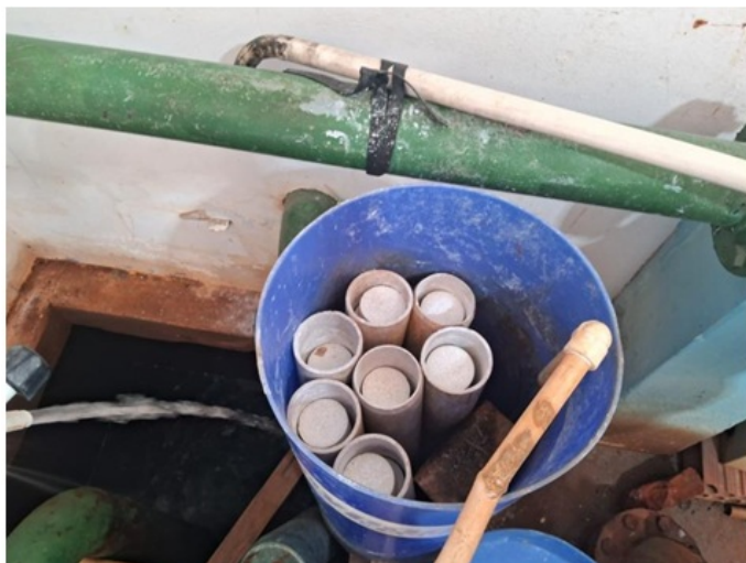
Foto 14: Vista interior do sistema de aplicação de cloreto de cálcio em pastilhas.
