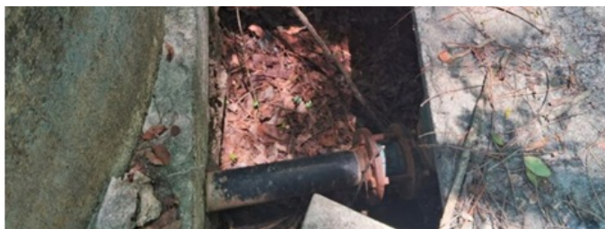
Foto 5: caixa do barrilete após o poço de captação necessitando reparos e limpeza.
