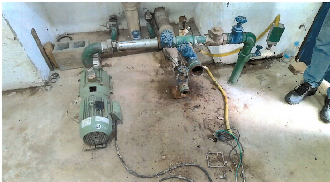
Foto 4 : Bombas de 5 cv da EEAT (ausência de bomba reserva).
