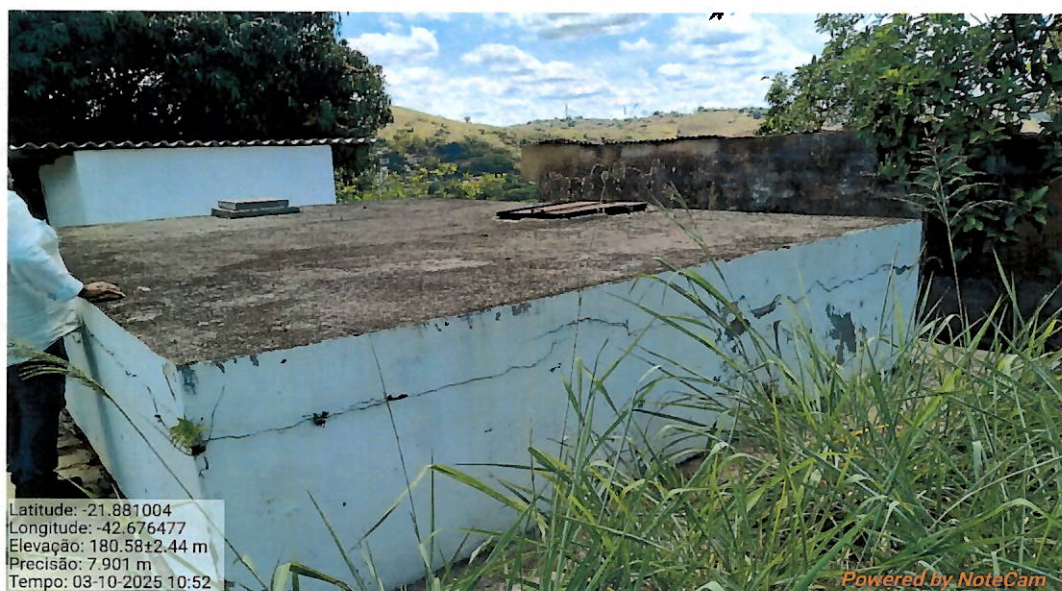
Foto 2: Reservatório Flor de Liz – ausência de medidor de nível.
