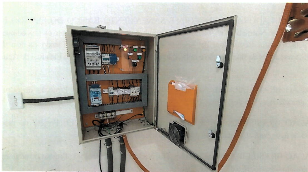
Foto 5 : Painel elétrico das bombas.
