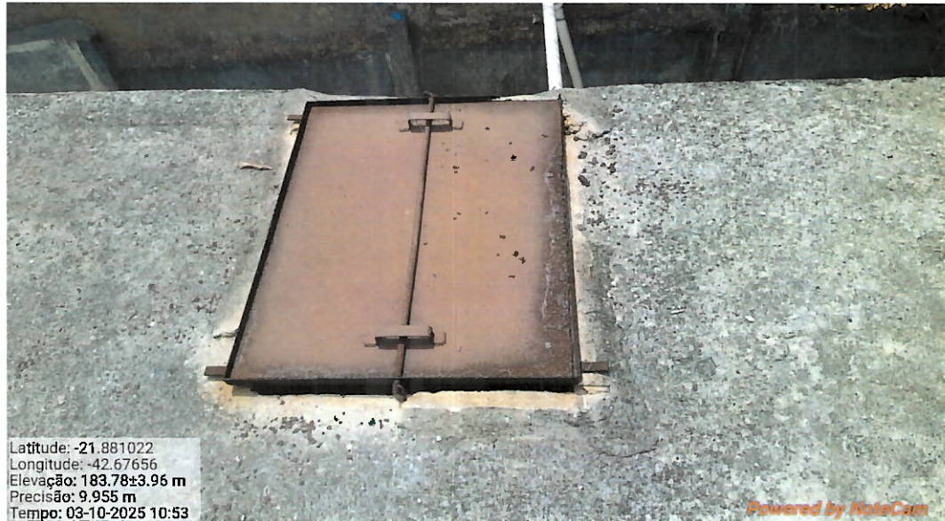
Foto 3: Tampa de inspeção não estanque.
