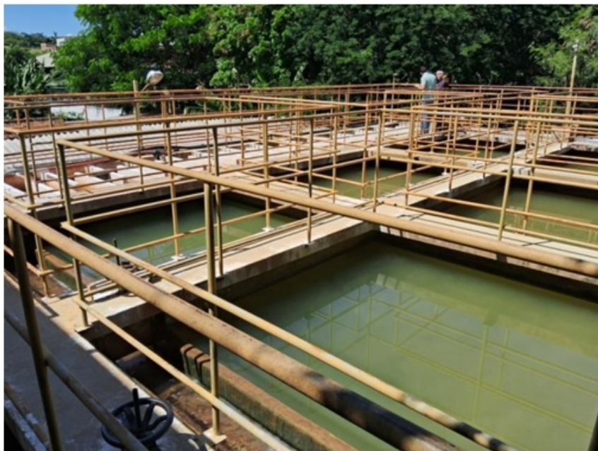
Figura 9: Tanques de decantação.
