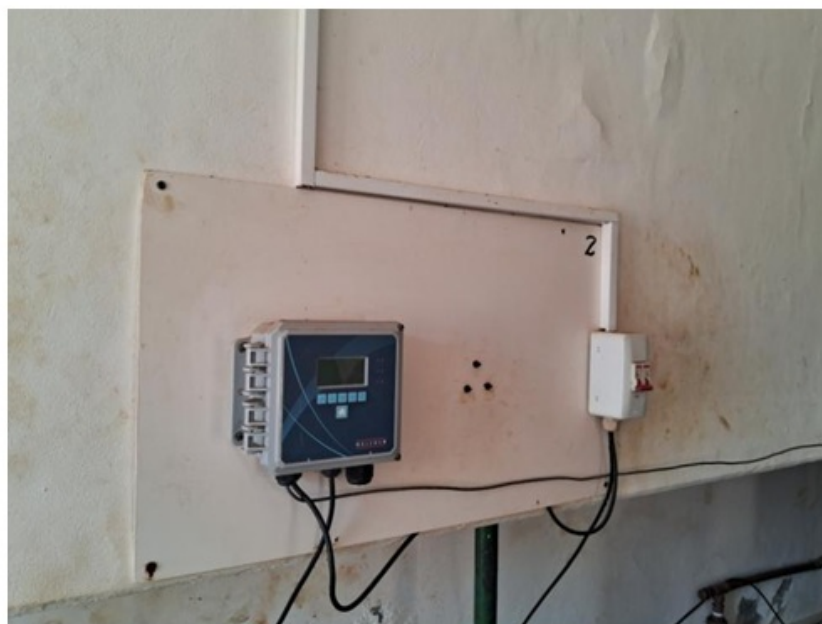
Figura 16: vista do sistema automatizado de medição e controle da dosagem do cloro. Esse sistema estava inoperante e aguardava conserto por empresa terceirizada.
