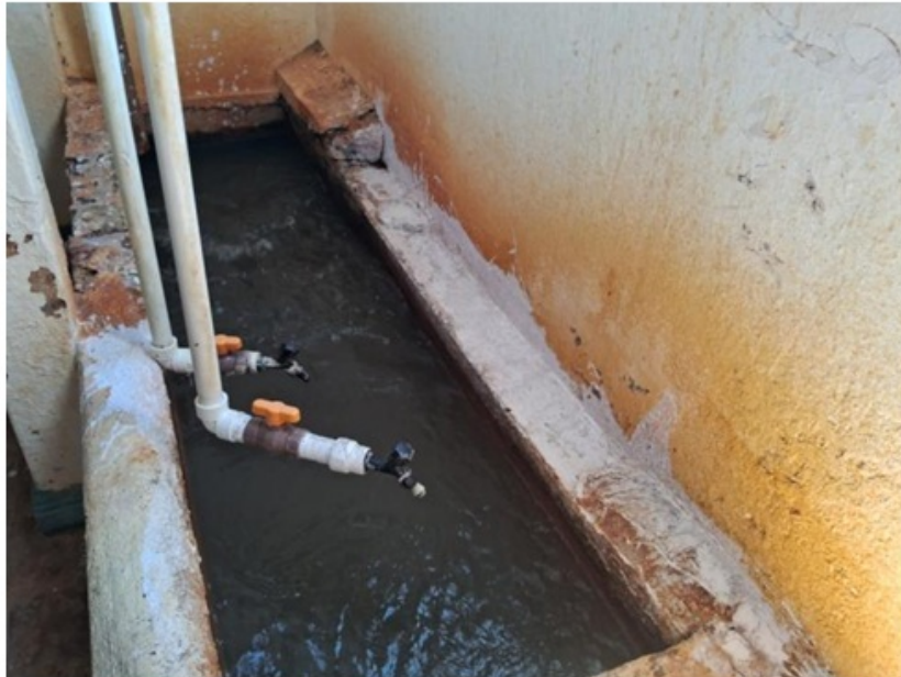
Foto 5: Entrada da água bruta no processo de tratamento e ponto de aplicação do coagulante. Nota-se que a parede do canal está deteriorada.
