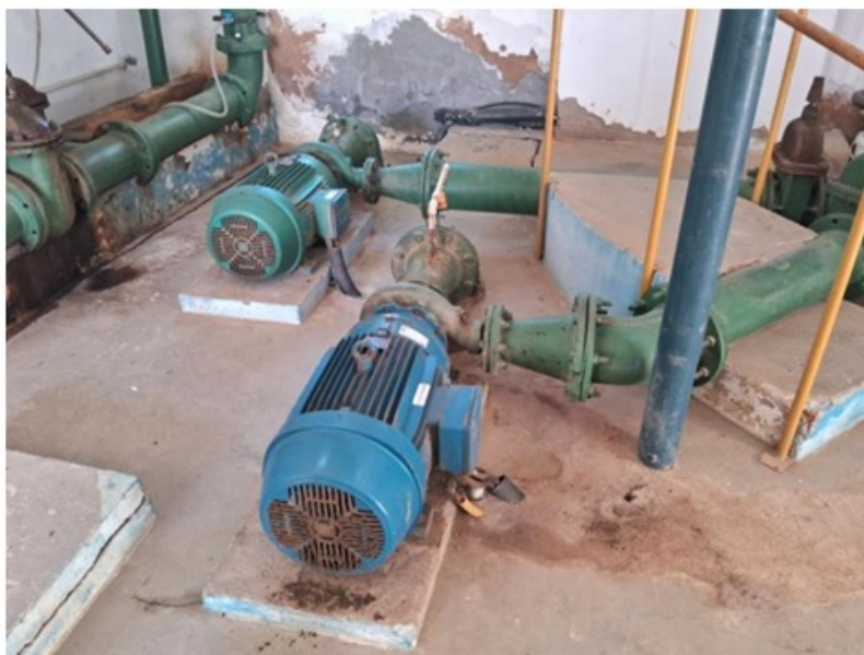
Figura 19: vista dos conjuntos motobombas e barrilete da elevatória de distribuição.
