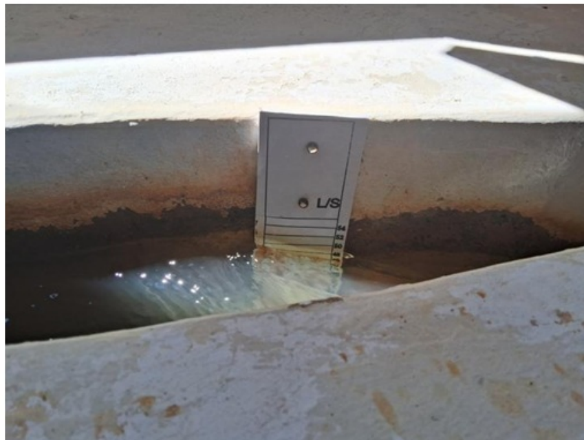
Foto 7: escala fixada na Calha Parshall para monitorar a vazão.
