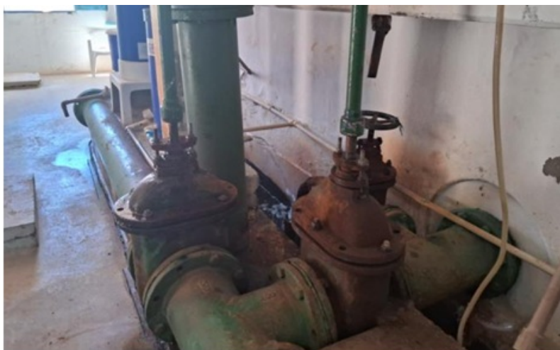
Figura 13: Vista do barilete dos filtros. Nota-se vazamento em um dos registros.
