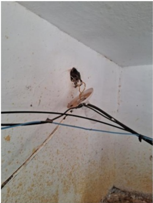
Figura 26: instalação elétrica inadequada da área de armazenamento de coagulante.
