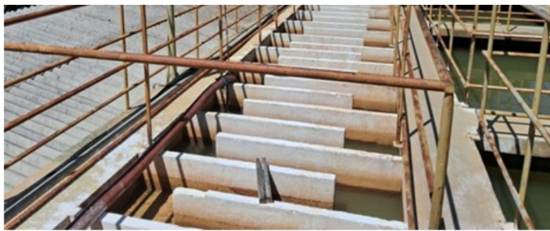
Figura 8: Tanque de floculação, vista de montante para jusante.
