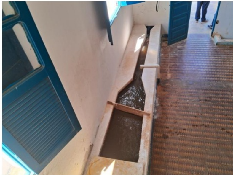
Foto 6: vista superior da Calha Parshall usada no processo de coagulação e de medição da vazão.
