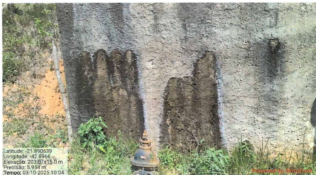
Foto 4 : Ponto de infiltração do reservatório.
