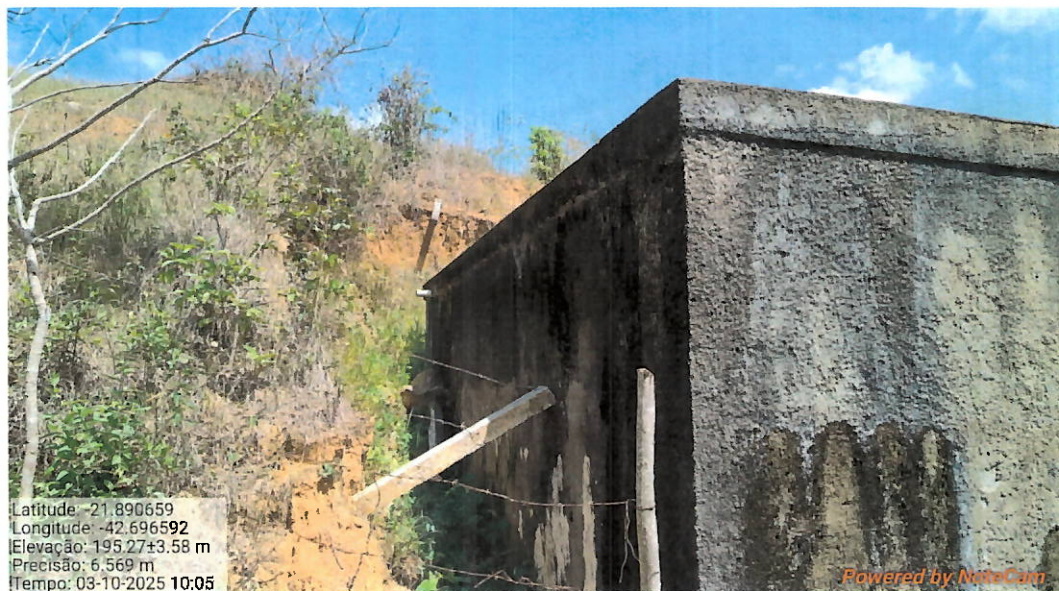
Foto 3: Vista lateral – cerca na lateral do reservatório.
