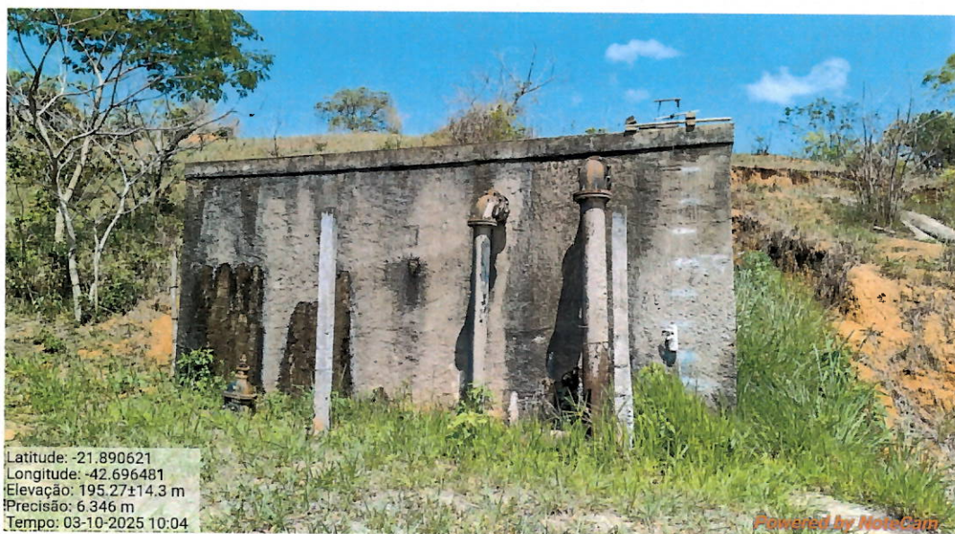
Foto 2: Vista frontal – ausência de cerceamento adequado, ausência de identificação da unidade, ausência de escada com gaiola, ausência de medidor de nível, ausência de guarda-corpo e ausência de SPDA.
