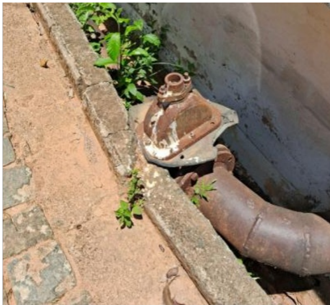
Foto 6: válvula de bloqueio sem haste e volante.
