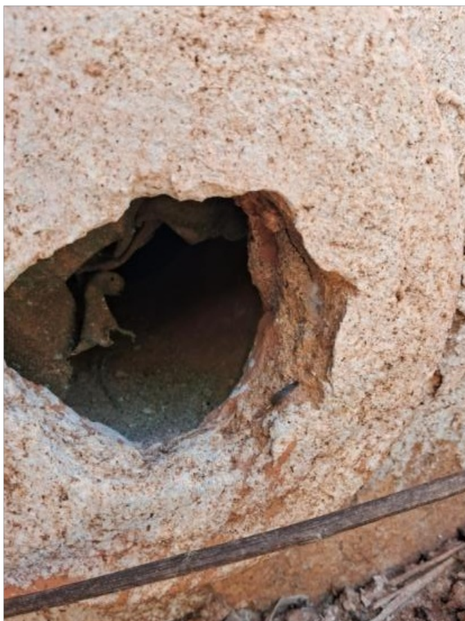
Foto 5: Orifício sem vedação adequada na parede do reservatório.
