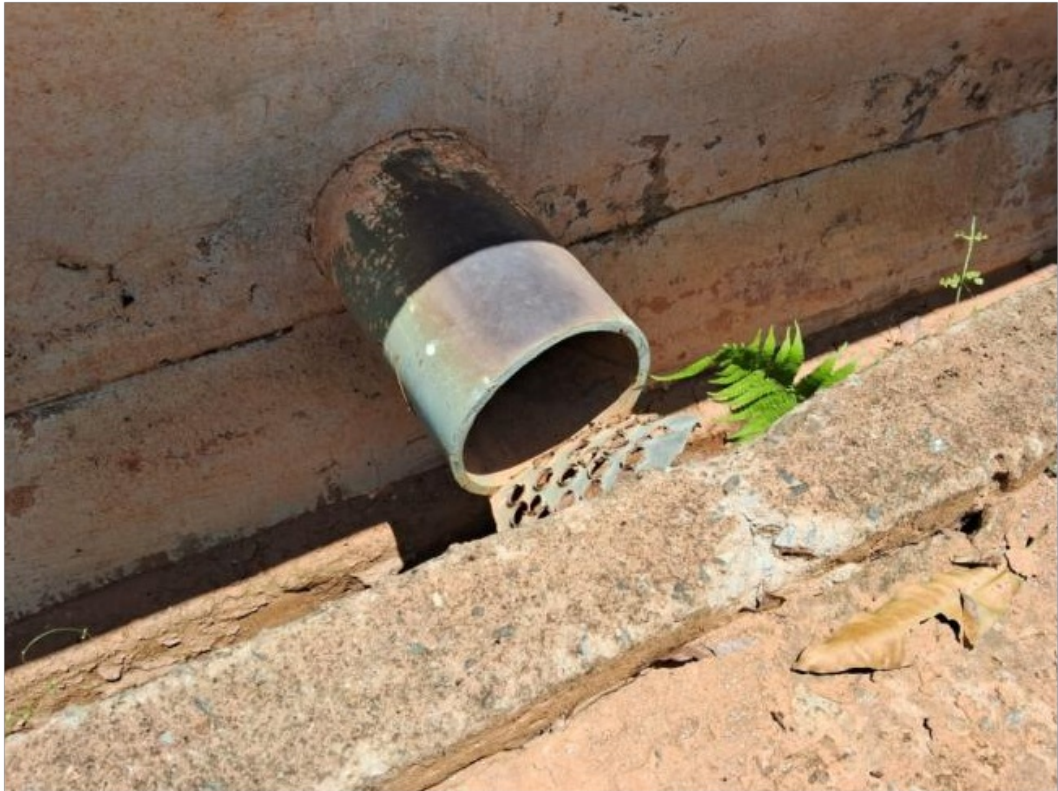
Foto 8: tubulação de extravasamento sem tela de proteção.
