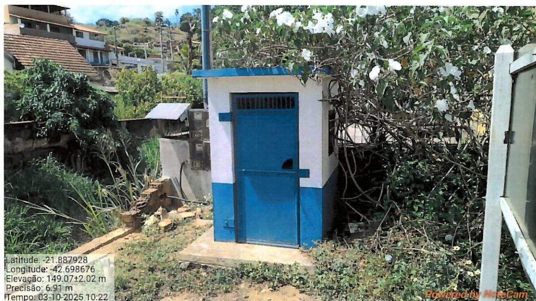
Foto 7: Abrigo dos painel elétrico da bomba.
