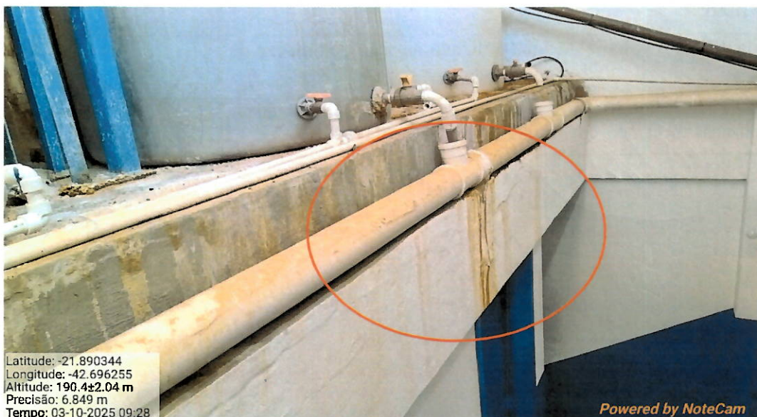
Foto 31: Indícios de escoamento do produto pela parede.
