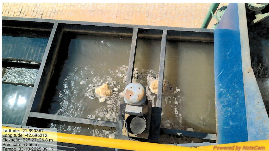
Foto 12: Floculador mecânico - ETA Nova.
