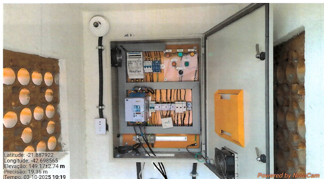
Foto 8: Painelelétrico da bomba
