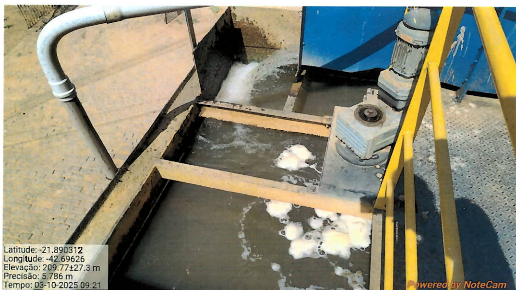
Foto 16: Floculador – ETA Velha.
