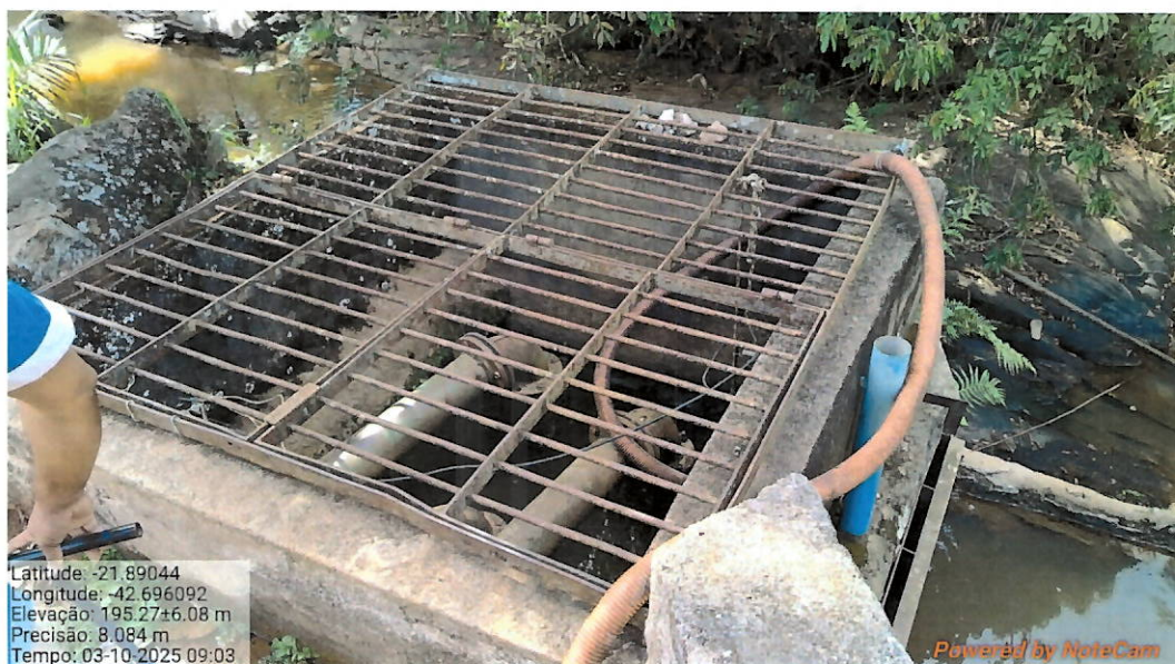
Foto 3: Ponto de captação - gradeamento superior.
