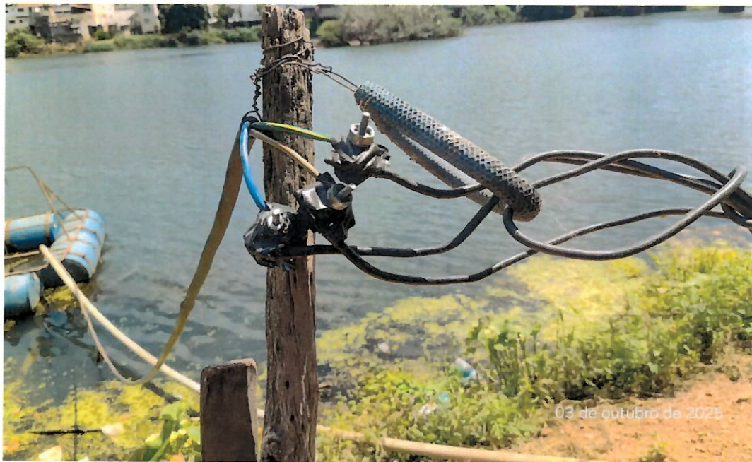
Foto 5: Fiação elétrica exposta .
