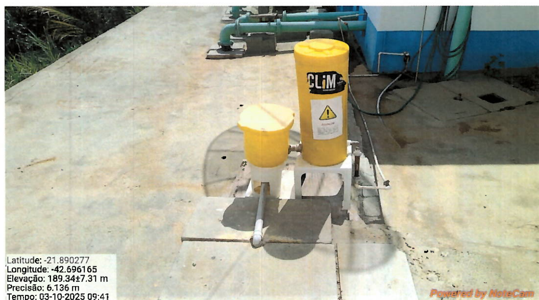
Foto 19: Sistema de cloração com hipoclorito de cálcio sobre o tanque de contato de 80 m 3 (tampa não estanque).
