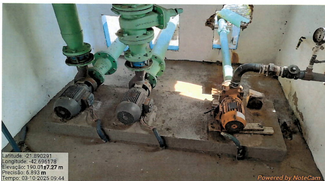
Foto 24: Conjuntos motobombas de retrolavagem dos filtros.
