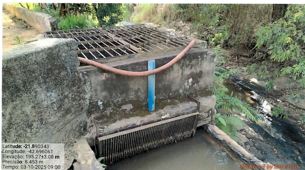
Foto 2: Ponto de captação - gradeamento lateral.
