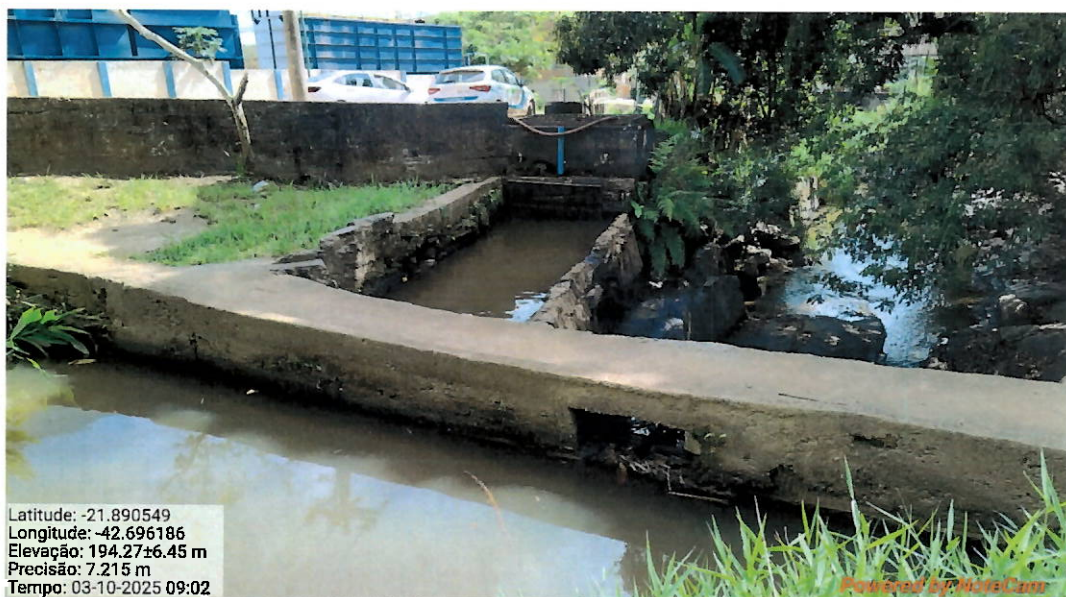
Foto 1: Ponto de captação – Córrego do Cortiço (ausência de proteção e placa de identificação do manancial, com aviso indicando que o mesmo é utilizado para o abastecimento humano) .
