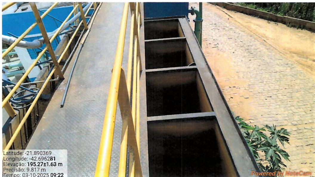
Foto 18: Filtros – ETA Velha.
