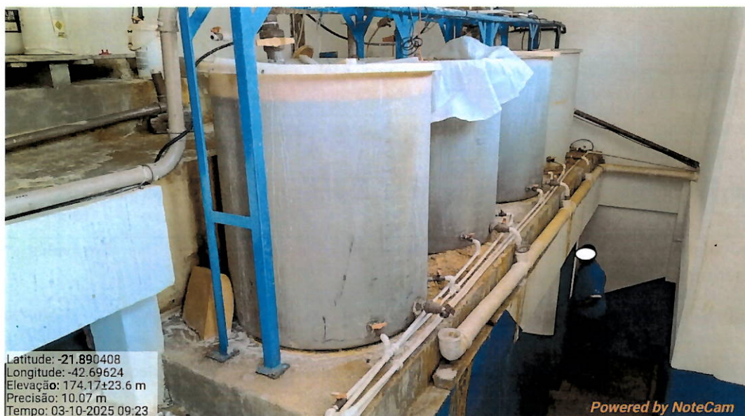
Foto 30: tanques de armazenamento sulfato de alumínio sem bacia de contenção.
