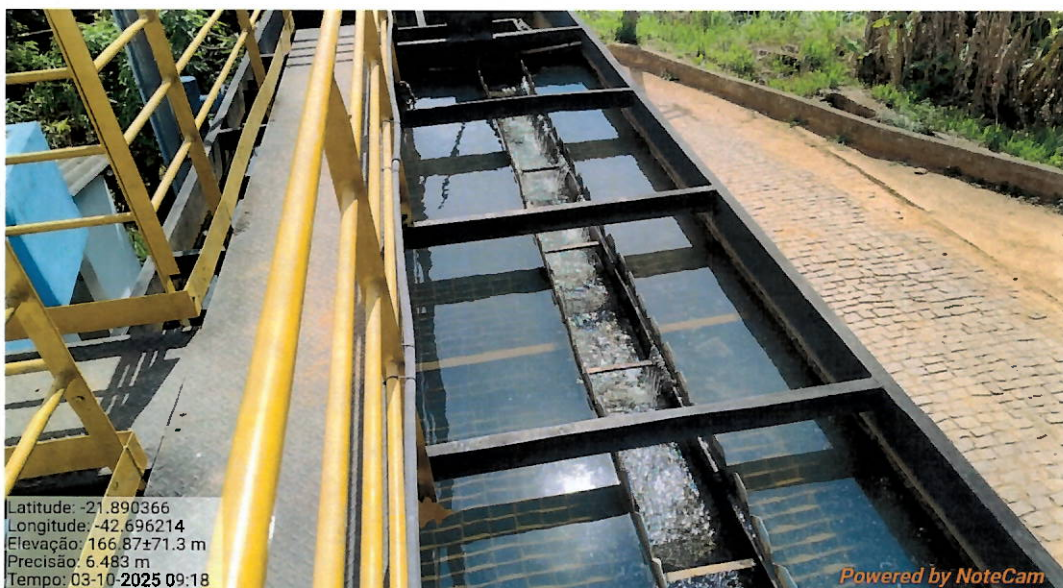
Foto 13: Decantador – ETA Nova.
