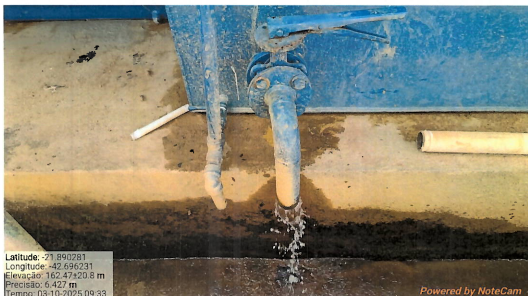
Foto 22: Registro sem vedação adequada.
