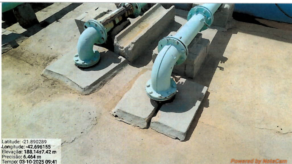
Foto 20: Tampa não estanque sobre tanque de contato.
