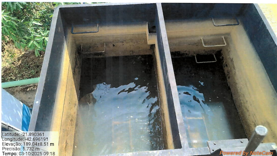
Foto 14: Filtros – ETA Nova.
