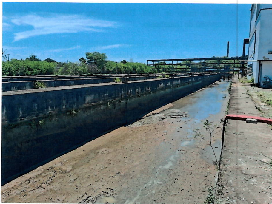
Foto 14: Vista de um dos canais do desarenador. Nota-se grande quantidade de material sedimentado, contudo a retirada desse material não faz parte do escopo da parada.
