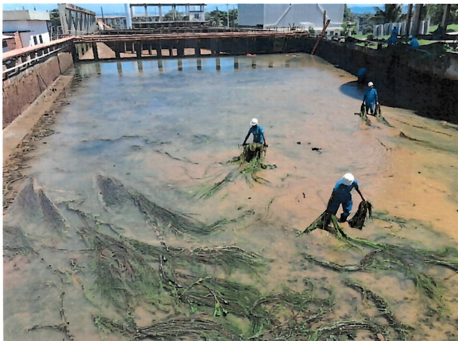
Foto 4: Equipe retirando vegetação do tanque de tranquilização. Não havia uso de luvas por parte dos trabalhadores e um deles não possuía bota de cano alto.
