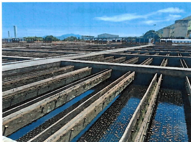
Foto 1: Vista dos tanques de decantação da NETA. Não foi verificada equipe executando limpeza dos canais de água decantada embora esse serviço estivesse no Cronograma da Parada.
