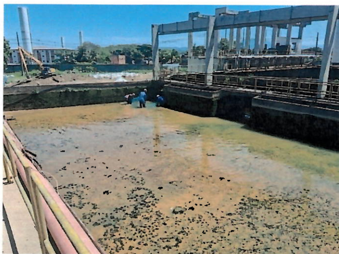
Foto 2: Tanque de coagulação da NETA. Equipe realizando limpeza. Nota-se uma grande quantidade de musgo e outros vegetais nas paredes do tanque, contudo a limpeza das paredes não estava prevista no Cronograma da Parada.
