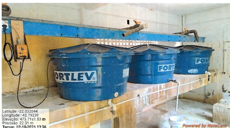
Foto 17: tanques de armazenamento sulfato de alumínio sem bacia de contenção .
