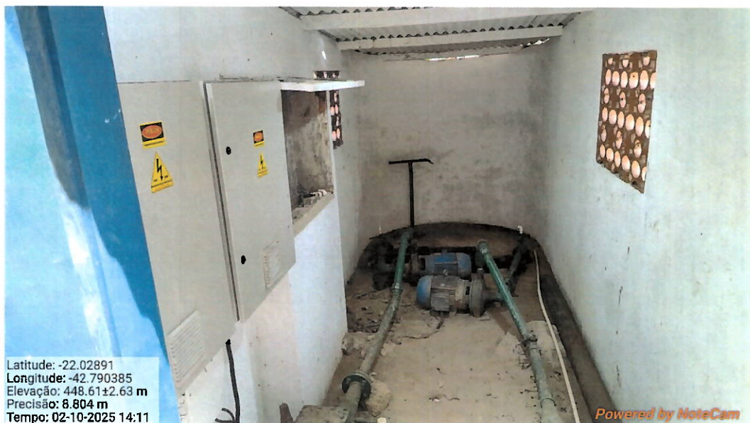
Foto 3: Painéis elétricos e bombas da unidade de captação (10 cv cada).
