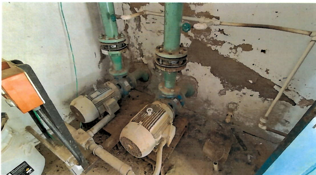
Foto 12: Conjunto de bombas da EEAT (potência de 15 cv cada).
