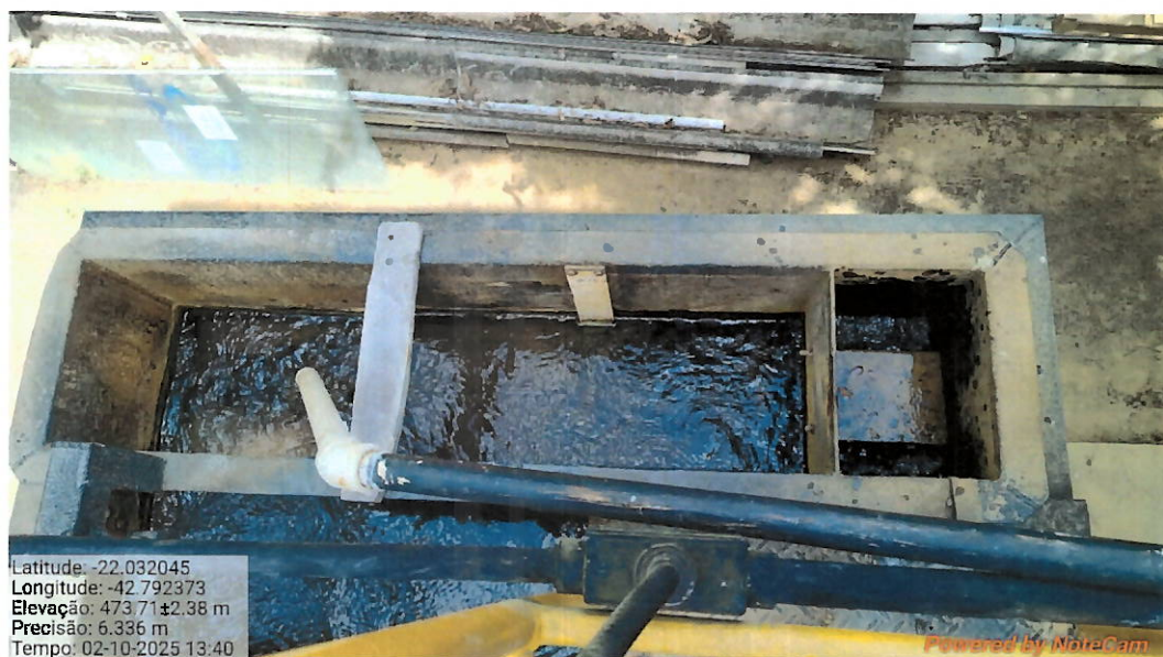
Foto 6: Entrada de água bruta na ETA com aplicação de coagulante sulfato de alumínio.
