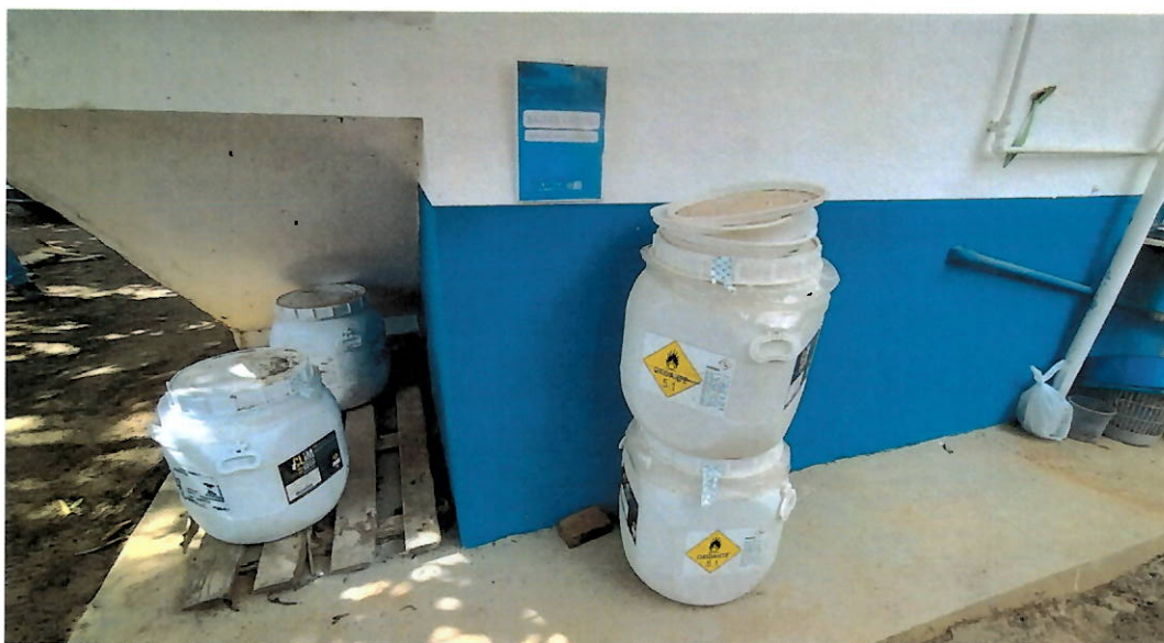
Foto 16: Armazenamento inadequado de hipoclorito de cálcio.
