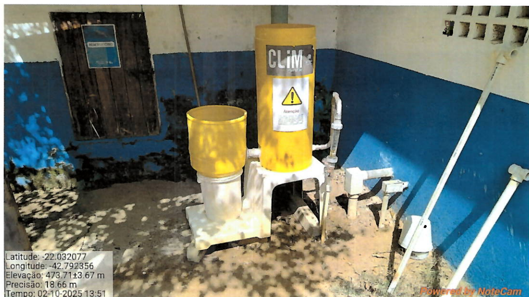
Foto 10: Sistema de cloração.
