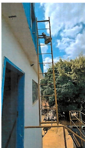
Foto 18: escada sem gaiola de proteção.
