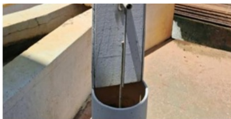
Foto 9: Dispositivo de medição de vazão da água bruta. Não convencional. Fora de padrão
