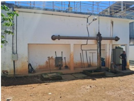
Figura 39: vista das tubulações e válvulas de descarga dos tanques de floculação e decantação. Nota-se ausência de tampas nas caixas das válvulas.
