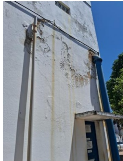
Foto 6: parede externa próxima ao canal de coagulação com marcas de infiltração.
