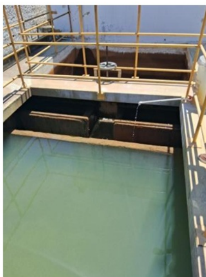
Foto 13: passagem da água decantada para a filtração. Notas-se a aplicação de pré-clororação nessa transição.
