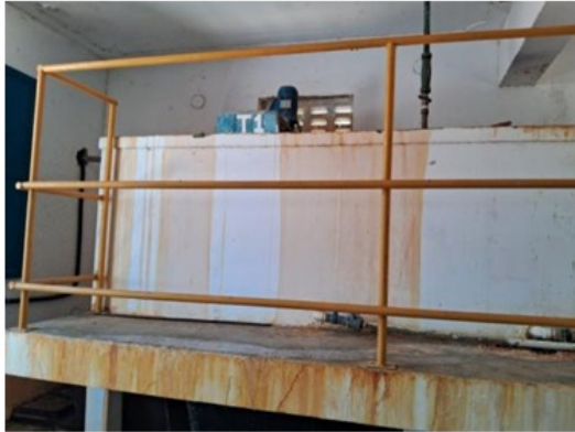
Figura 29: tanques de alvenaria com agitadores para uso do sulfato de alumínio.
