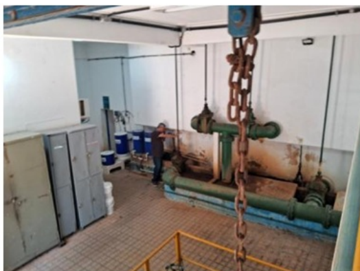
Figura 23: vista da parte superior do tanque de contato / reservatório, barrilete dos filtros e do sistema de desinfecção.
