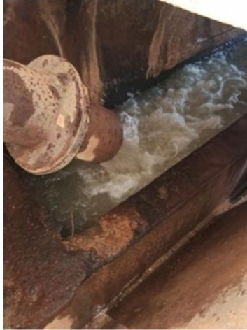
Foto 5: Entrada da água no canal de coagulação. Nota-se parede deteriorada e respingos de água para fora do canal.
