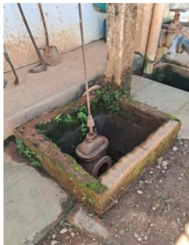
Figura 40: detalhe da caixa de válvula de descarga sem tampa e necessitando limpeza.
