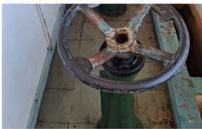
Figura 15: Área de manobra de um dos filtros. Nota-se ausência de proteção no vão de inspeção da água filtrada.
