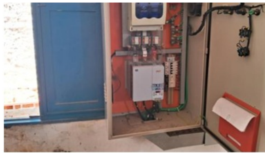
Figura 28: vista interna do quadro elétrico de acionamento das bombas de distribuição.
