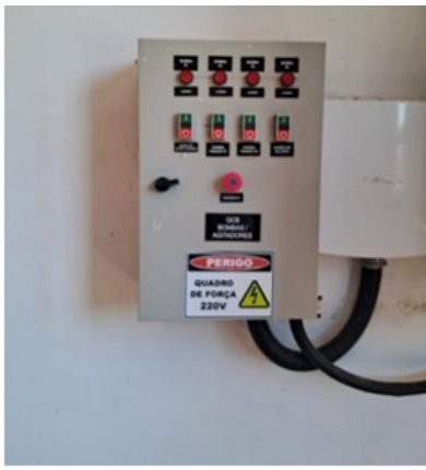
Figura 27: vista externa do quadro elétrico de acionamento das bombas de distribuição.
