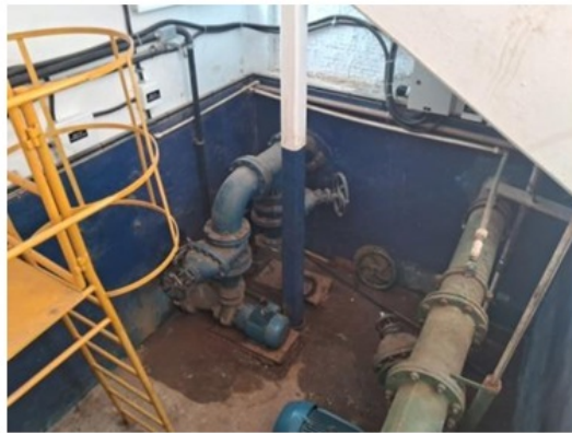
Figura 26: vista dos conjuntos motobombas e barrilete de uma das elevatórias de captação que trabalha afogada. Notam-se vazamentos e ausência de conjunto reserva.
