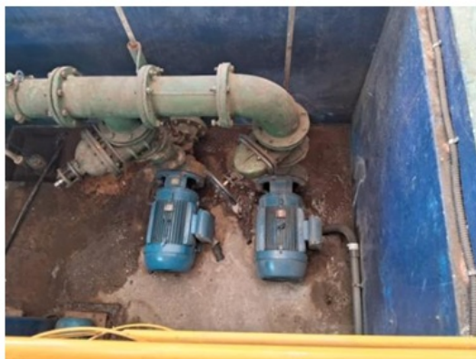
Figura 25: vista dos conjuntos motobombas e barrilete da elevatória de distribuição que trabalha afogada. Nota-se ausência de dispositivo de proteção, como válvula de retenção, vazamento e piso não impermeável.
