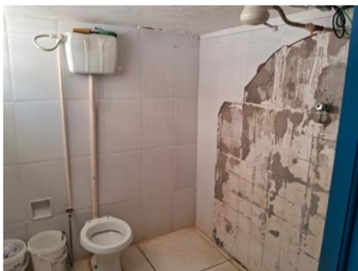
Figura 41: banheiro usado pelos funcionários em mal estado de conservação necessitando de reparos no revestimento e instalação de assento sanitário.
