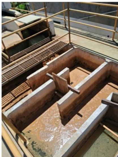
Foto 11: início da passagem da água pelo tanque de floculação.
