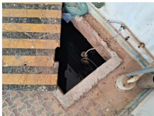
Figura 24: Vista da visita do tanque de contato e da bóia de nível automática.
