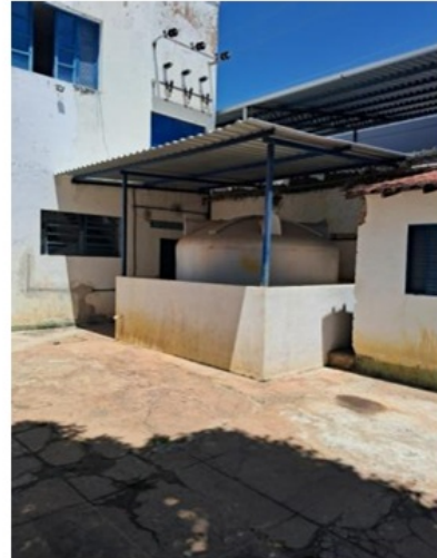
Figura 30: cisterna plástica usada para armazenamento do sulfato de alumínio instalada em tanque de contenção. A cisterna fica localizado no pátio interno onde há circulação de clientes para acesso à loja de atendimento.
