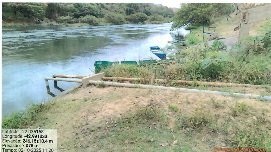
Foto 1: Ponto de captação (ausência de placa de identificação do manancial com indicação de uso da água para abastecimento humano e a proibição de banho) .
