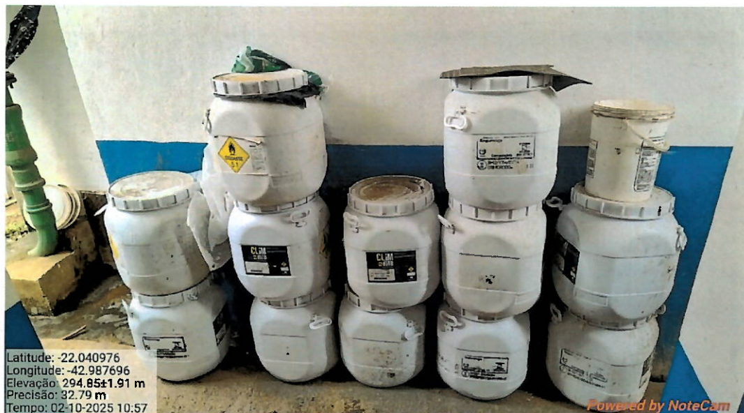
Foto 21: Armazenamento de hipoclorito de cálcio.
