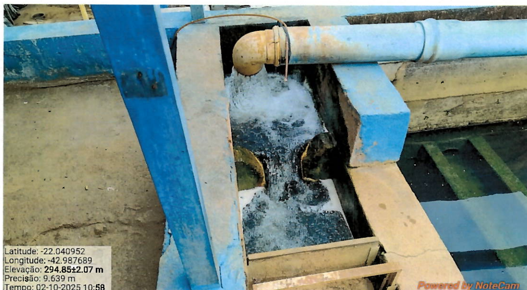
Foto 9: Entrada de água bruta na ETA.
