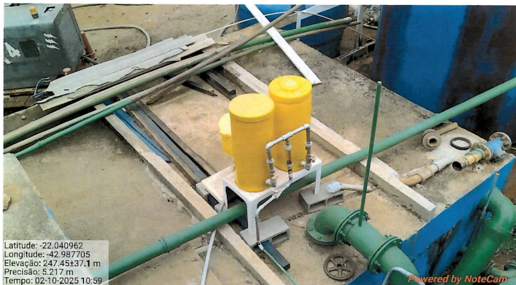
Foto 13: Sistema de cloração.
