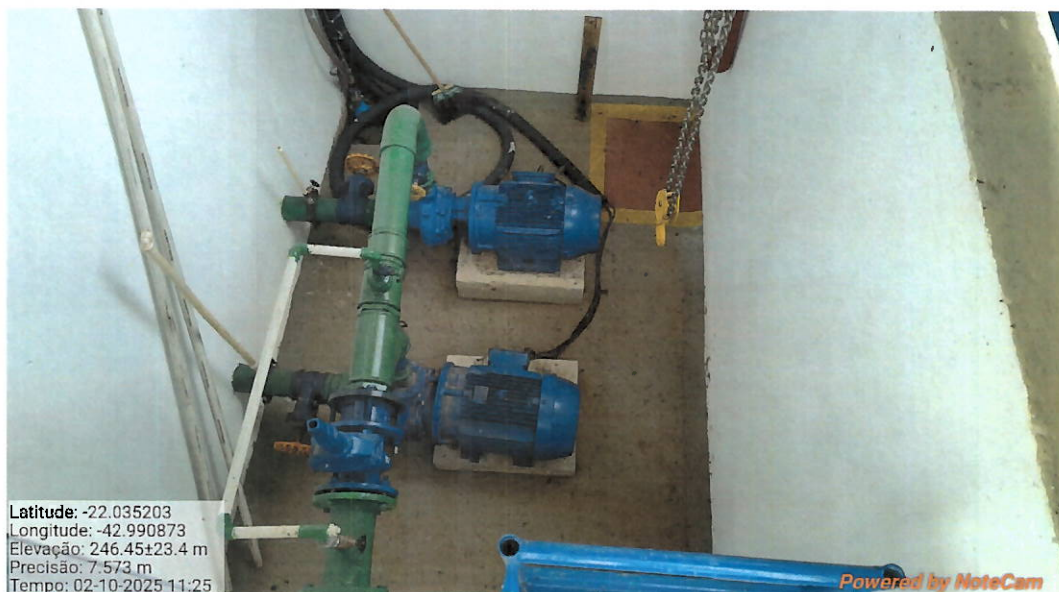
Foto 3: Bombas da unidade de captação (30 cv cada).
