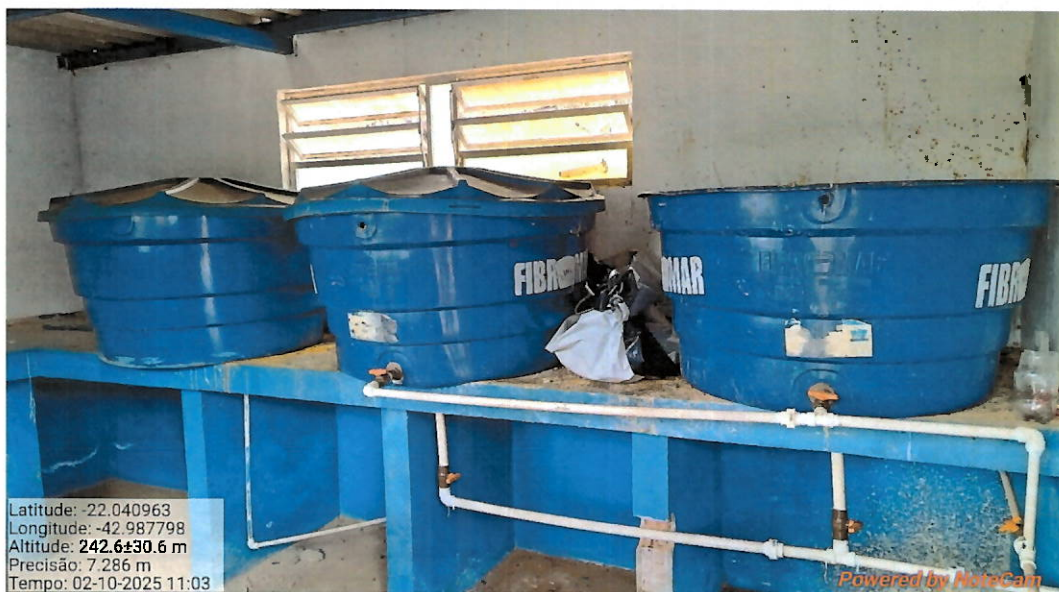
Foto 23: Armazenamento de sulfato de alumínio.
