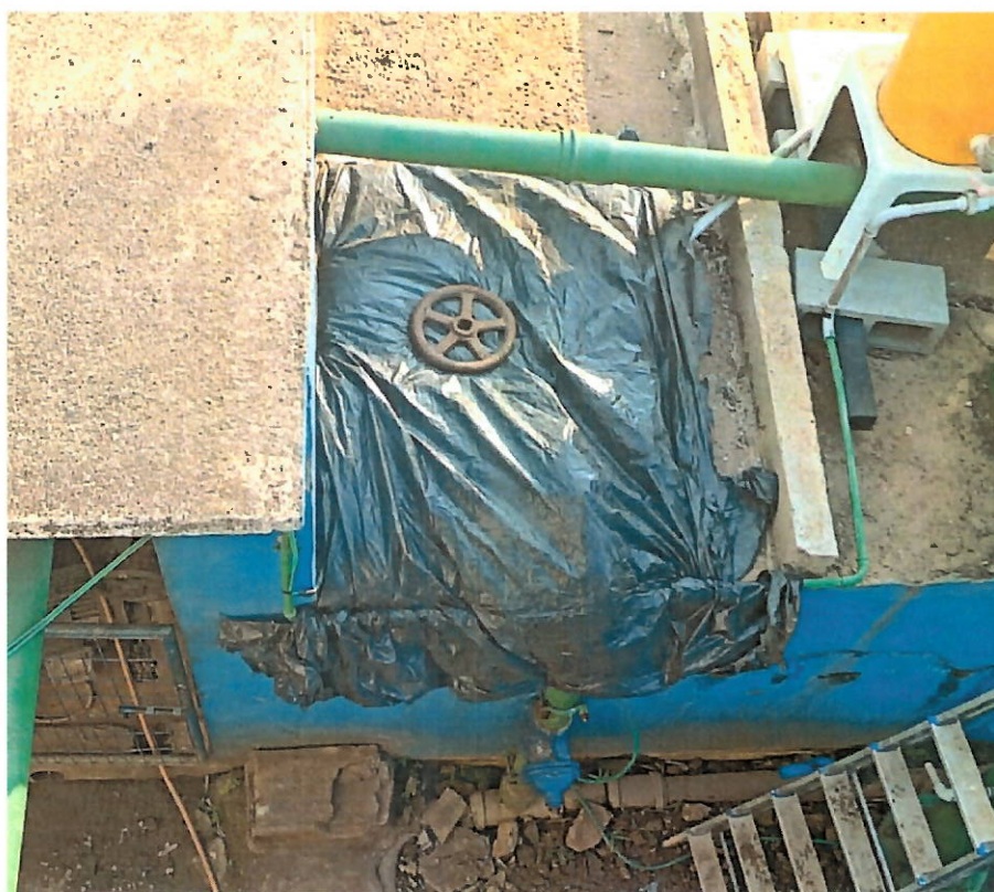
Foto 15: Adequação provisória realizada pela companhia.
