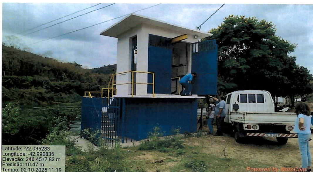
Foto 2: Estação Elevatória de Água Bruta (ausência de placa de identificação da unidade).
