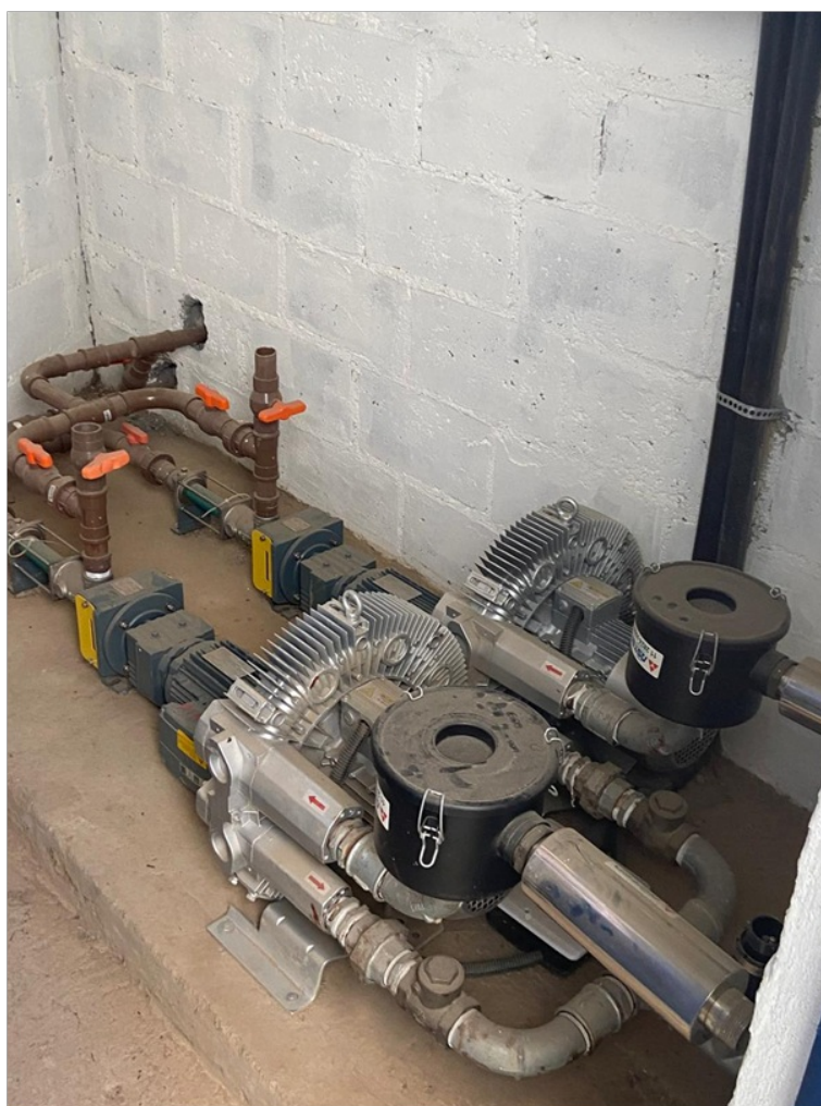
Sopradores e bomba de recirculação de lodo similares ao da ETE II.
