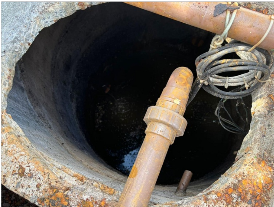
Elevatória da ETE responsável por bombear o esgoto bruto para a caixa de distribuição do sistema UASB.
