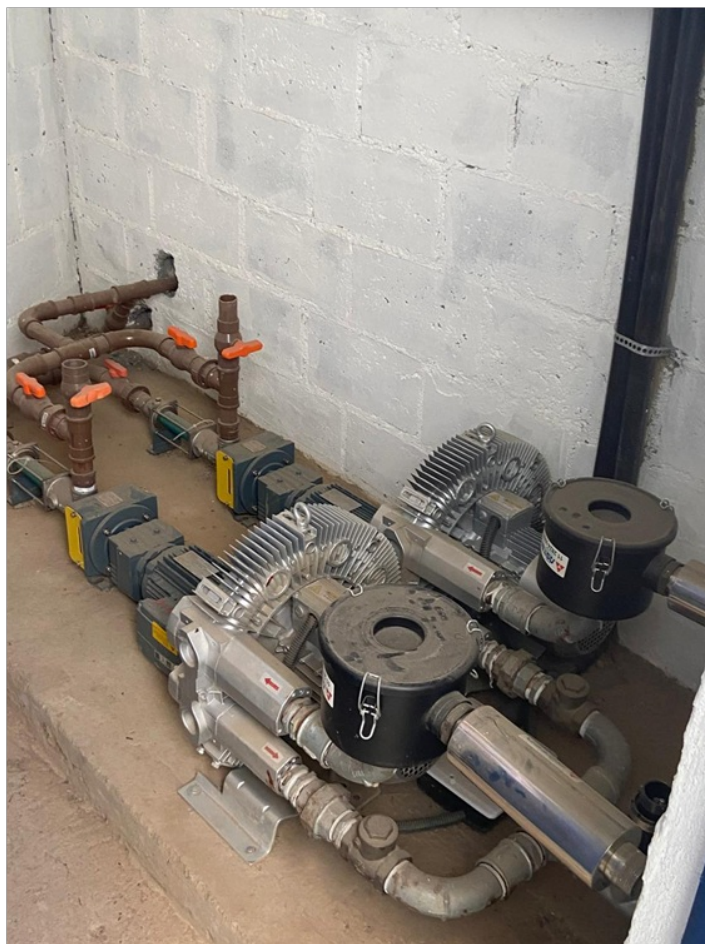
Sopradores e Bomba de recirculação de lodo.
