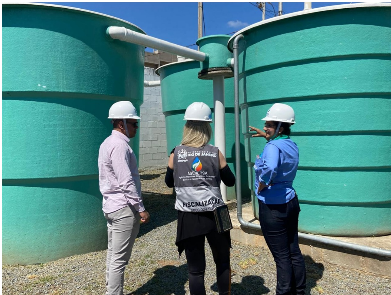
ETE composta por 2 (dois) Reatores UASB + 1(um) Biofiltro Aerado Submerso + 1 (um) Decantador secundário
