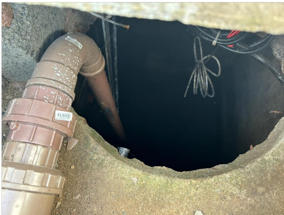
Elevatória de esgoto bruto da ETE.
