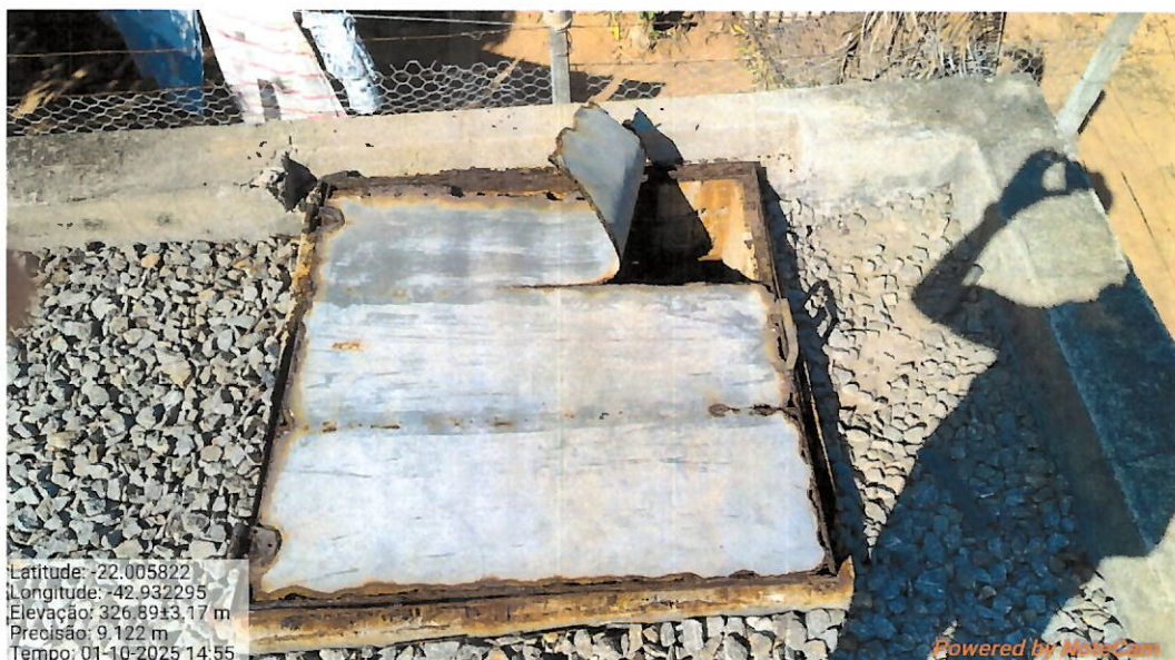
Foto 7 : Parte superior do reservatório – tampa de inspeção com sinais de corrosão (não apresenta estaqueidade).
