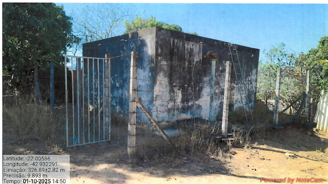
Foto 3: Vista lateral – portão de acesso ao reservatório. Nota-se a ausência de guarda-corpo na parte superior do reservatório e ausência de SPDA.
