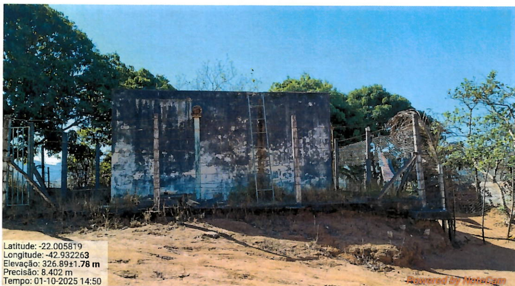
Foto 2: Vista frontal – ausência de cerceamento adequado (apenas arame farpado); ausência de identificação da unidade e escada inadequada.
