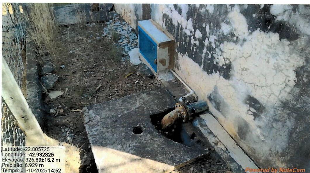
Foto 6: tubulação com sinais de corrosão.
