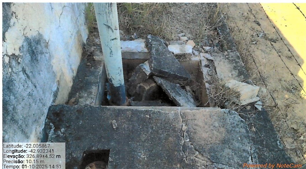
Foto 4 : estrutura de concreto danificada.
