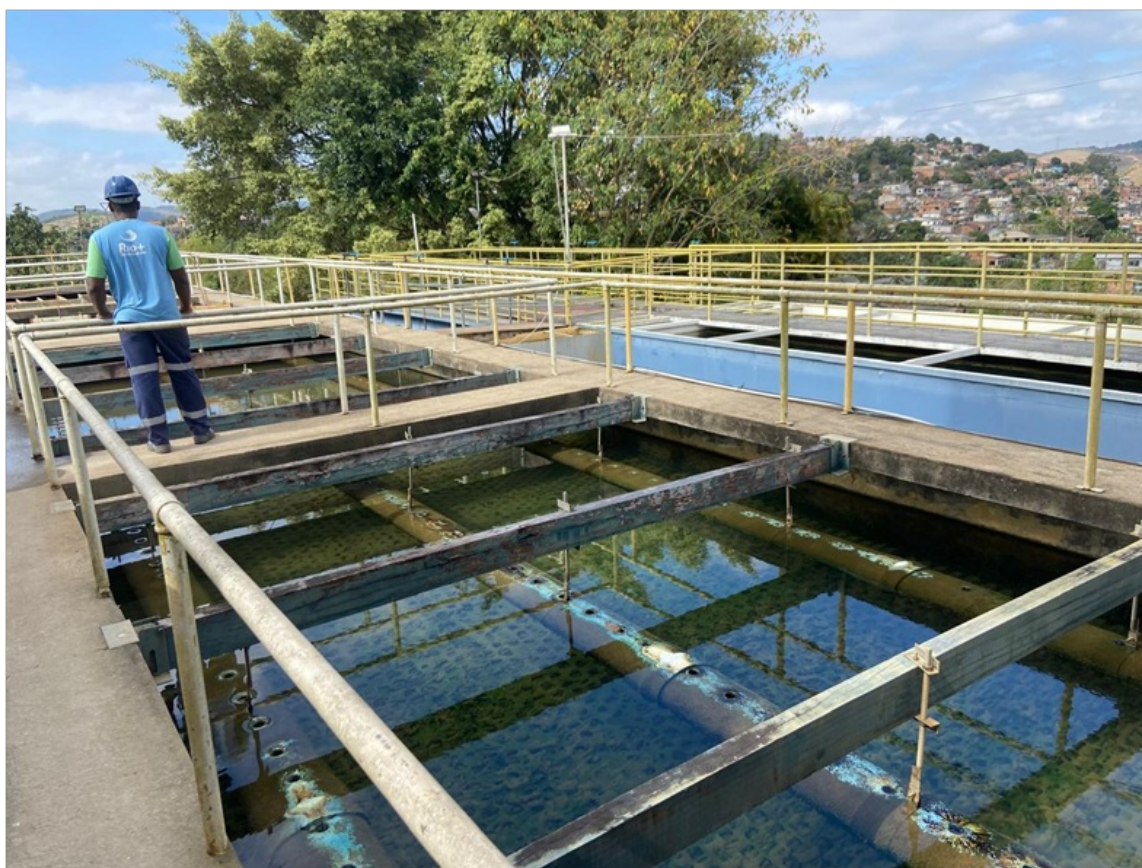
Foto 07 – Decantador lamelar de concreto armado.
