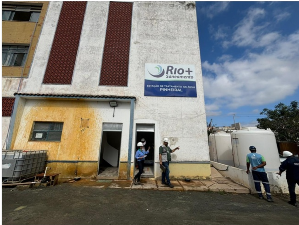
Foto 01 - Estação de Tratamento de Água Pinheiral, necessita de revitalização da pintura.
