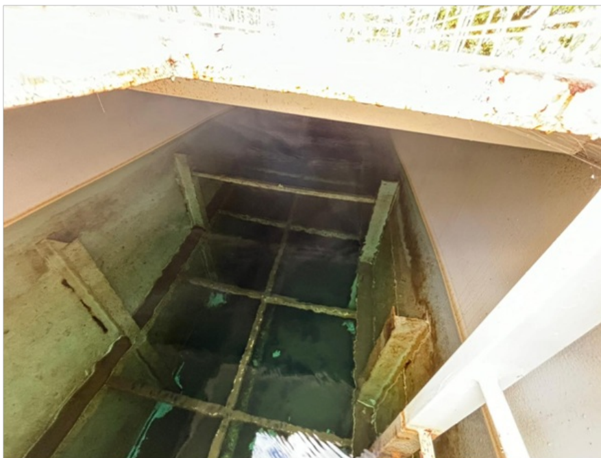
Foto 10 – Bateria de filtros do modulo metálico necessitando de substituição do leito filtrante
