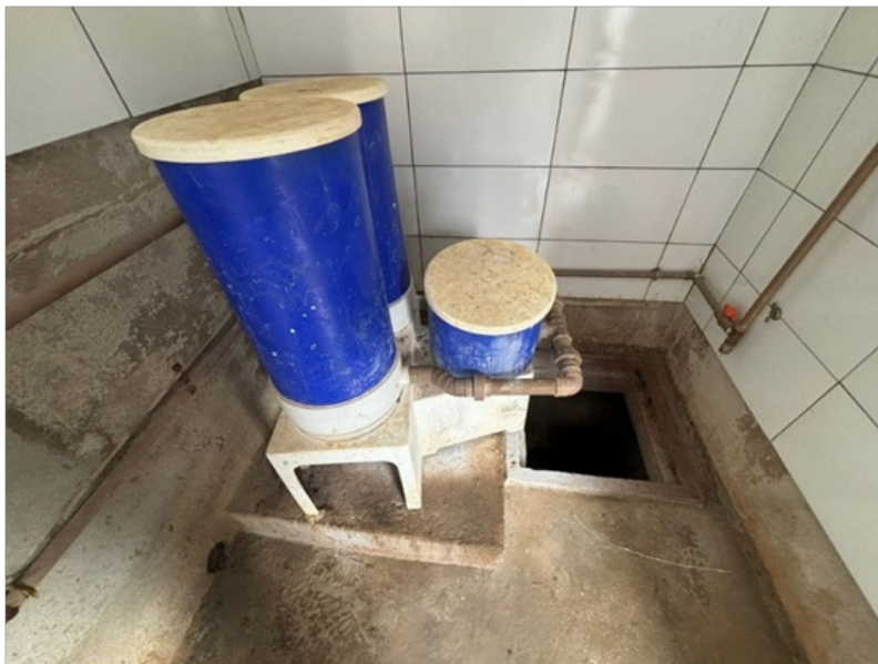
Foto 13 – Sistema de cloração – Hipoclorito de cálcio.
