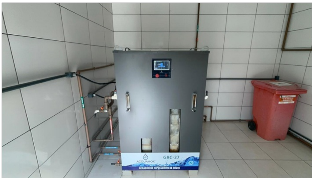
Foto 14 – Sistema de cloração – Gerador de Hipoclorito de sódio.
