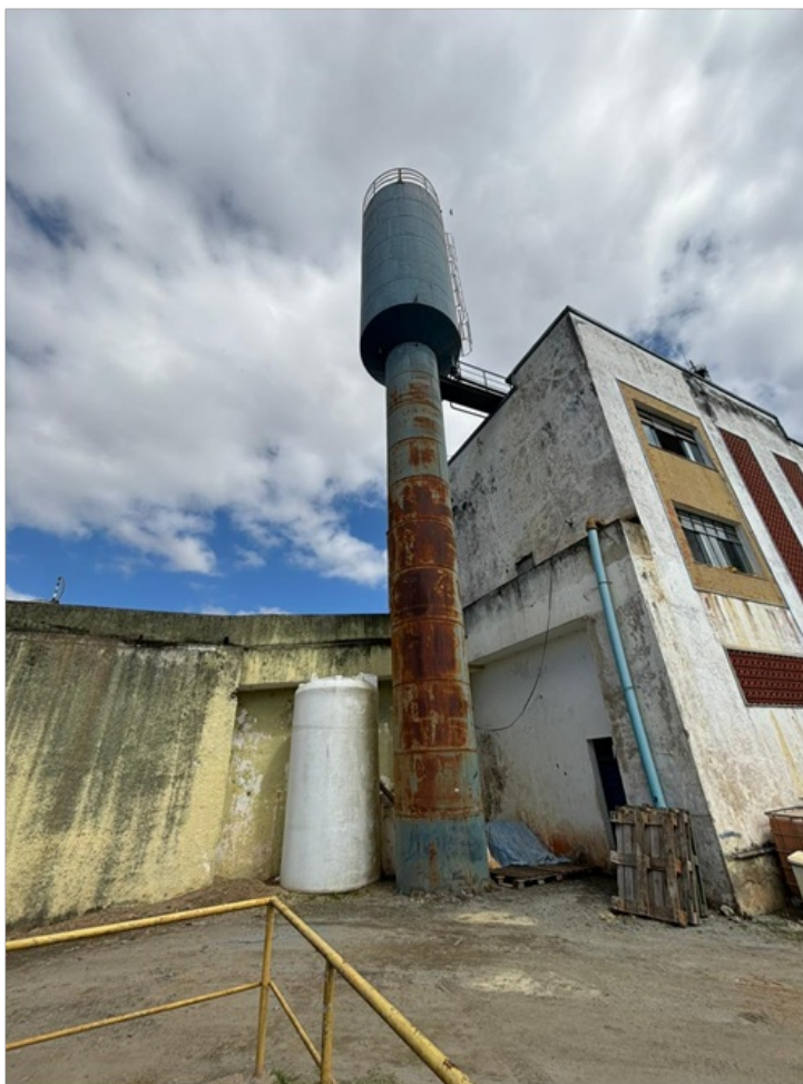
Foto 11- Reservatório elevado para lavagem dos filtros necessitando de reforma.
