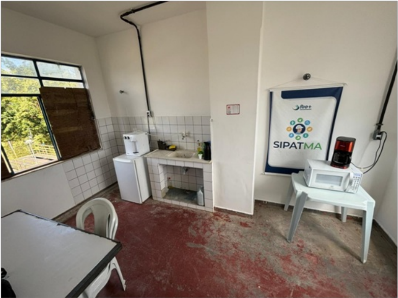
Foto 18 – janela com vedação improvisada na sala dos operadores.
