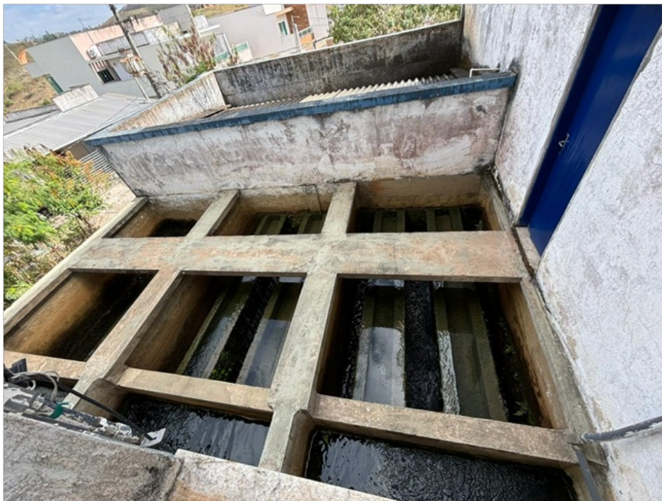
Foto 09 – Bateria de filtros da Unidade de concreto armado necessitando de substituição do leito filtrante e de guarda-corpo.
