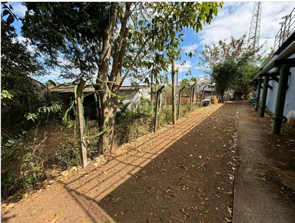
Foto 20 – Cercamento da ETA precisando de reforma.
