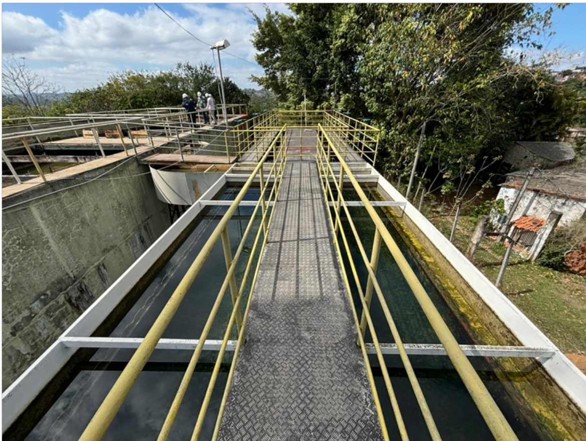
Foto 08– Decantador lamelar do Módulometálico.
