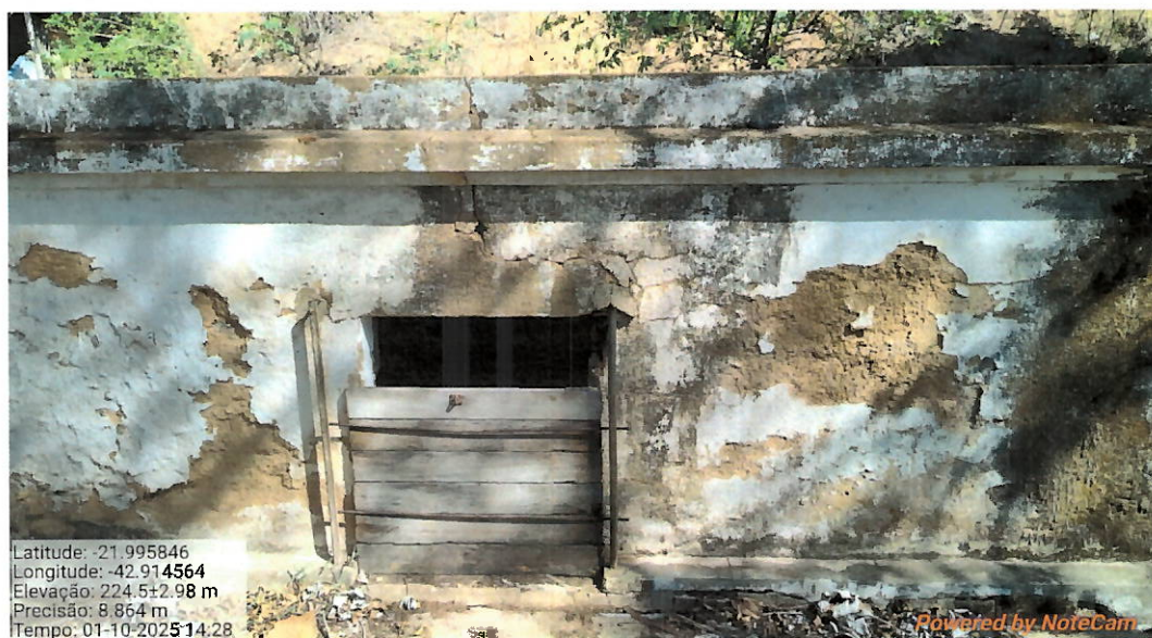
Foto 4 : Vista da janela de inspeção. Destaca-se a vedação inadequada, a tampa deteriorada.
