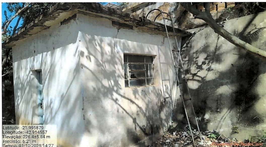
Foto 8: Vista do abrigo do barrilete das tubulações de saída e descarga. Destaca-se a presença de rachaduras e vidro quebrado.
