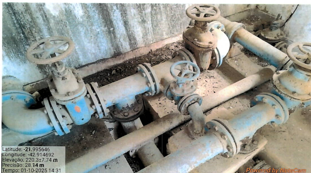
Foto 10: Vista do barrilete das tubulações de saída e descarga. Destaca-se a presença de áreas com corrosão e pintura deteriorada
