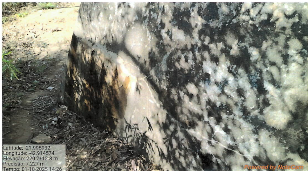
Foto 3: Trecho com vazamento aparente.
