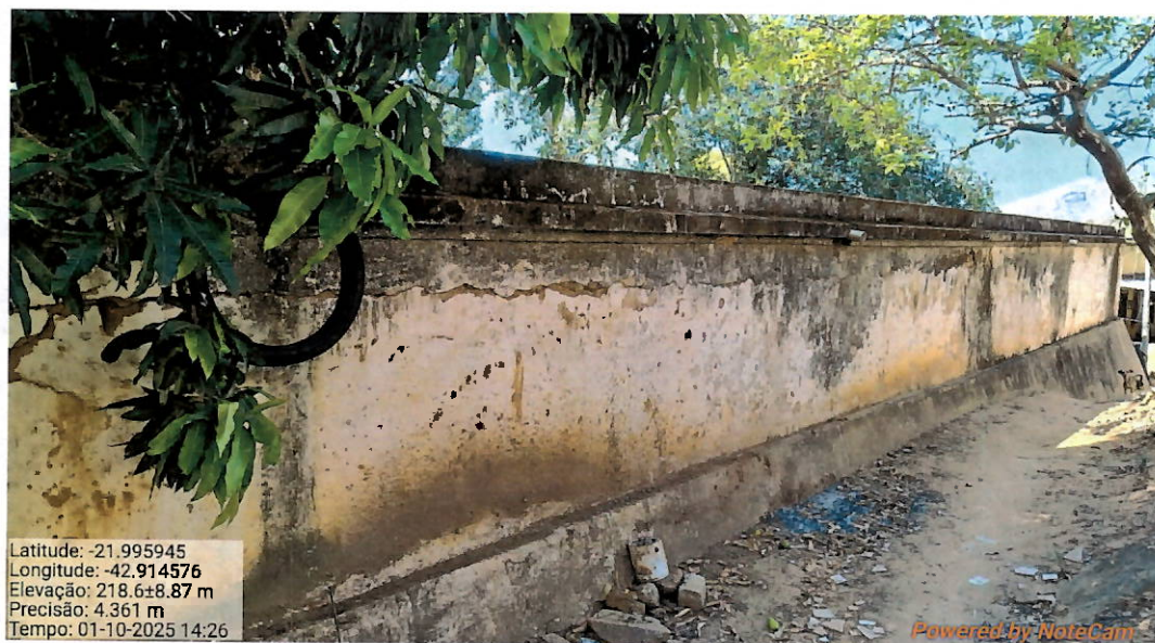
Foto 2: Vista da parede dos fundos do reservatório. Nota-se rachaduras, deterioração do revestimento.
