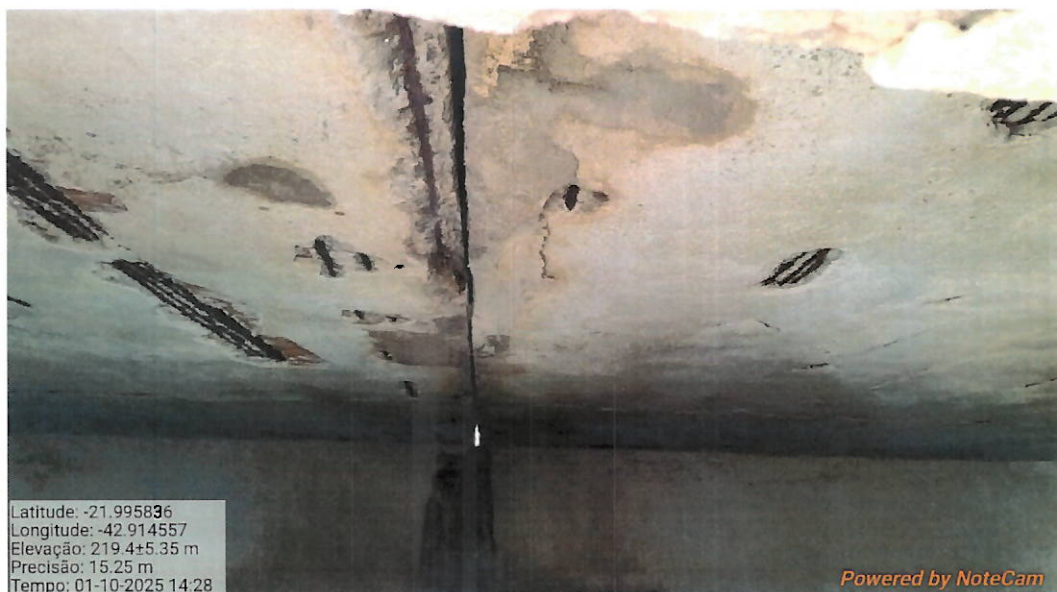
Foto 7 : Vista do interior do reservatório. Destaca-se a presença de fissura na laje ,que está permitindo a infiltração de água pluvial, e deterioração da armadura da laje.
