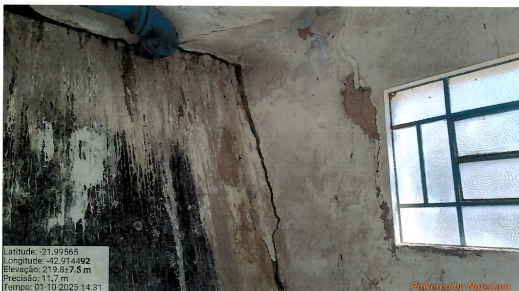
Foto 9: Vista do interior do abrigo do barrilete. Destaca-se a presença de rachaduras.
