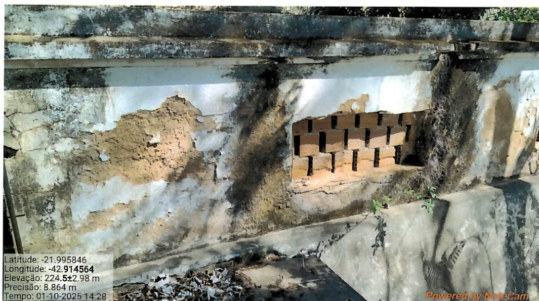
Foto 5: Vista dos dispositivos de ventilação. Destaca-se a ausência de telas e o acabamento inadequado.
