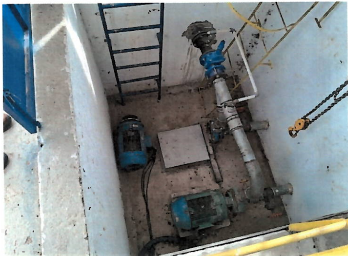
Foto 21: Interior da Casa de Bombas da captação.
