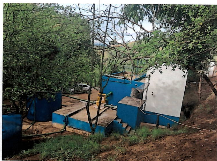
Foto 4: Vista geral da estação com o tanque de contato ao centro.
