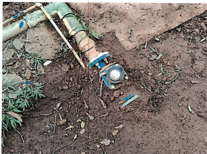
Foto 18: Macromedidor 2 em uma das linhas de distribuição.
