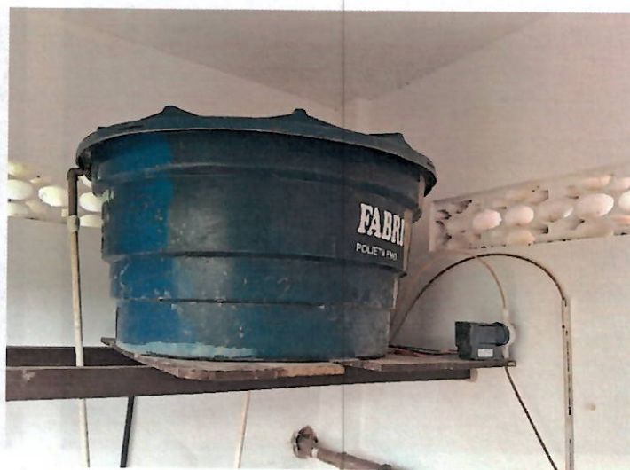
Foto 12: Interior da casa de química, reservatório de sulfato de alumínio. Nota-se ausência de bacia de contenção para produtos químicos.
