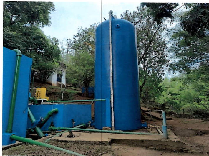
Foto 10: Reservatório principal de água tratada.
