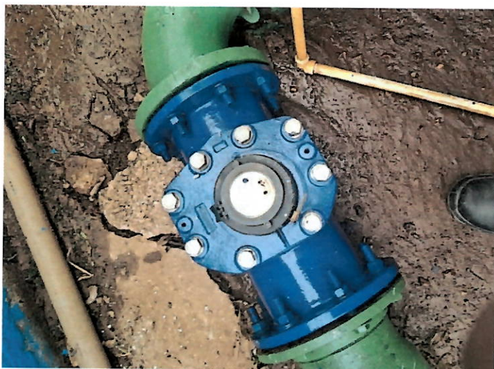
Foto 17: Macromedidor 1 em uma das linhas de distribuição.
