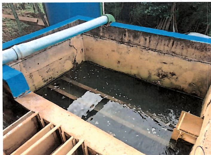
Foto 8: Filtro da ETA.
