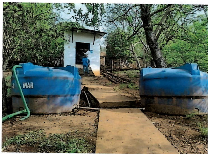
Foto 11: Reservatório complementares e casa de química ao fundo.
