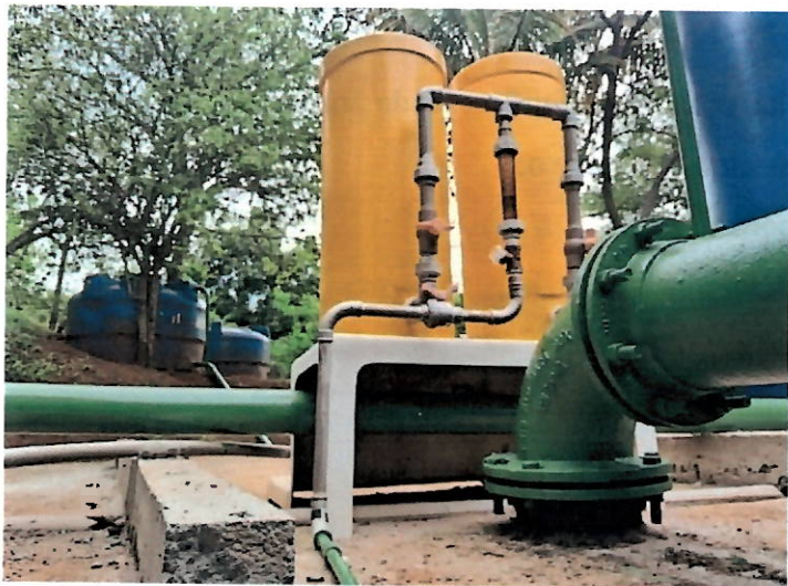
Foto 25: Vista do rotâmetro do dispositivo da desinfecção.
