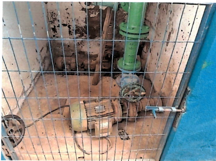
Foto 26: Casa de bombas usadas na retrolavagem dos filtros. Não há equipamento reserva.
