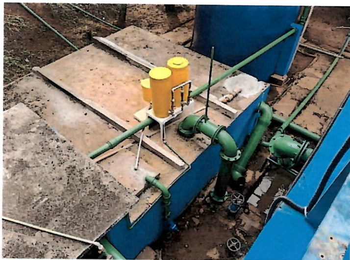
Foto 9: Vista superior do tanque de contato.
