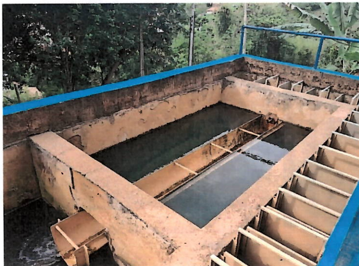
Foto 5: Vista superior do tanque onde ocorrem os processos de tratamento.
