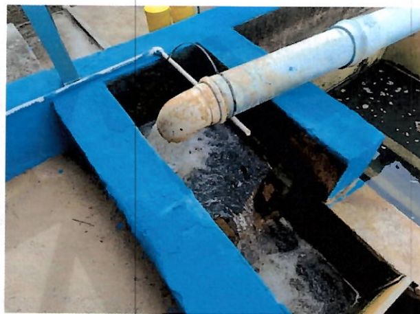
Foto 2: Entrada da água nos tanques de tratamento.
