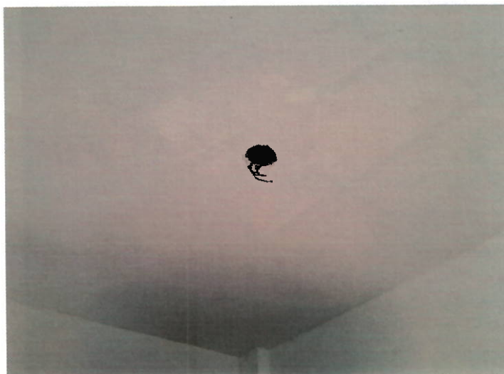
Foto 14: Ausência de instalação de luminária.
