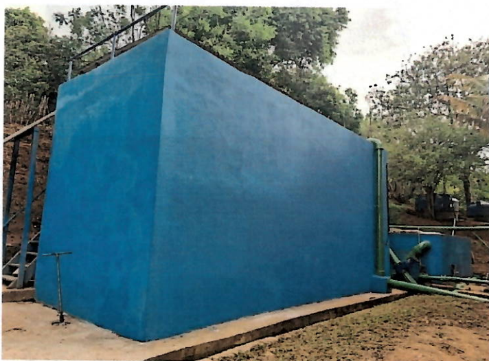
Foto 3: Vista do tanque onde ocorrem os processos de tratamento.
