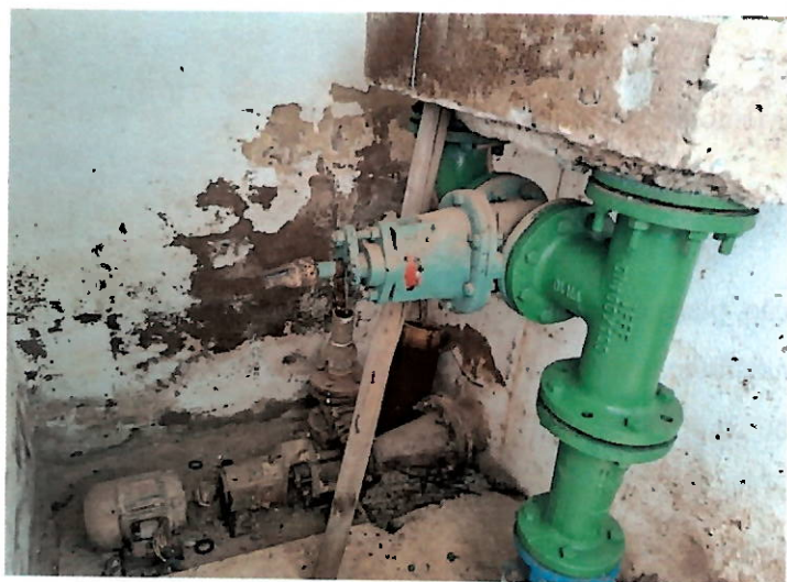
Foto 27: Barrilete da elevatória de retrolavagem. Nota-se apoio improvisado com caibro de madeira, necessidade de manutenção civil e retirada de bens inservíveis.
