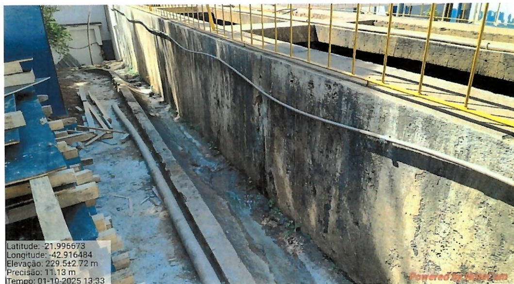
Foto 11: Lateral do tanque de floculação com infiltração.
