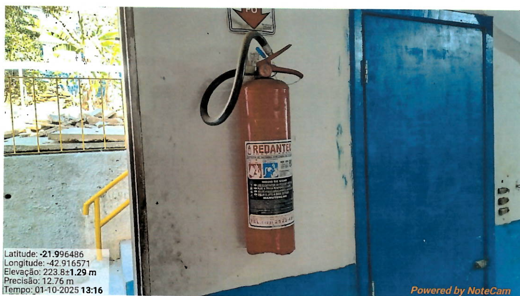
Foto 5: Extintor de incêndio
