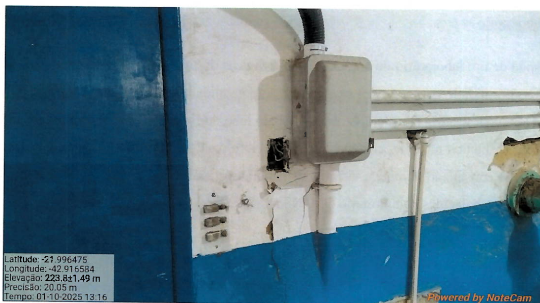
Foto 16: Necessidade de adequação elétrica (fiação exposta)..
