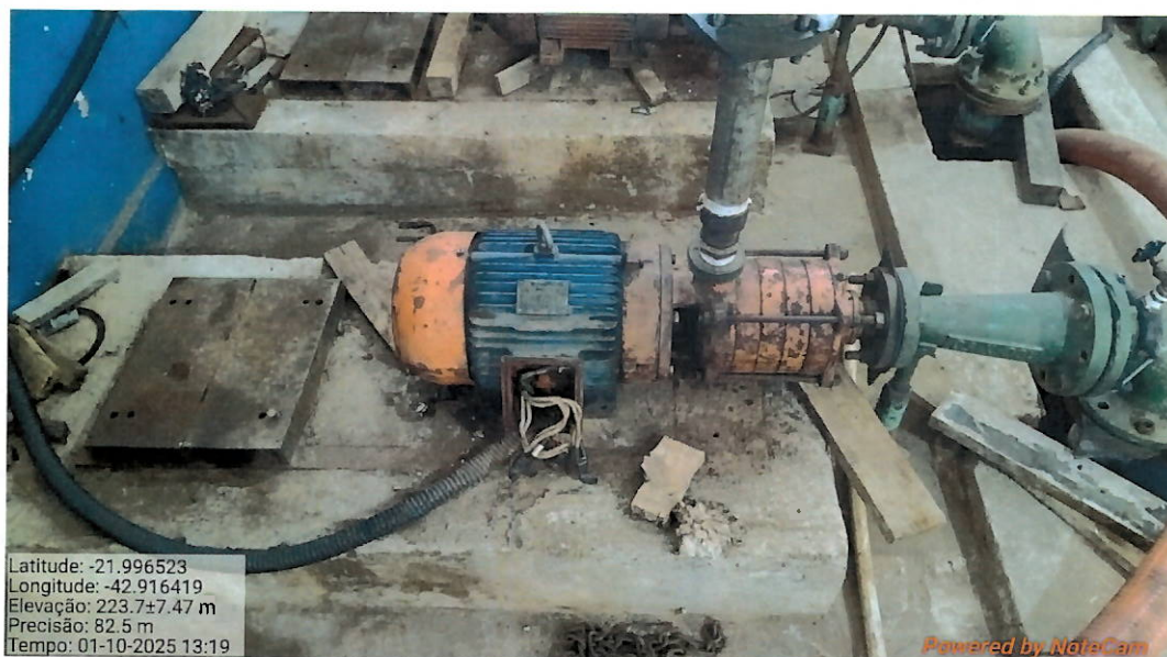
Foto 15: Necessidade de adequação elétrica (fiação exposta).
