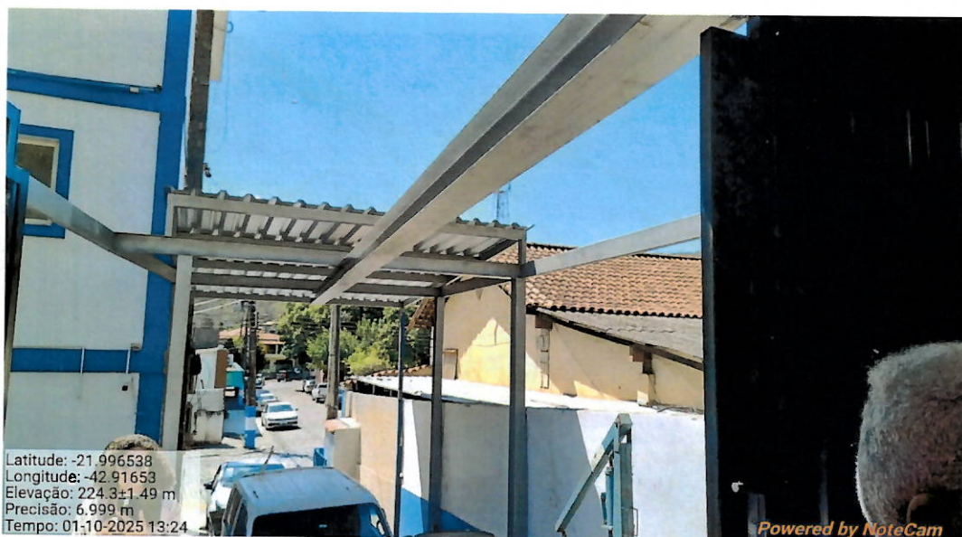
Foto 30: Monovia instalado para transporte de equipamentos.
