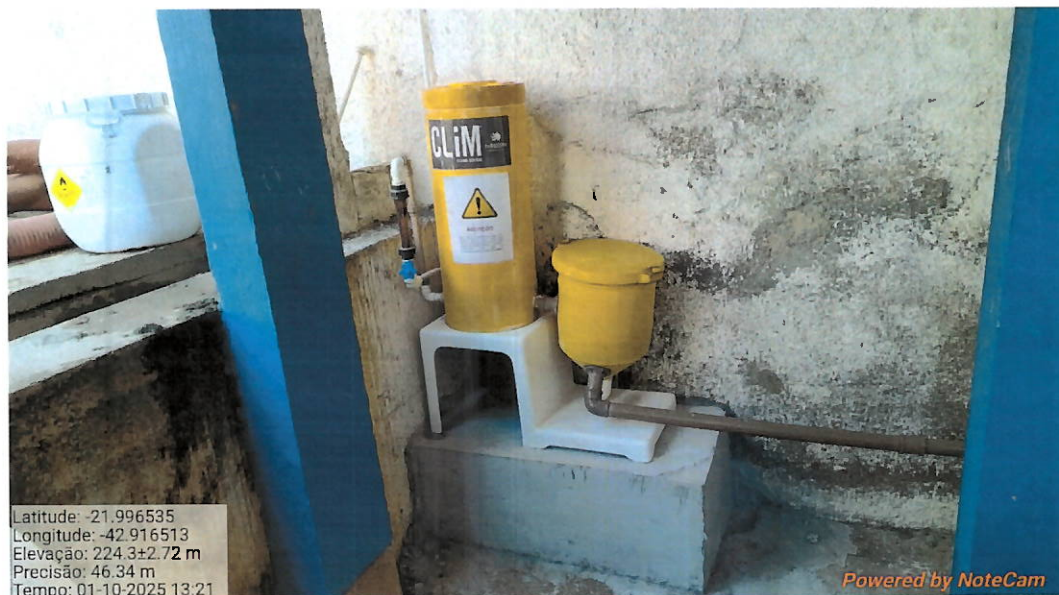
Foto 10: Sistema de cloração.
