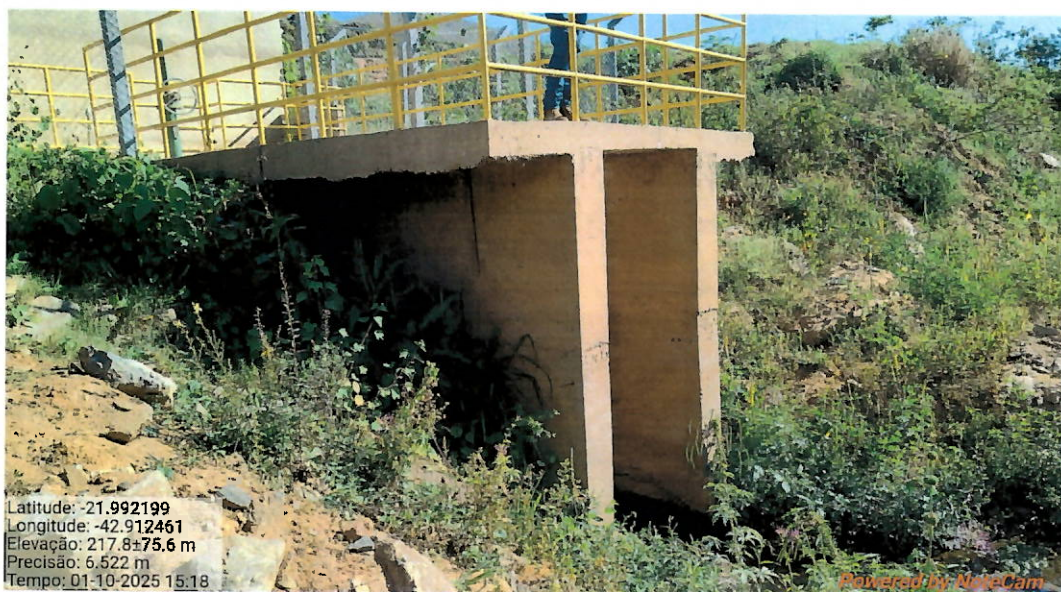
Foto 2: Ponto de captação.
