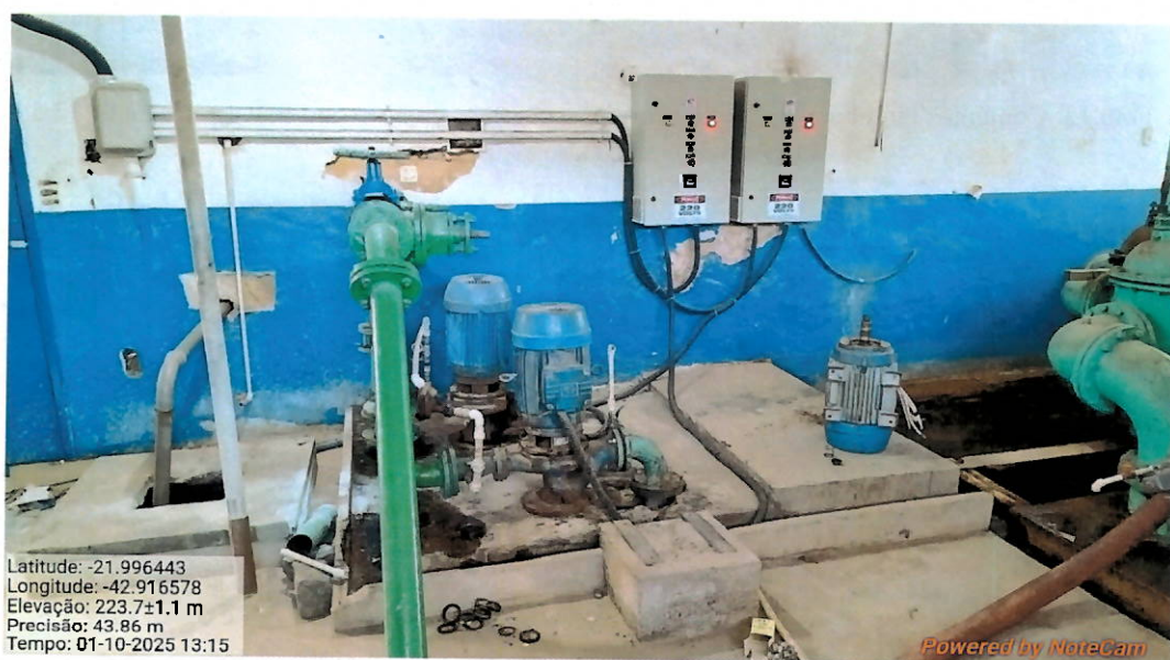
Foto 12: Conjuntos motobombas da elevatória que abastece os bairros do centro e adjacências (potência de 20 cv cada).
