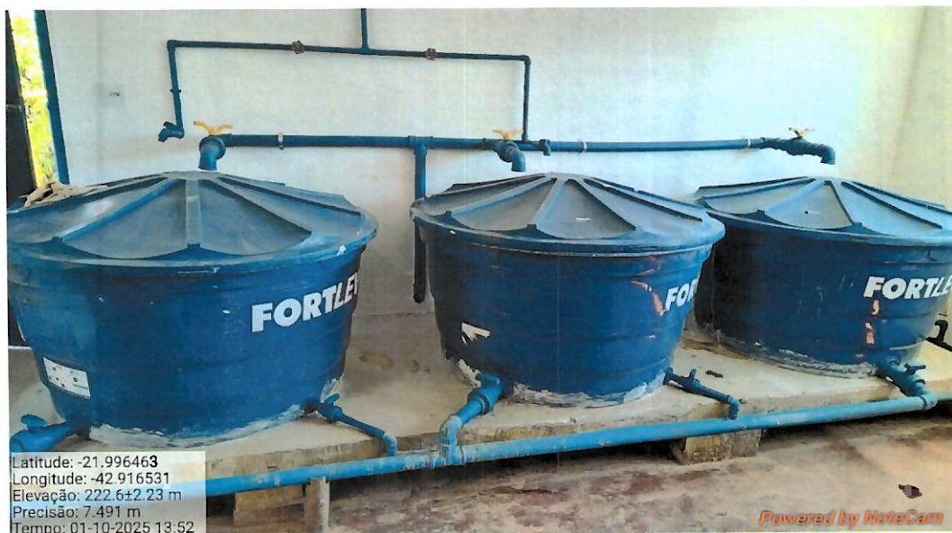
Foto 24: Armazenamento de sulfato de alumínio (ausência de bacia de contenção).
