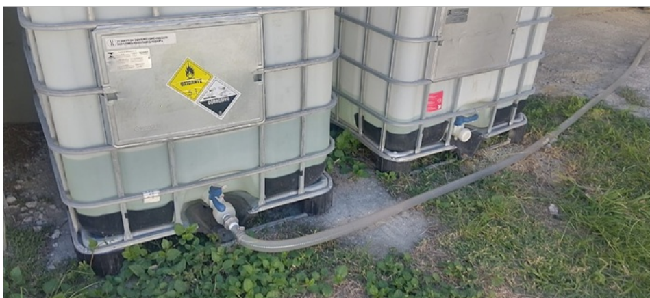
Foto 13 – Reservatório de Hipoclorito, sem baia de contenção, utilizado para desinfecção do efluente tratado.
