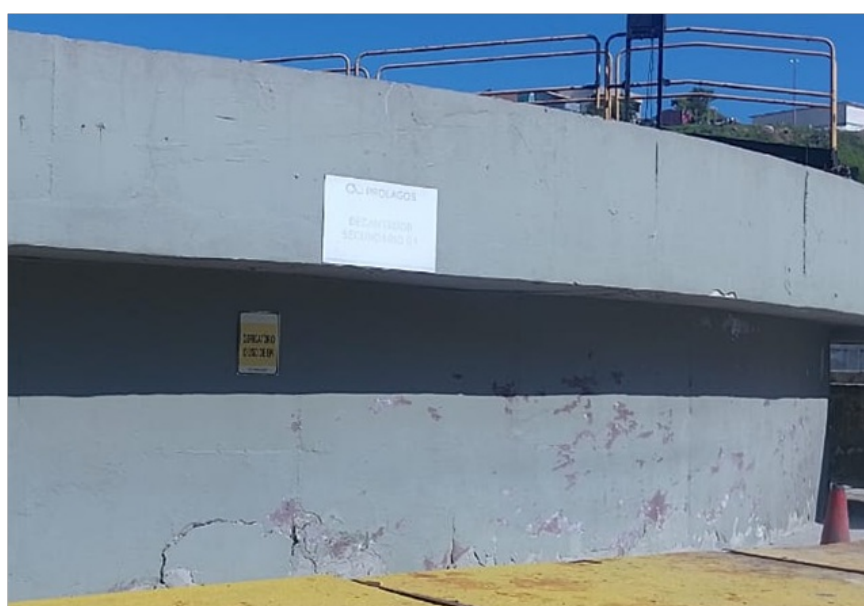
Foto 10– Decantador necessitando de tratamento de fissuras. Guarda-corpo da passarela do raspador está muito oxidado, sendo necessária sua substituição, ou reparo.
