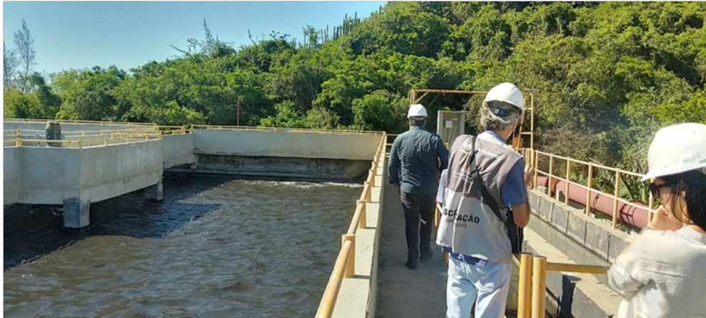
Foto 8 – Aeradores submersos ( três), funcionando como misturadores (ou seletores de microorganismos formadores de flocos), mantendo o lodo em suspensão. Provavelmente também, para não produzir aerossóis, que aumentem odores impactantes para a comunidade do entorno.
