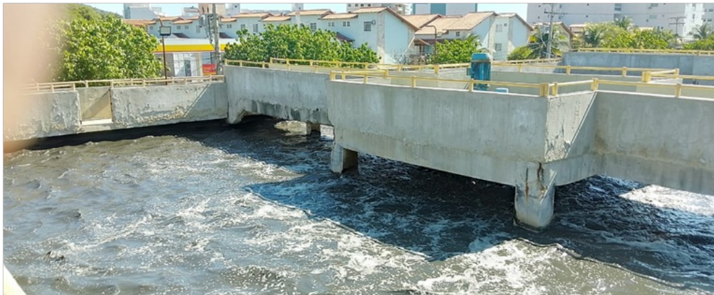
Foto 7 – Reator aeróbio (lodo ativado). Só um aerador de superfície estava funcionando como projetado, ou seja, transferindo o oxigênio do ar no impacto das pás com a superfície do esgoto.
