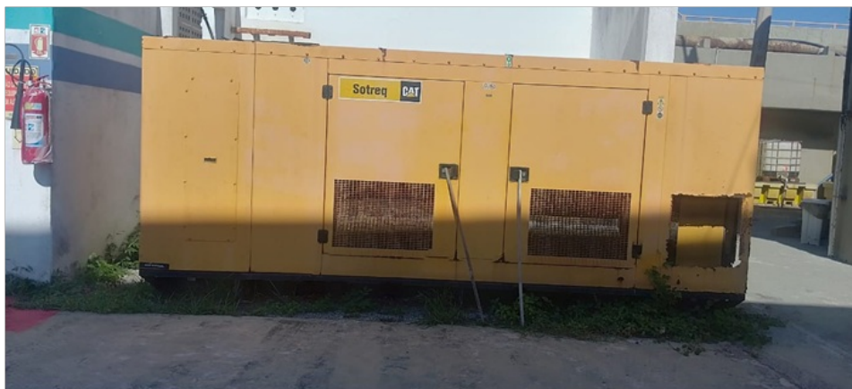
Foto 5 - Gerador para segurança operacional ( sem bacia de contenção)
