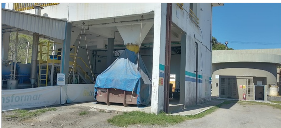
Foto 14 – Caçamba para depósito do lodo. Devido a manutenção da centrífuga o lodo está com muita umidade. Seu destino é aterro sanitário.
