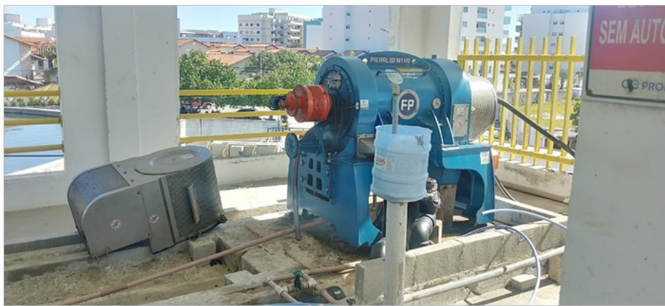
Foto 12 – Centrifuga parada para manutenção
