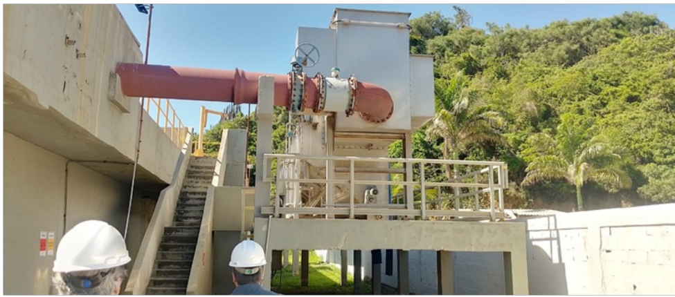
Foto 6 – Módulo de tratamento preliminar ( gradeamento e desarenador)
