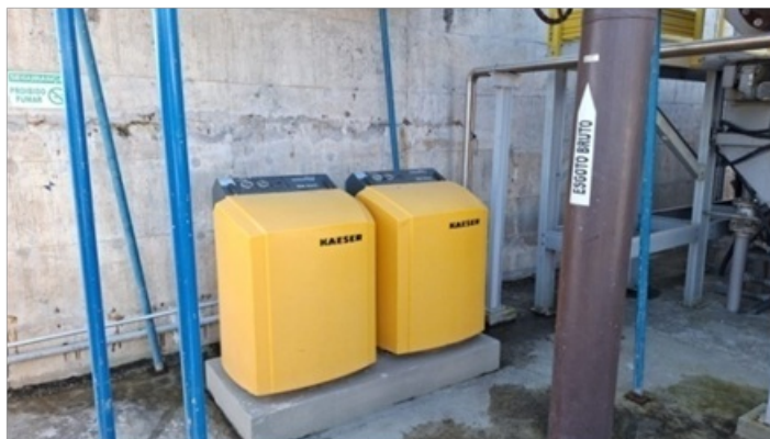
Foto 11 – Sopradores de ar.
