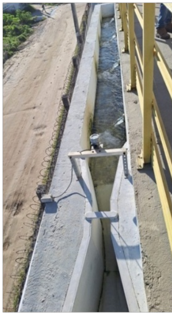
Foto 14 – Calha de coleta do esgoto tratado, com medição na calha Parchall.
