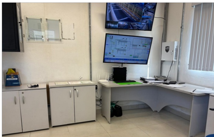
Foto 5 – Sala de controle operacional.
