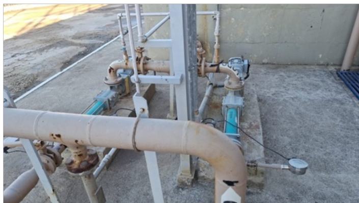
Foto 19 – Elevatória de lodo homogeneizado com adição de polímero para coagulação.
