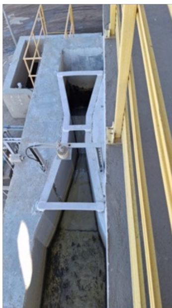
Foto 9 – Sistema de medição com Calha Parchall com sensor de vazão.
