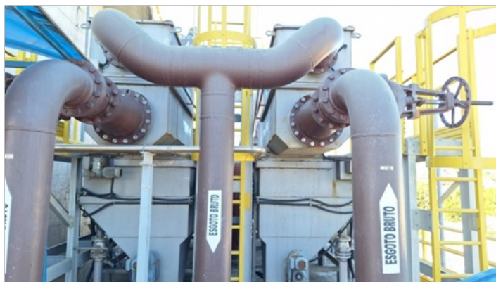
Foto 7 – Entrada do esgoto bruto no tratamento preliminar.
