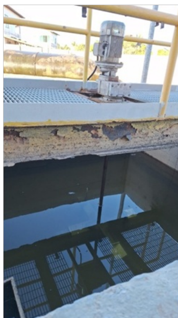
Foto 18 –Tanque de lodo com agitador .
