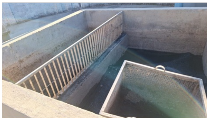
Foto 6 – Tanque de recebimento de carros limpa-fossa com cesto.
