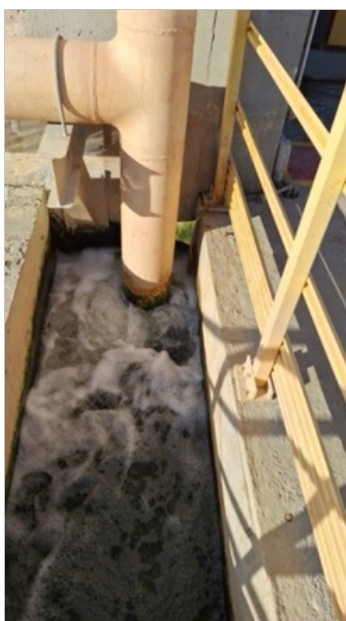
Foto 12 – Dosagem de PAC na saída do reator
