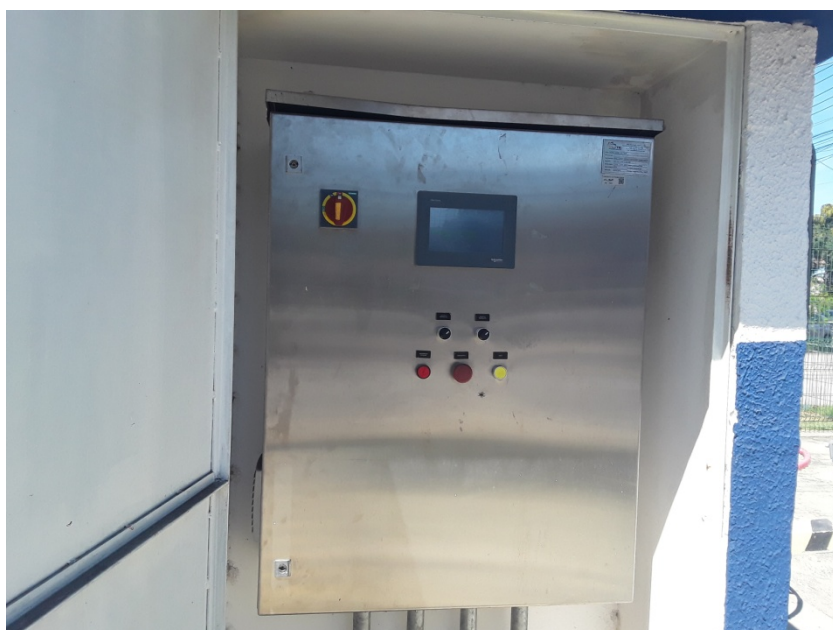
Foto 14 – Painel elétrico dos gradeamentos
