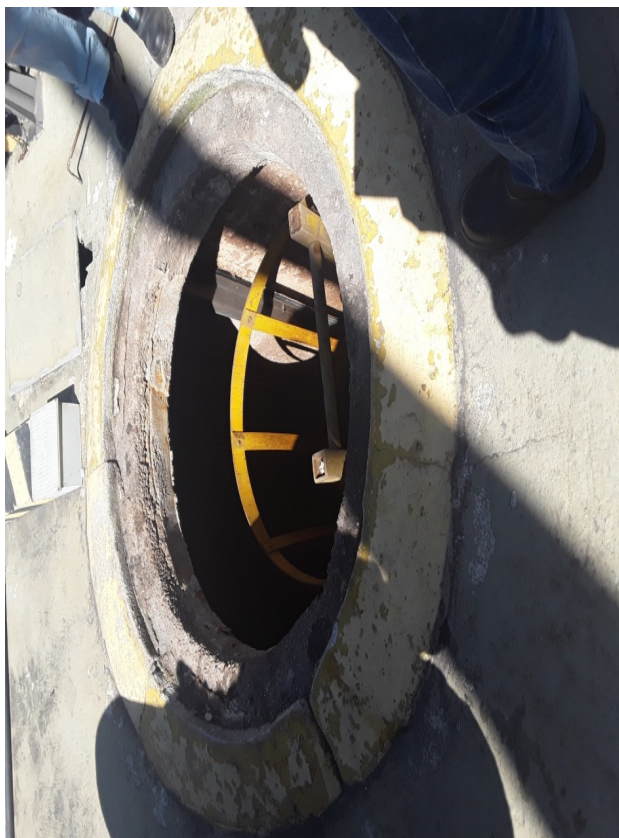
Foto 16 – Poço de sucção com proteção na escada
