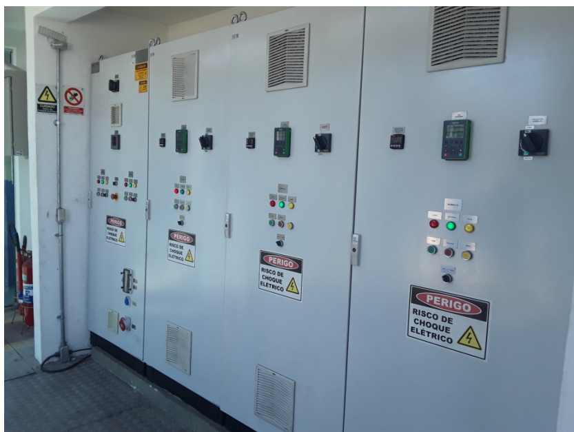
Foto 18 – Painéis de controle das motobombas com sinalização de advertência
