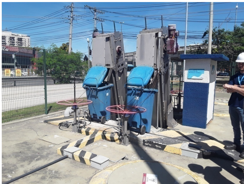
Foto 11 – Caçambas e válvulas de fechamento à jusante
