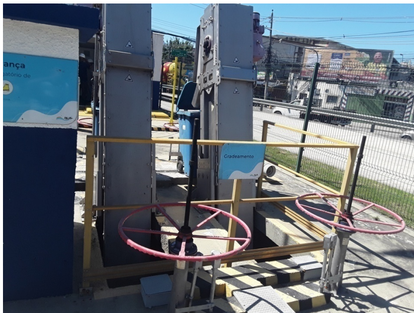
Foto 9 – Gradeamentos mecânicos com válvulas de fechamento à montante
