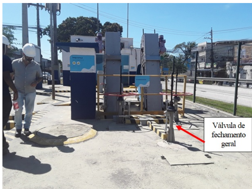
Foto 10 – Válvula de fechamento geral
