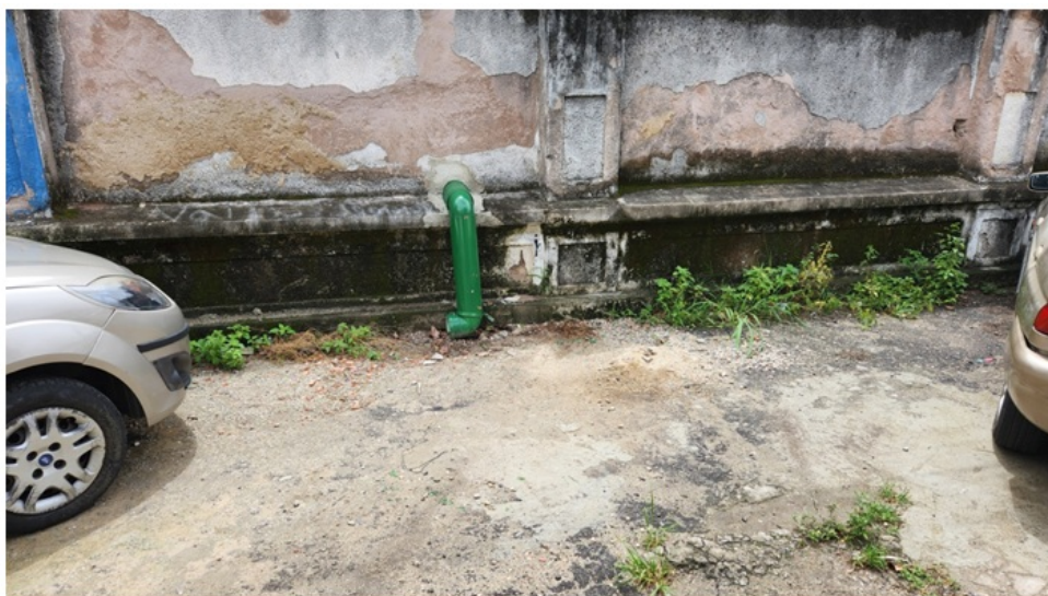
Foto 7 – Tubos de direcionamento de captação de água pluvial
