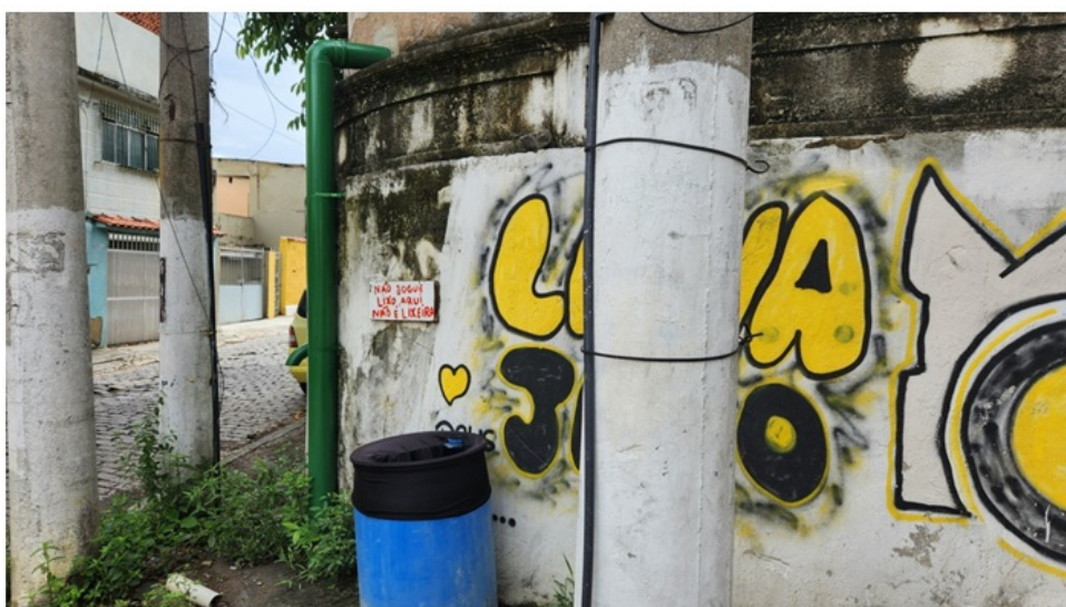
Foto 8 - Tubos de direcionamento de captação de água pluvial
