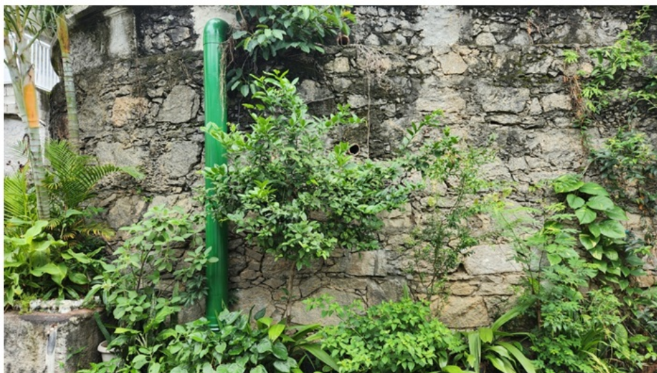
Foto 6 – Tubos de direcionamento de captação de água pluvial
