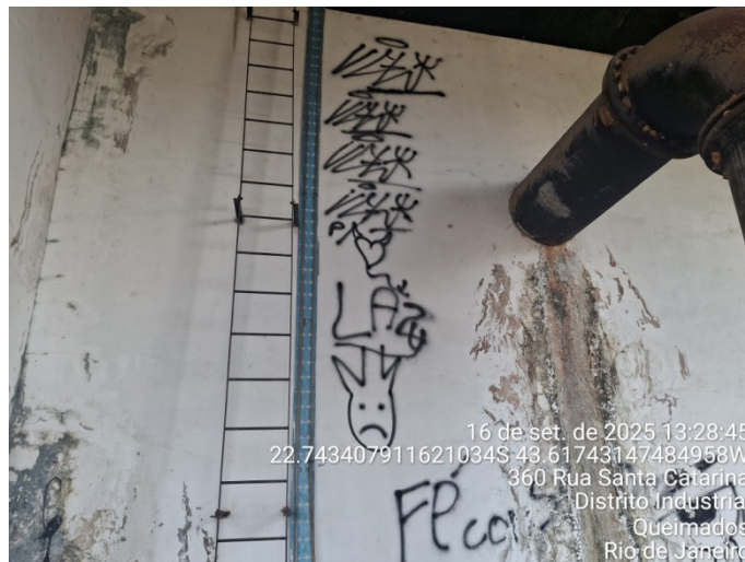
Foto13: Pixação dentro do abrigo do barrilete
