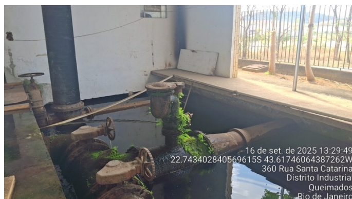
Foto 6: Tubulação de distribuição
