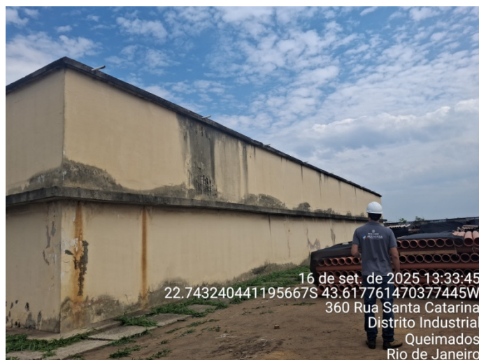
Fot 15: Paredes do reservatório com infiltração e armadura exposta
