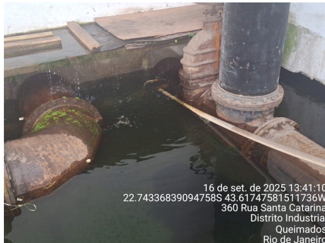
Foto10: Vazamento no reservatório
