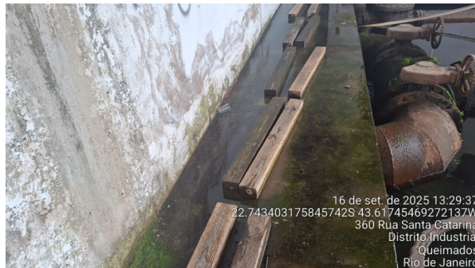
Foto 9: Vazamento no reservatório
