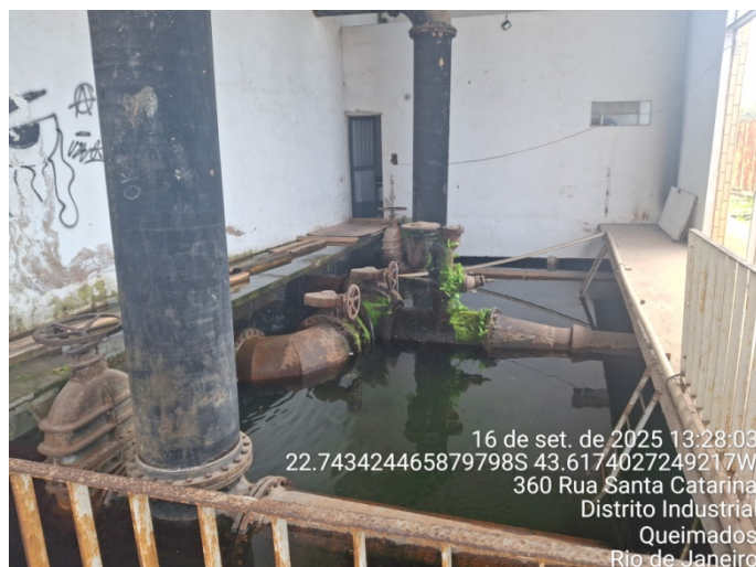
Foto 5: Barrilete do reservatório
