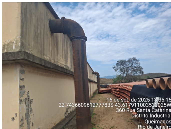
Foto 4: Tubulações de chegada
